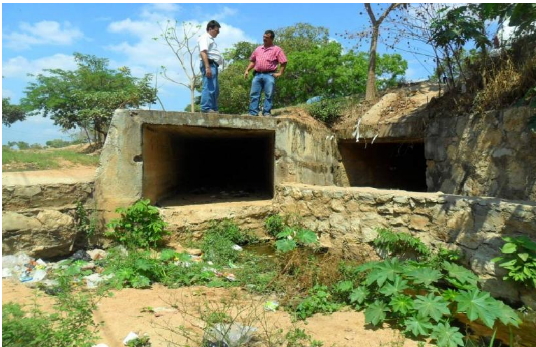
Foto 6.12 Localidad: Cintalapa. Obra de alcantarillado, que en época de grandes avenidas no funciona adecuadamente debido a sus características hidráulicas, además de encontrarse llena de escombros, provocando el desborde y daños a la población.
