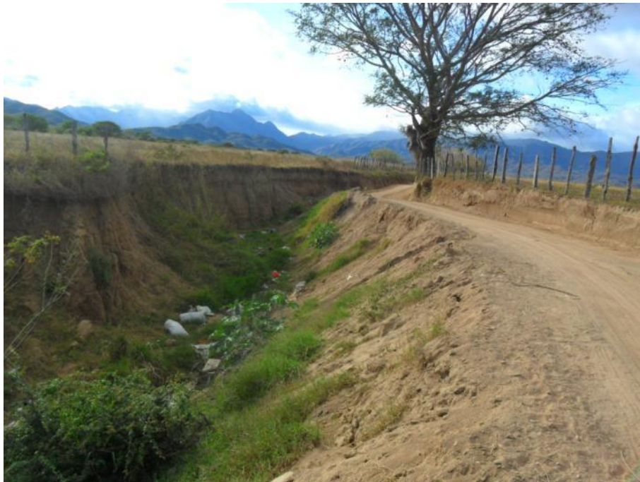
Foto 6.42 Localidad: Santiago. La comunidad repara los accesos ya que queda incomunicada, observando también la erosión que sufre el camino.
