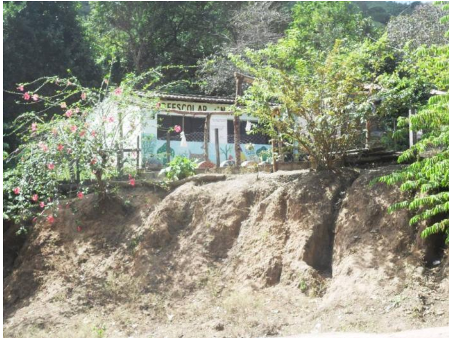
Foto 6.84 Localidad: Estoracón. Erosión hídrica amenaza instalaciones de escuela preescolar.
