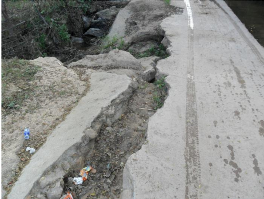
Foto 6.25 Localidad: 14 de Febrero. El acceso esta deteriorado, se observa la erosión que presenta el camino, que impide el paso de camiones pesados.
