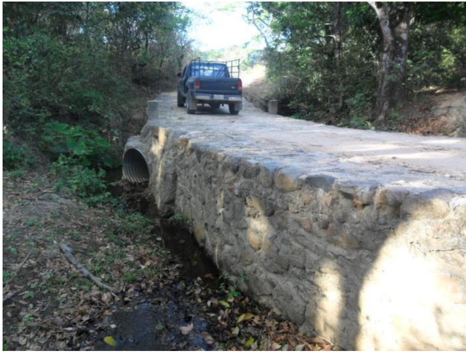
Foto 6.48 Localidad: Corazón del Valle. Debido a que solo existe una alcantarilla, es insuficiente para desalojar las aguas y en época de lluvias los escurrimientos dejan incomunicado a la población.
