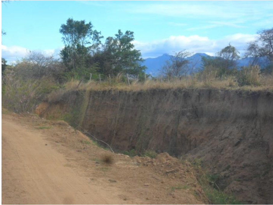
Foto 6.41 Localidad: Santiago. Los taludes se derrumban debido a la erosión provocada en temporada de lluvias.
