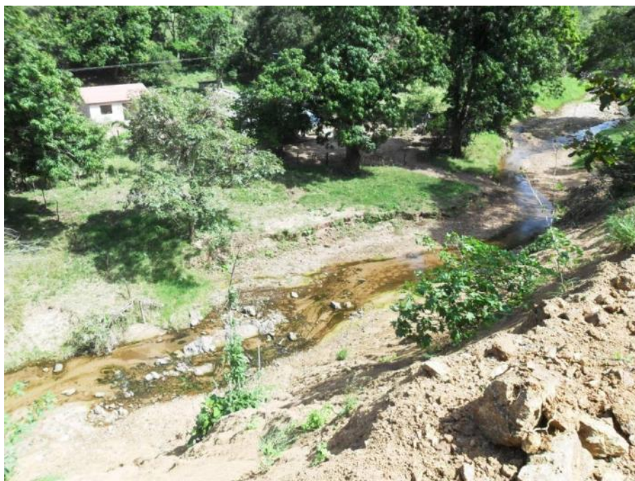
Foto 6.85 Localidad: Estoracón. Derrumbe que amenaza obstruir y desviar el río hacia una vivienda.
