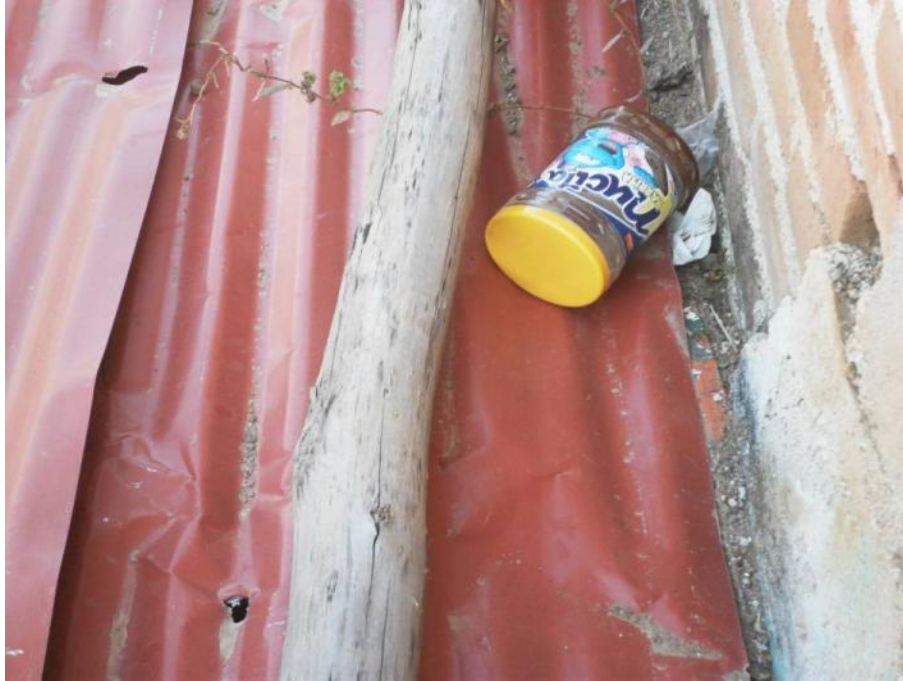
Foto 6.68 Localidad: San Luis. Láminas de una vivienda desprendidas por el viento.
