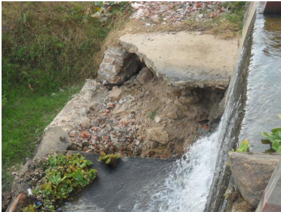
Foto 6.34 Localidad: Nueva Libertad. El caudal que se presenta en temporada de lluvias supera la capacidad del vado y se desborda por encima del camino obstruyendo el paso, siendo el único acceso para llegar a esta localidad.
