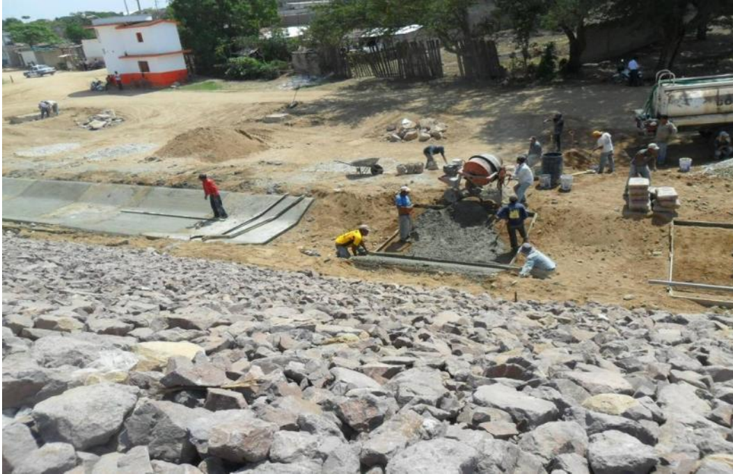
Foto 6.9 Localidad: Cintalapa. Construcción de la cuneta sobre la lateral del bordo de protección.
