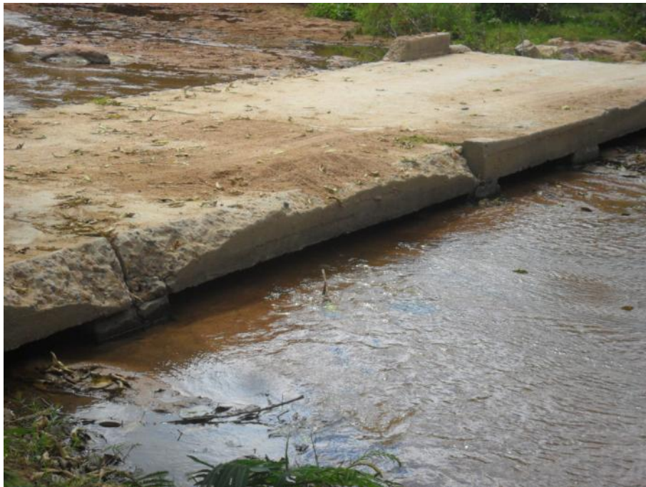
Foto 6.40 Localidad: Nuevo Coyoacán. A este vado le demolieron los muros de contención, que desborda por las orillas y es insuficiente en temporada de lluvia.
