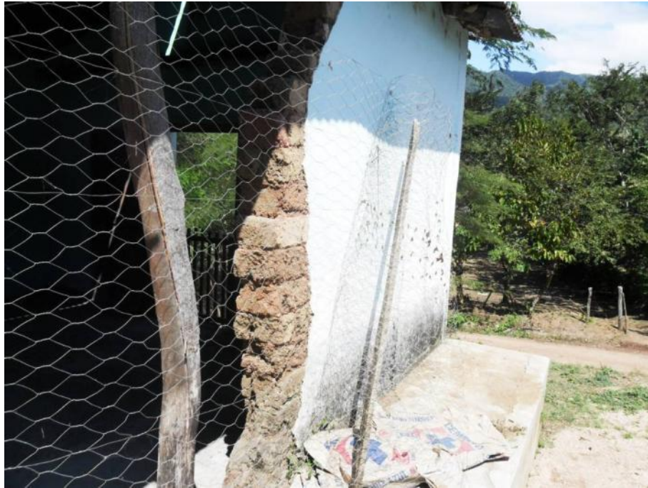
Foto 6.82 Localidad: Estoracón. Pared de un templo que se colapsó por el agua
