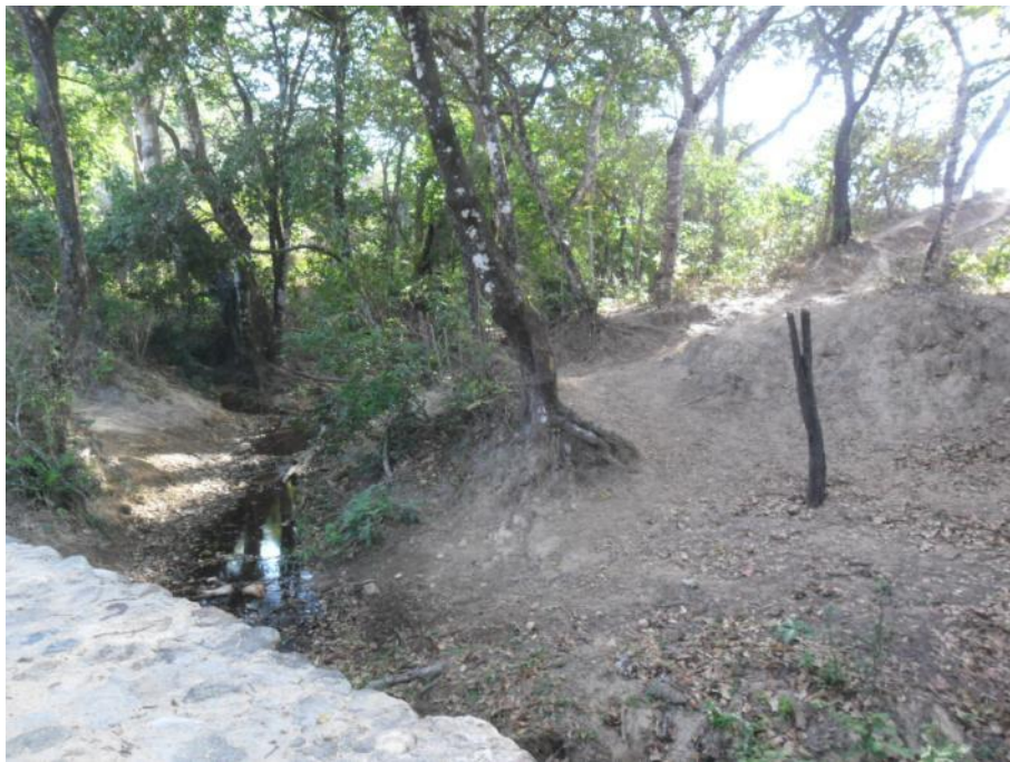
Foto 6.47 Localidad: Corazón del Valle. Puente que en temporada de lluvias se desborda por encima del puente.
