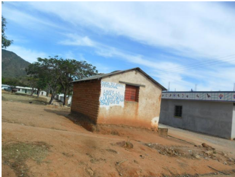
Foto 6.30 Localidad: Ing. Eloy Borrás Aguilar. Esta es una de las viviendas que muestran el deterioro a causa de lluvia y viento. Erosionando sus paredes y expuestas a un posible colapso.
