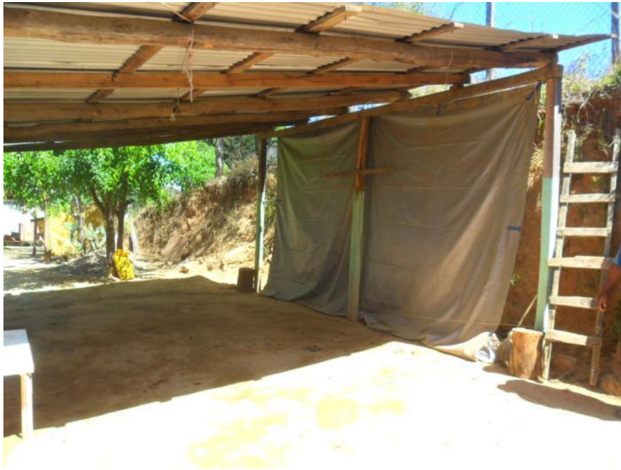
Foto 6.46 Localidad: Rizo de Oro. Aquí se encontraba una casa que debido a las constantes lluvias se colapso.
