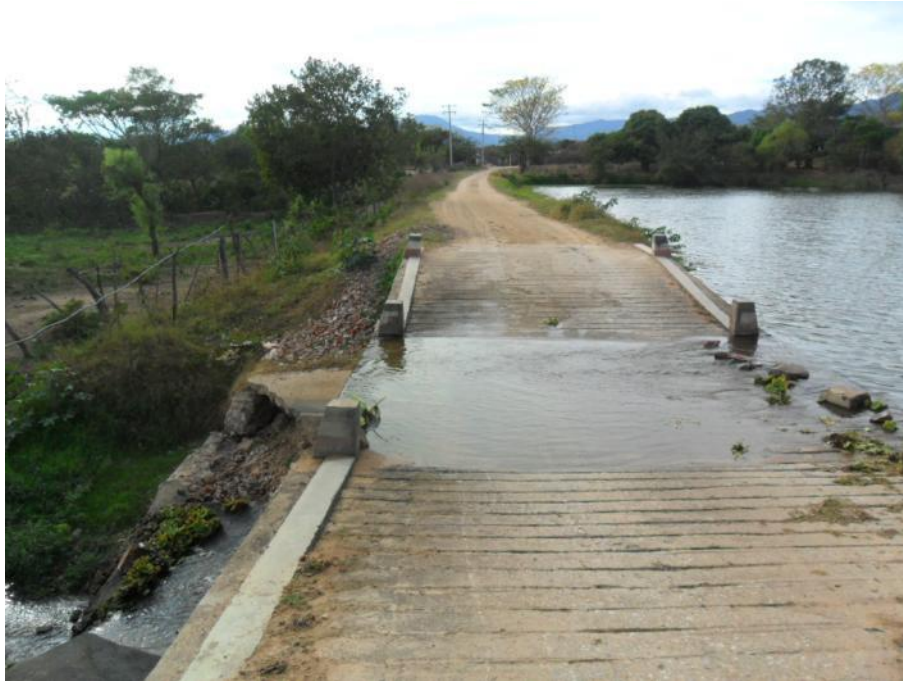
Foto 6.33 Localidad: Nueva Libertad. El vado presenta erosión en ambos lados de la cimentación.
