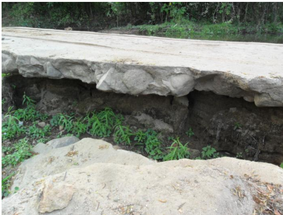
Foto 6.26 Localidad: 14 de Febrero. Vista del deterioro de la carretera que afecta también a las localidades de Tehuacán, Nuevo Coyoacán y Roberto Barrios.
