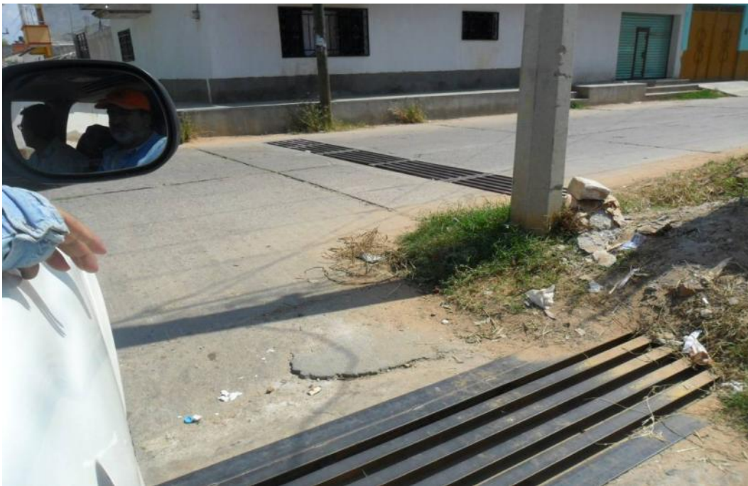
Foto 6.14 Localidad: Cintalapa. Sistema de alcantarillado en zonas de inundación, dentro de la mancha urbana.
