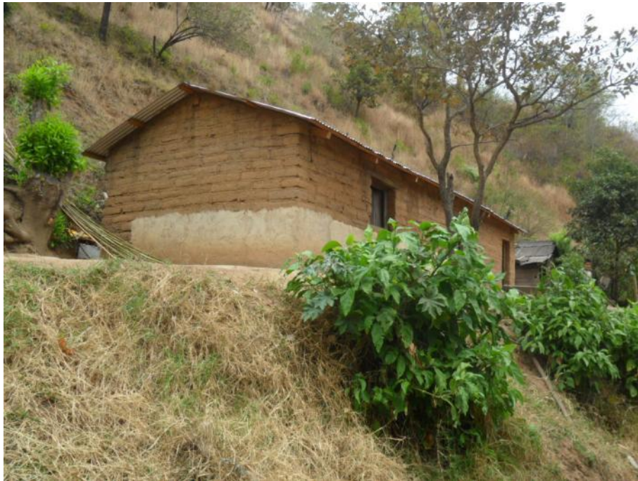
Foto 6.36 Localidad: Bethel. Al igual que está y otras viviendas e encuentran en riesgo por las corrientes superficiales que se ocasionan sobre el cerro aledaño.
