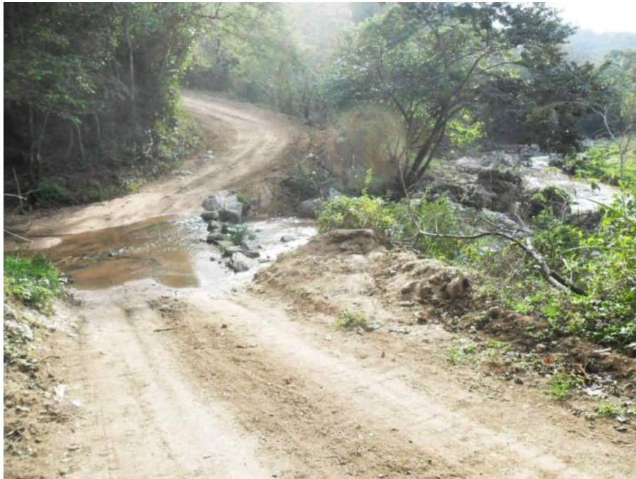
Foto 6.77 Localidad: Simón Bolívar. Sitio donde el arroyo El Chintul, antes de descargar al río La Sombra, impide el paso a las personas y vehículos durante sus máximas avenidas de agua.
