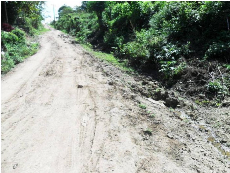
Foto 6.81 Localidad: Estoracón. Sitio donde se ubica una corriente de agua que en época de lluvias obstruye el paso vehicular, afectando a otras localidades localizadas aguas abajo.
