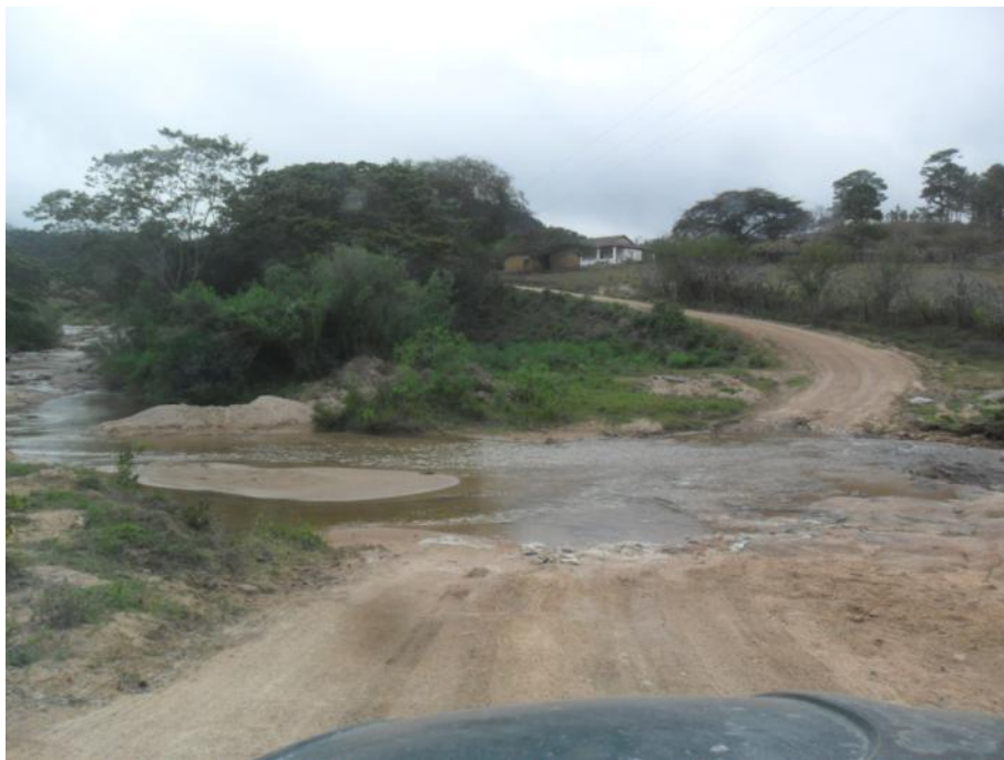
Foto 6.49 Localidad: Nuevas Maravillas. Este acceso en temporada de lluvias es imposible transitarlo, los habitantes colocan costales de arena para poder pasar sus carros hacia el otro lado, lo mismo ocurre en la localidad Las Pavas .
