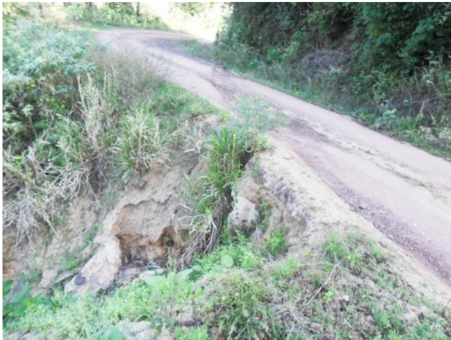
Foto 6.79 Localidad: Estoracón. Derrumbe que puede obstruir el camino antes de llegar a Francisco I. Madero.
