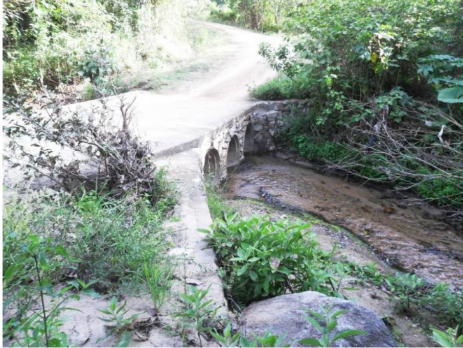
Foto 6.76 Localidad: Guadalupe Victoria Uno (La Herradura). Cuando llueve en exceso la corriente de agua rebalsa el puente e impide el paso de los habitantes.
