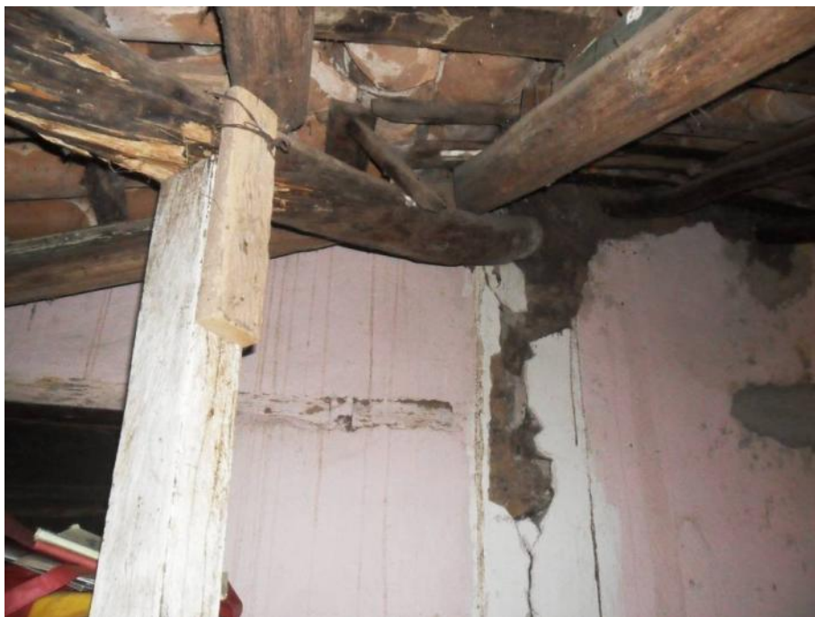
Foto 6.65 Localidad: Ocho de Enero. Vivienda de adobe dañada por un sismo y reforzada en su estructura de madera.
