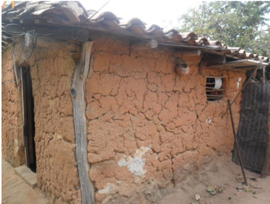
Foto 6.31 Localidad: La Asunción.- Se muestra del deterioro a causa de agentes erosionantes como la lluvia y el viento.
