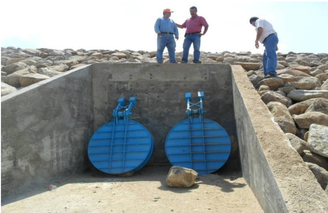
Foto 6.8 Localidad: Cintalapa. Compuertas de descarga al rio.
