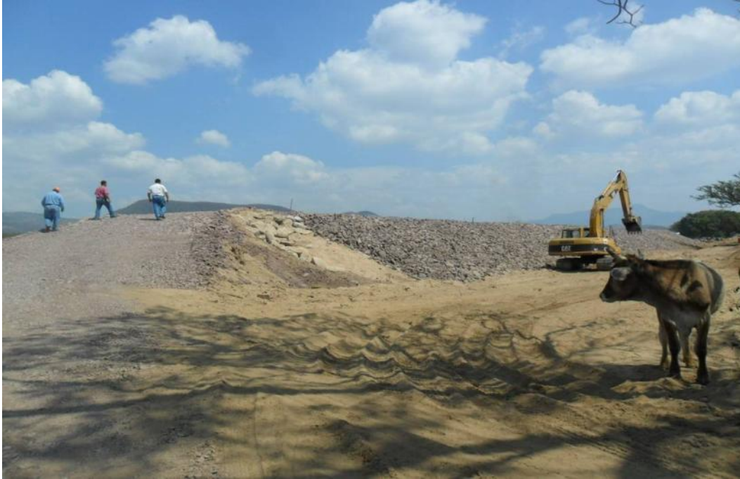
Foto 6.7 Localidad: Cintalapa. Corona del bordo de protección ubicado sobre el margen derecha del rio Cintalapa.
