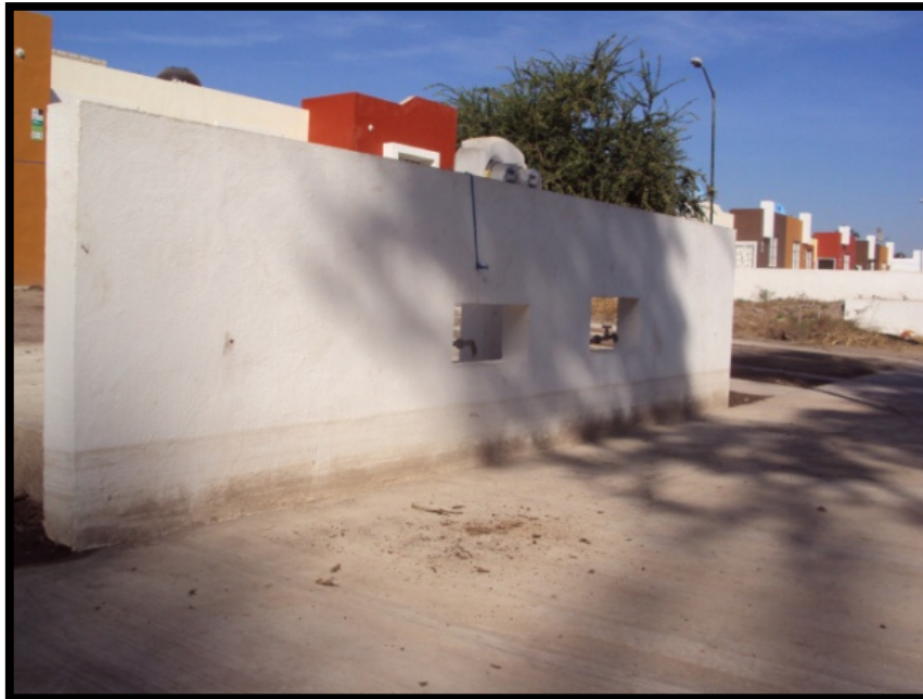
Imagen. 79 Muro que muestra la altura a la que llegó el nivel del agua sobre la calle Palmar de la Orquídea.
