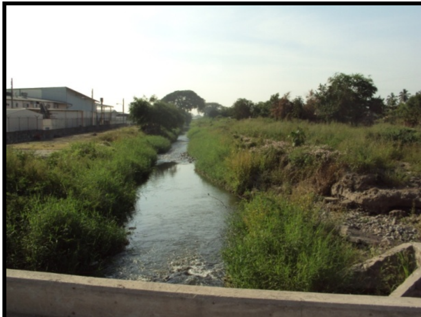
Imagen. 48 Dren Tecuanillo. Se observa en condiciones normales, y ante lluvias intensas se desaborda alcanzando alturas de hasta 2.5 metros.
