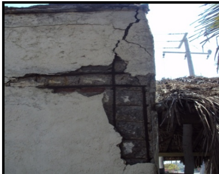
Imagen. 23 Construcción de la Enramada Bara Bara. Se observa los estragos que dejaron los movimientos telúricos del sismo del 2003. Se puede apreciar agrietamientos en la parte izquierda del muro de la cocina del local, así como, también el desplome del enjarre.
