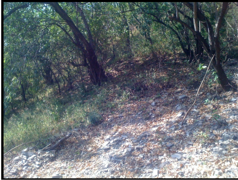
Imagen. 24 Esta figura permite apreciar la inclinación de la vegetación que se encuentra sobre las serranías de la localidad de Tecolapa, por lo que, se considera zona de alto peligro por deslizamientos debido a la inestabilidad de la ladera, además porque se encuentran en el sitio algunos asentamientos irregulares sobre las faldas del macizo montañoso.
