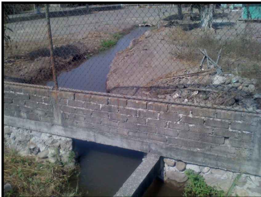
Imagen. 121 Parte del dren que cruza la Escuela Primaria Emiliano Zapata.
