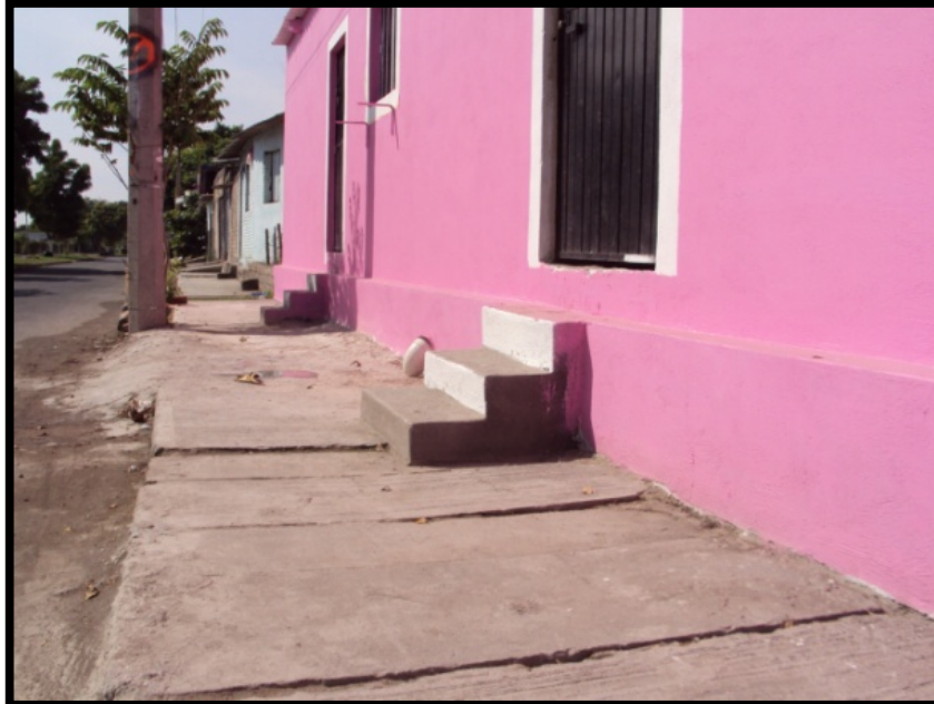
Imagen. 67 Viviendas ubicadas sobre la Av. de los Maestros que muestran las medidas de prevención que tomaron los habitantes, para evitar los estragos que deja las inundaciones de la zona: se observa que levantaron las puertas de ingreso a su vivienda para minimizar daños.
