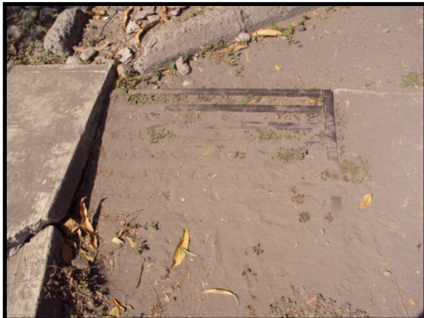
Imagen. 66 Alcantarilla ubicada en la calle Pto. De Manzanillo donde se observa completamente tapada por los sedimentos que lleva consigo el caudal de la inundación.
