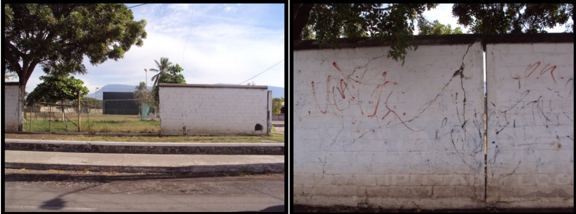
Imagen. 7 Muros de la Unidad Deportiva Norte ubicada sobre la calle Mercurio y Ejército Nacional. Se observa el muro que colapso durante el paso de las ondas sísmicas por el lugar. Además se observa como los castillos que unen a estos muros se separaron aproximadamente 6 centímetros, como también se evidencia hoyos y cuarteaduras en la mampostería.
