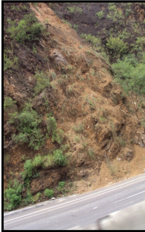
Imagen. 41 Ladera ubicada en la Autopista Manzanillo – Colima, donde se presenta una ladera inestable.
