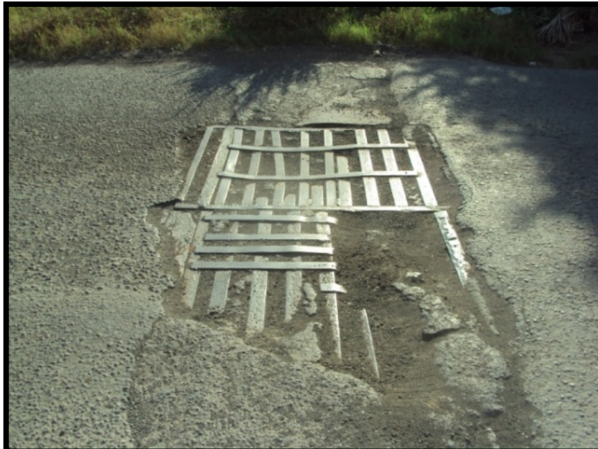
Imagen. 57 Alcantarilla ubicada sobre la calle Independencia a su cruce con calle Tlaxcala; se encuentra totalmente azolvada y cubierta de asfalto y arena que se fue acumulando por falta de limpieza.
