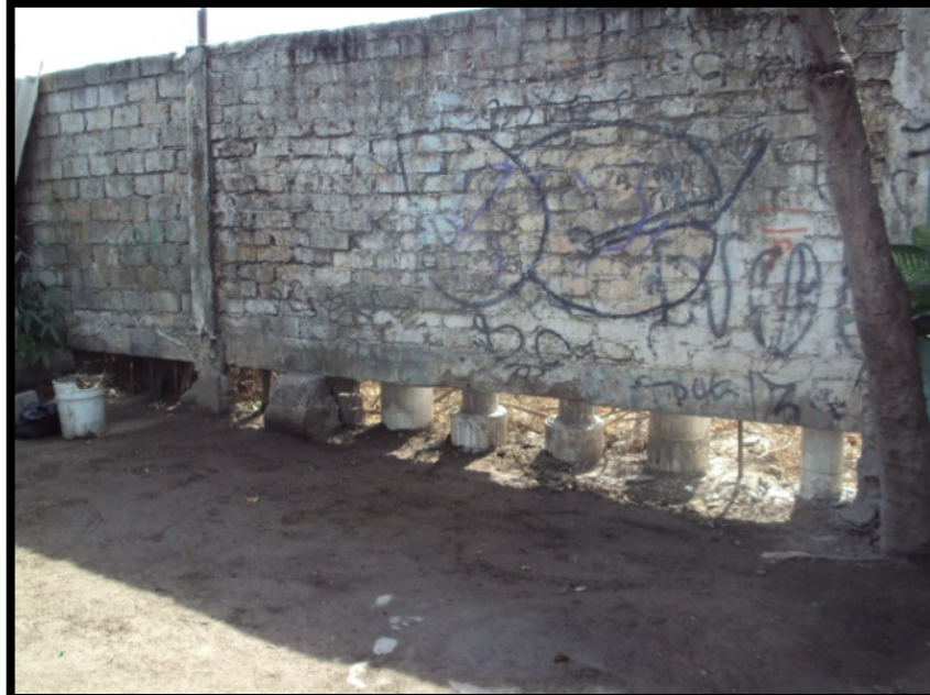
Imagen. 77 Muro que divide la Zona urbana con de las huertas de cultivo ubicadas en las calles Río Bravo, Río Balsas, Río Papaloapán y Río Grijalva. Este impide el libre flujo y provoca la saturación de la precipitación, provocando inundaciones con alturas de hasta 50 cm o más.
