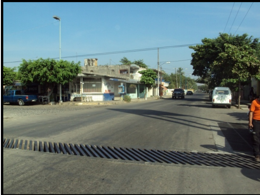
Imagen. 59 Avenida Juan Oseguera y Prol. Revolución donde se presentan inundaciones de hasta 40 cm de altura. En este lugar se encuentra una alcantarilla que no es suficiente para captar toda el agua que fluye sobre la avenida.
