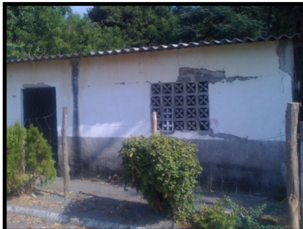
Imagen. 16 Vivienda que ha presentando daños de cuarteaduras y caída del enjarre en muros a consecuencia de las manifestaciones sísmicas.
