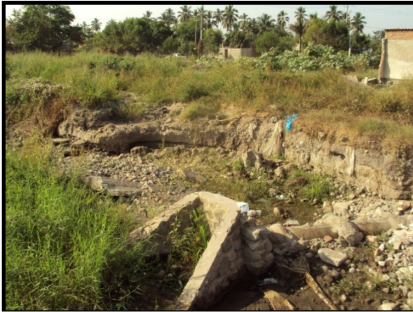
Imagen. 49 Borde del dren Tecuanillo que muestra los estragos que dejó la crecida del cauce por el huracán "Jova". Se observa el arrastre de material de los muros del dren.
