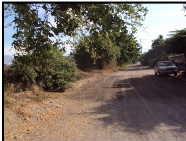
Imagen. 12 En esta imagen se observa la calle Panamá lugar donde se presento un agrietamiento de 40 cm de anchura aproximadamente, el cual fue rellenado con escombros por los mismos vecinos de la localidad. Este agrietamiento se debió a los movimientos sísmicos que se generan en la zona.
