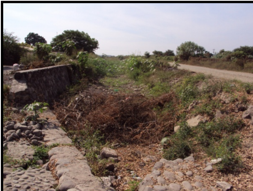
Imagen. 68 Av. de los Maestros: se forma al canal que va directo a las huertas del llano costero de Tecomán. Antes de la temporada de lluvias, este canal es desazolvado para evitar que el caudal que corre por la avenida se sature y fluya en dirección Sur.
