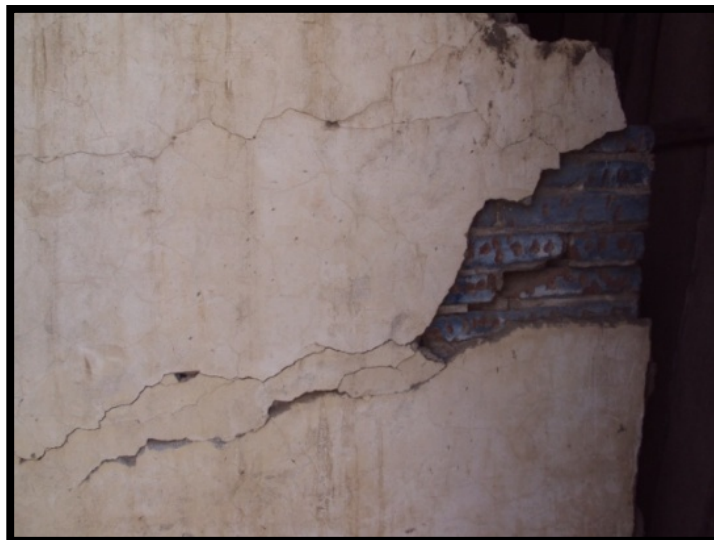
Imagen. 14 En esta imagen se pueden observar los daños severos que presenta la fachada en una de sus extremidades como: cuarteaduras y caída de enjarre así como también, al lado derecho de la misma se encuentra parte del muro que le sirve como soporte para que no se colapse.
