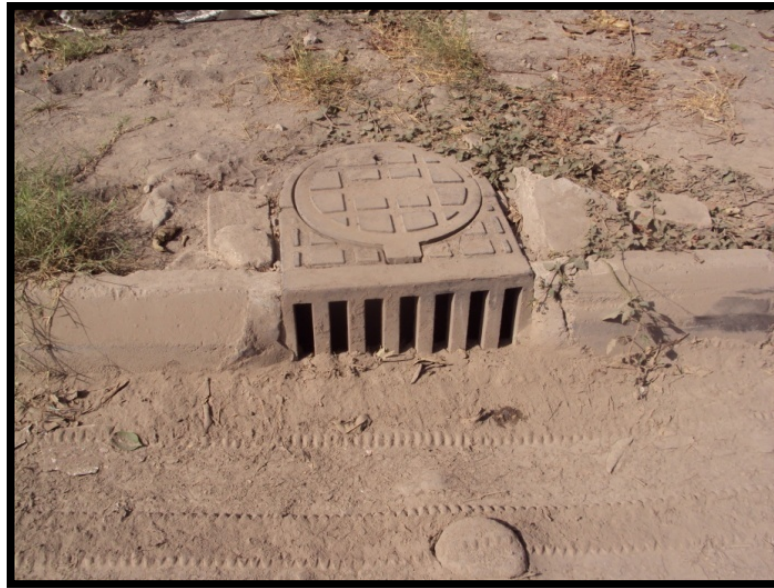
Imagen. 90 Sistema de drenaje ineficiente que no permite el desahogo de la captación pluvial.
