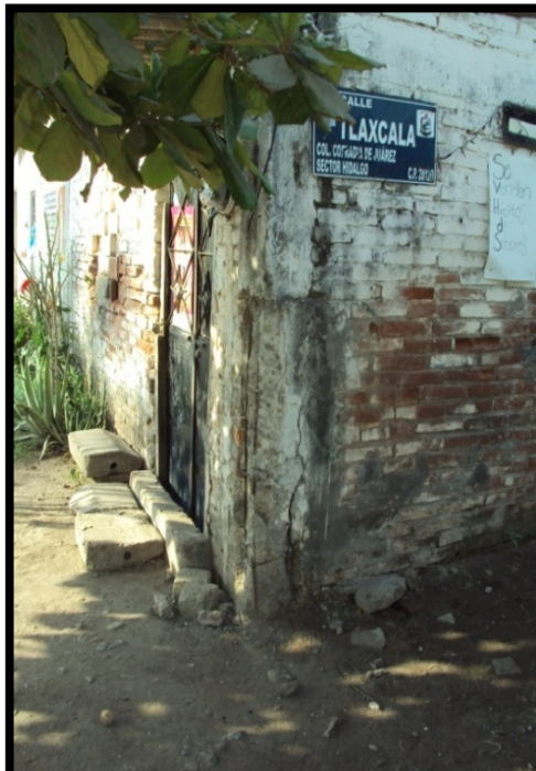
Imagen. 58 Vivienda ubicada sobre la calle Independencia y Tlaxcala que presenta los estragos que dejan las inundaciones en esta colonia.
