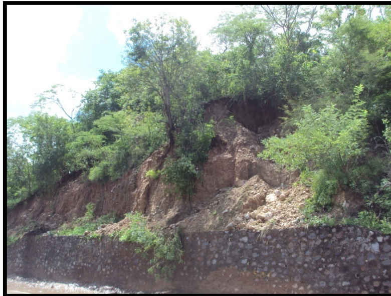
Imagen. 26 Durante el paso de los fenómenos hidrometeorológicos en el municipio, estos han permitido identificar las zonas inestables que tienen las serranías del municipio, Se observa en la parte central, la debilidad que posee el material, por lo que el nivel de peligrosidad es alto.
