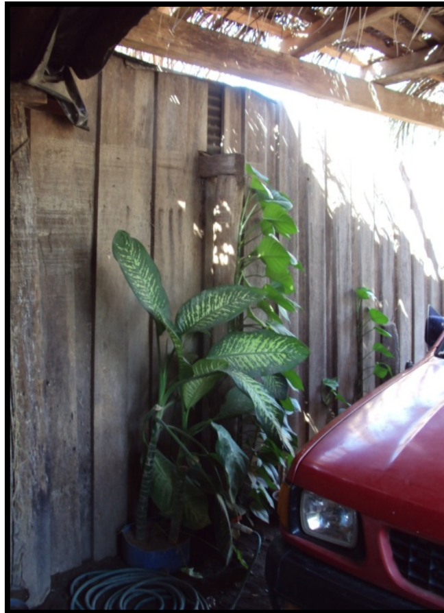
Imagen. 112 Muro de vivienda donde se puede observar la evidencia de la crecida que tuvo el dren Tecuanillo; casi a 2 metros de altura.
