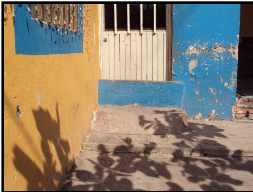
Imagen. 74 Vivienda ubicada sobre la calle Ramón Serrano: el propietario de la finca tomo sus propias medidas de prevención para evitar daños a su inmueble, al colocar una barrera de concreto que impide el acceso del agua al presentarse precipitaciones en la Colonia Infonavit. Sin embargo, la problemática continúa en esta y otras viviendas debido a la salida de aguas negras por el retrete y los resumideros de la finca.
