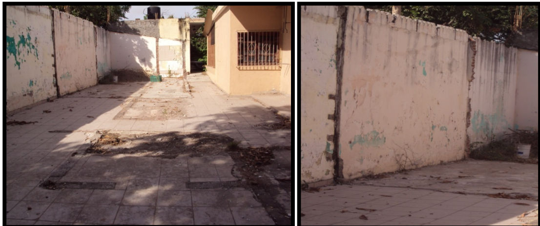
Imagen. 11 Vecindad ubicada sobre las calles José Antonio Torres y Belisario Domínguez que presentó colapso en muros y techos: se tuvo que demoler la construcción restante ya que por su inestabilidad representaba un riesgo para las personas que habitan ese lugar.
