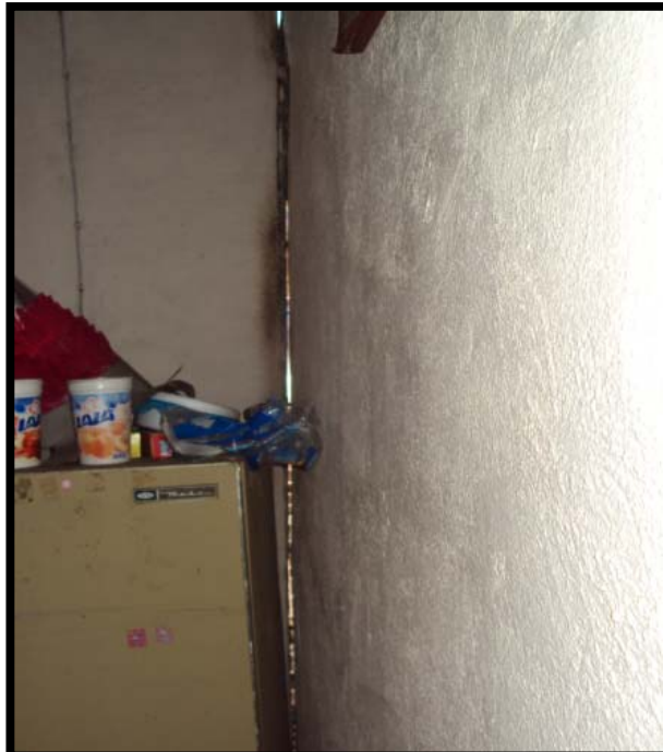
Imagen. 13 En este domicilio las afectaciones que han provocado los sismos han ocasionado que en sus muros y pisos se presenten aberturas de gran tamaño (dos cm aproximadamente).
