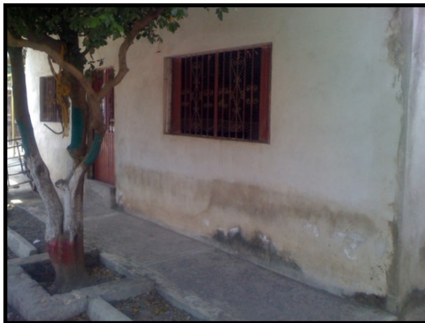
Imagen. 119 Evidencia del nivel de inundación sobre la calle 5 de Mayo y Francisco Velazco Curiel Norte, donde el tirante alcanzó los 80 cm de altura.
