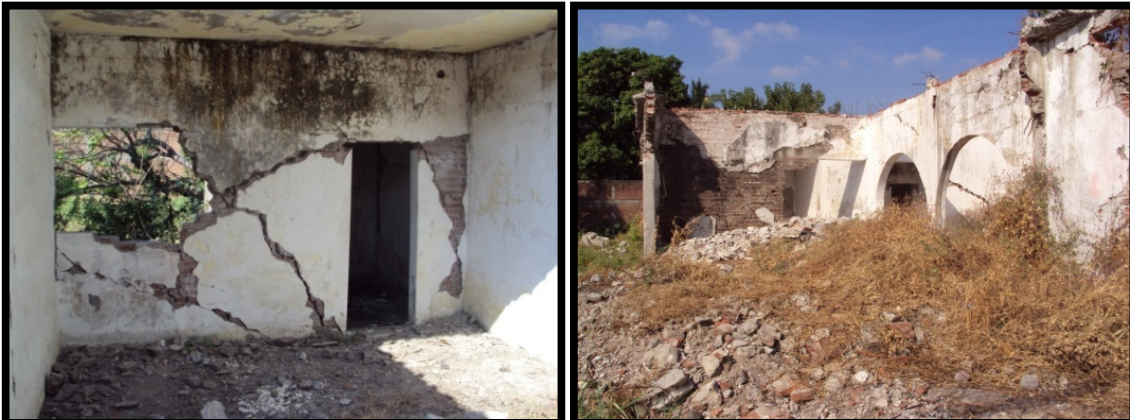
Imagen. 15 Finca ubicada en la calle Revolución y José María Morelos y Pavón. Se observa la intensidad a la que fue sometida esta vivienda quedando completamente en ruinas, por la presencia de las ondas sísmicas que se generan en el municipio. Presenta colapso completamente en el techo, agrietamientos en sus muros y el desplome de los mismos tras el sismo que se presentó en el 2003.
