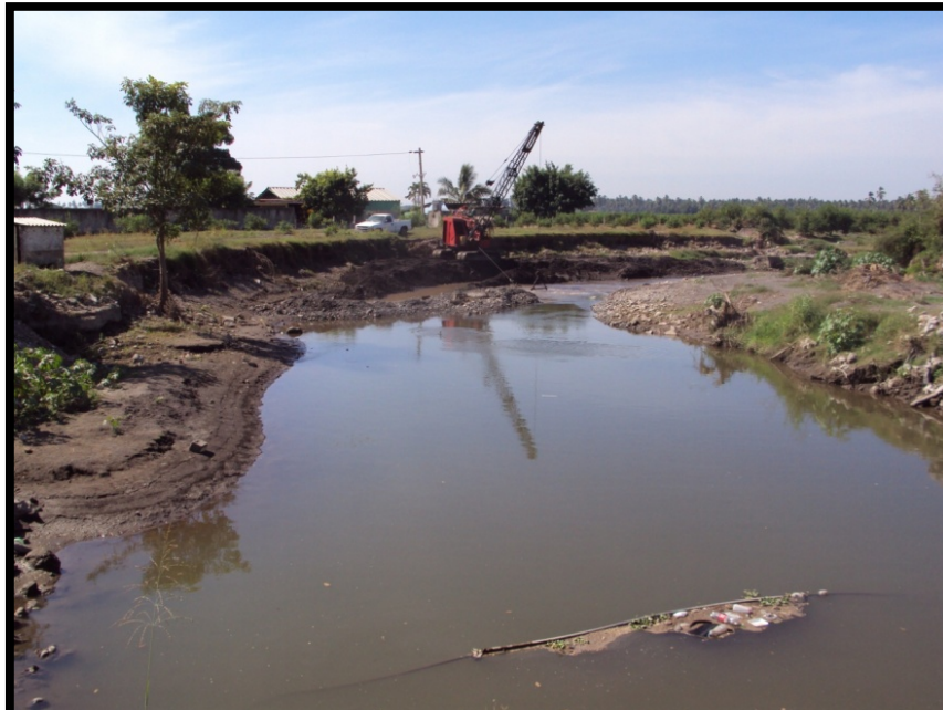
Imagen. 116 Parte Sur del puente Tecuanillo que muestra la presión con la que se desbordo el cauce del dren, provocando que las paredes del mismo fueran derrumbadas, agrandando lo ancho dren aproximadamente 10 metros.
