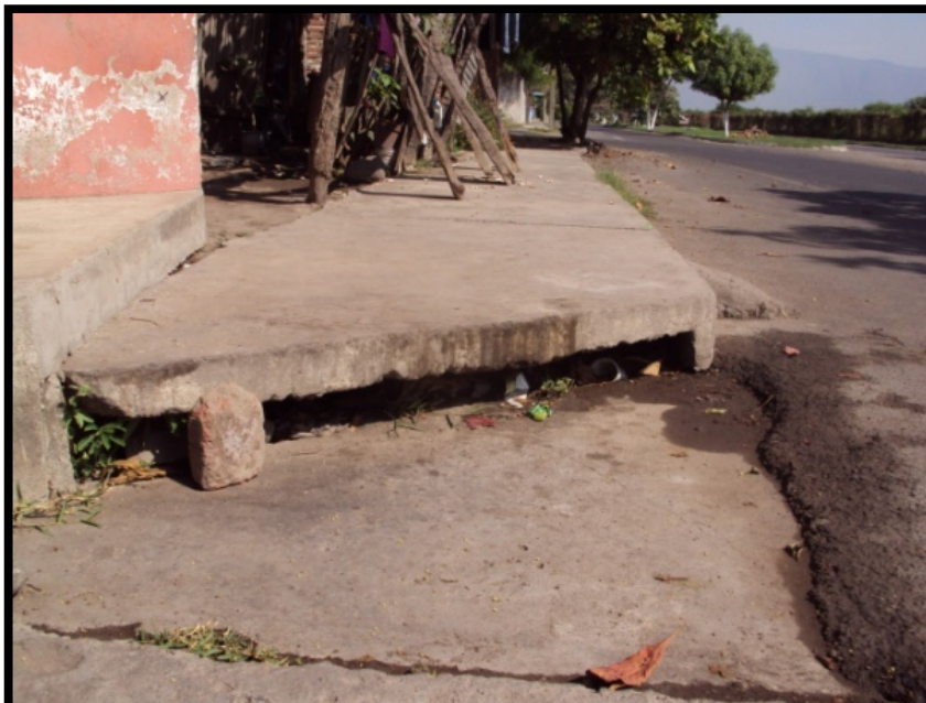
Imagen. 64 Coladera tapada por los mismos habitantes del lugar, debido a la cantidad de accidentes que se presentaban en la zona, a causa de las inundaciones que se manifiestan en forma de caudal en la Av. de los Maestros.
