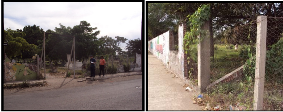
Imagen. 9 Muros del panteón de los recuerdos que colapso, durante la presencia del sismo del 2003.
