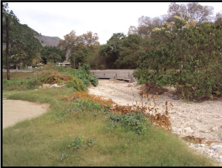
Imagen. 103 Nivel de arrastre de material sobre puente de vías férreas.
