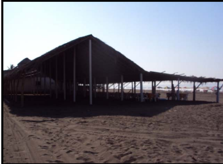
Imagen. 136 Algunas entramadas que han sufrido estragos por la manifestación de fenómenos hidrometeorológicos, tanto por huracanes, vientos fuertes, marejadas, tormentas tropicales como también inundaciones.
