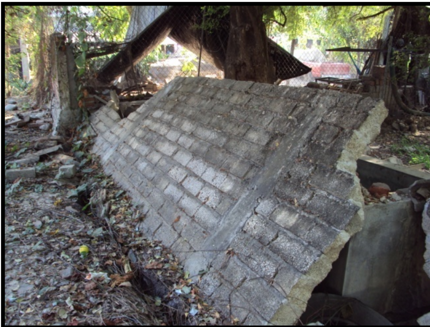
Imagen. 125 Vivienda localizada en la parte central de la localidad, entre las calles José María Morelos y Revolución. La propietaria del lugar señalo que la fuerza del cauce provoco el desplome del muro.
