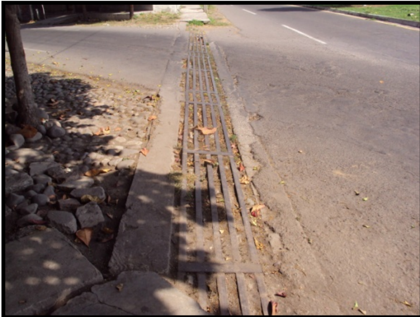
Imagen. 65 Alcantarilla saturada de arena y basura que no ha sido desazolvada, se ubica en Av. de los Maestros a su cruce con la calle Medellín.
