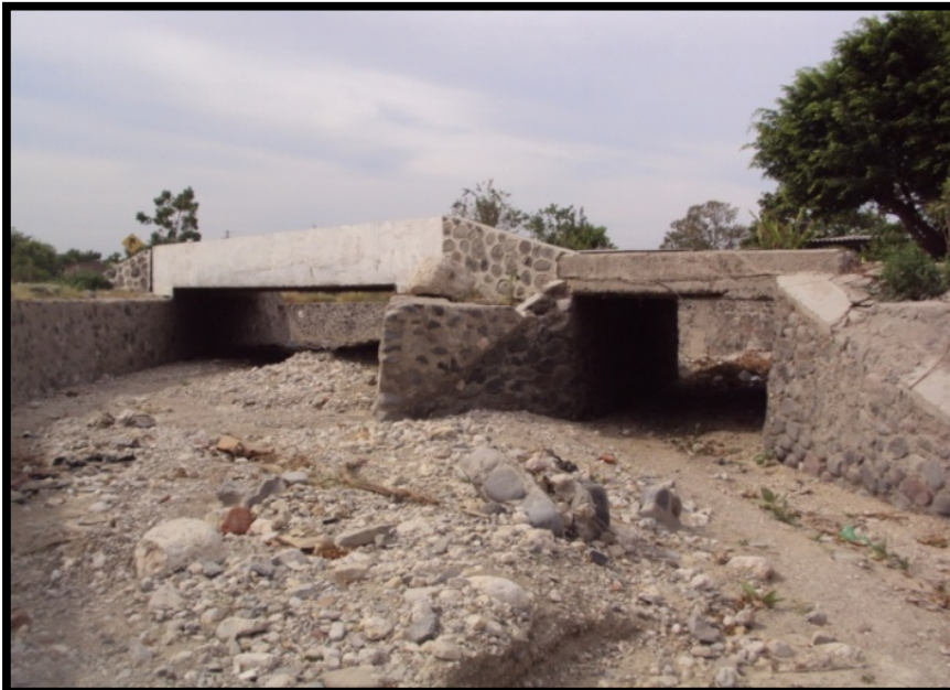
Imagen. 96 El dren que fue saturado debido a la barrera creada por el escombros. El tirante alcanzado fue de 4 metros de altura aproximadamente.
