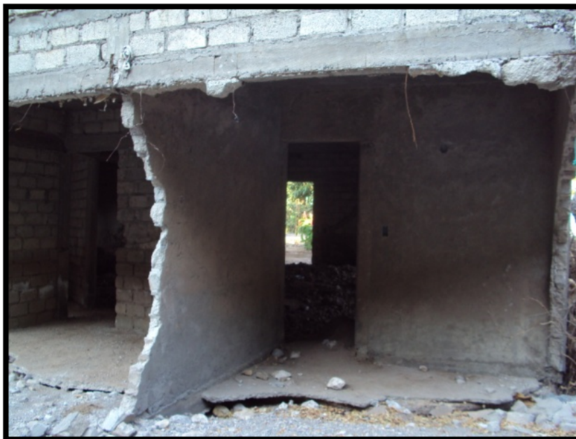
Imagen. 130 Vivienda localizada prácticamente dentro del cauce del arroyo seco La Salada, declaró como pérdida total.
