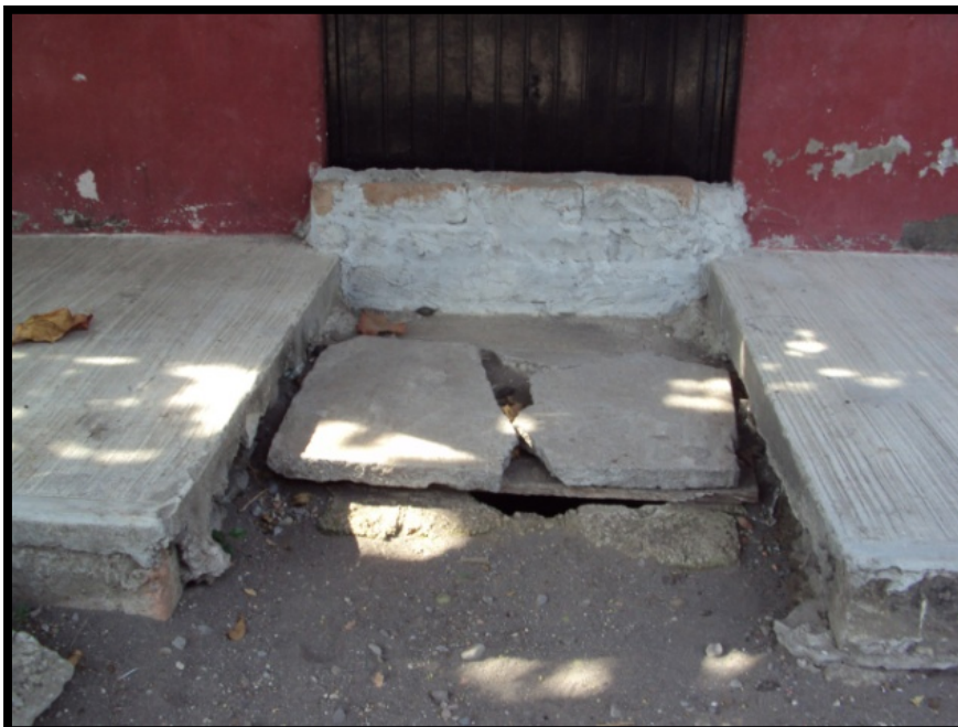
Imagen. 76 Vivienda ubicada por la calle Río Bravo y Luis Crisantemo en la Colonia Elías Zamora, donde se muestra una alcantarilla destapada sobre la entrada principal de la vivienda, que año tras año en temporadas de lluvias esta brotan los desechos sanitarios, provocando problemas de salud.
