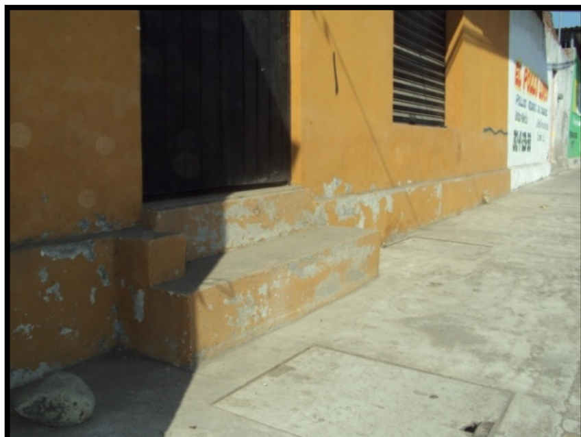
Imagen. 62 Vivienda ubicada sobre la calle Matamoros, donde se observa el levantamiento de la puerta de acceso a la vivienda para evitar mayores daños a causa de las inundaciones de la zona.
