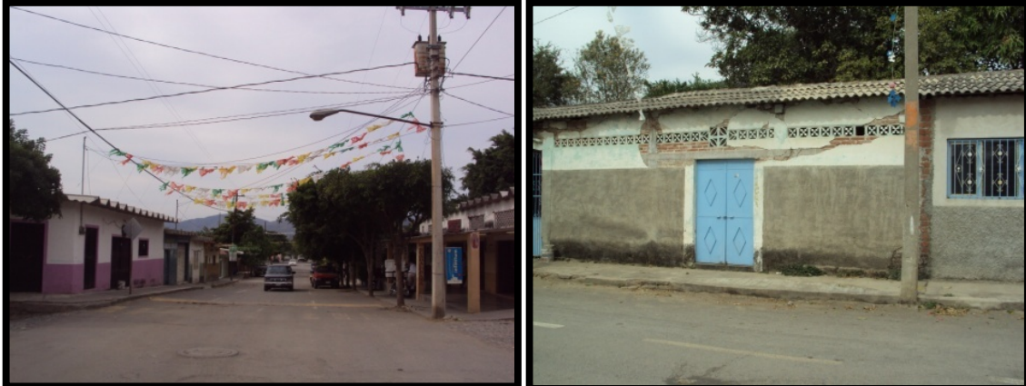
Imagen. 20 Av. México donde se vieron afectadas las viviendas con el paso de las ondas sísmicas. En la fotografía de la derecha se muestran los estragos que dejaron estos movimientos telúricos, los cuales produjeron en la parte alta de la vivienda el desplome del enjarre y algunas cuarteaduras en la fachada principal de la misma.
