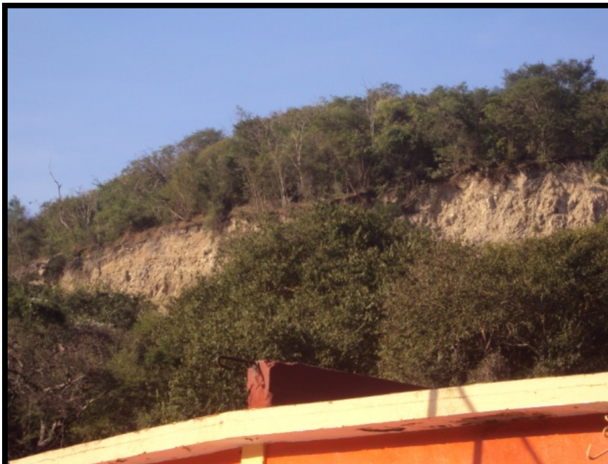
Imagen. 37 Talud ubicada sobre la Autopista Tecomán – Colima a la altura de la localidad de La Salada. Se observa el cuerpo litológico desnudo sometido a intemperización, la cual es susceptible a derrumbes.
