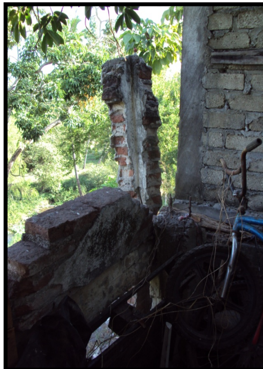
Imagen. 89 Patio de una vivienda que conecta con el río Armería que se encuentra sobre la Avenida México. Se observa la afectación en su muro del patio, ya que se ubica en una pendiente pronunciada y con evidencias de derrumbe.
