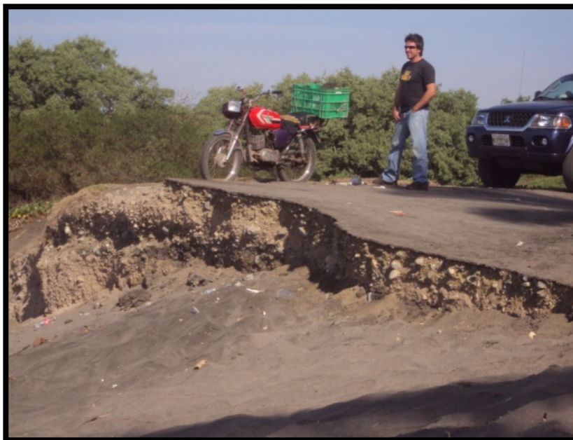
Imagen. 146 Carretera Antigua a Boca de Apiza: afectada severamente por los fenómenos hidrometeorológicos. Esta carretera fue reubicada iniciando su entronque en la carretera Tecomán – Lázaro Cárdenas, a la altura de la localidad Cerro de Ortega.
