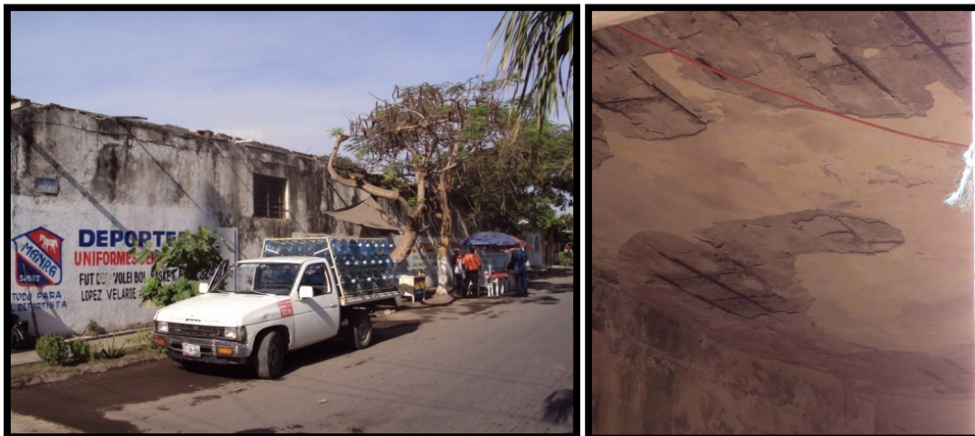
Imagen. 6 Durante el sismo de 2003 la fábrica de hielo Bajo Cero , ubicada sobre las calles Mercurio y Ejército Nacional resulto severamente afectada, al grado de tener que abandonar la finca para reubicarse. Se observa en la esquina del techo y el muro (fotografía izquierda) unas cuarteaduras y el enjarre desplomado que en ocasiones este sigue desprendiéndose.
