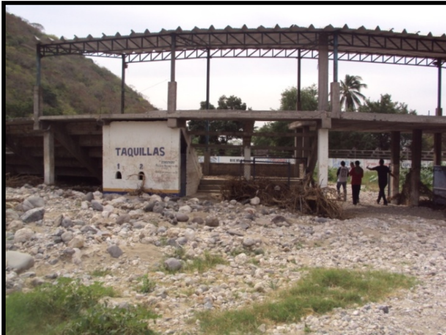
Imagen. 101 Plaza de toros cubierta de escombros al desbordarse el dren alcanzando 1.5 metros de altura.
