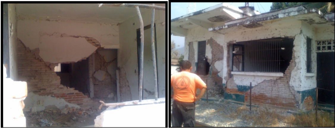
Imagen.17 Fotografías que muestra en las condiciones en que quedo la estructura de las oficinas de la F.F.C.C. en la localidad de Caleras, después del sismo ocurrido en esta zona. Por lo que, prácticamente quedo en condiciones inoperables y en riesgo de desplome.
