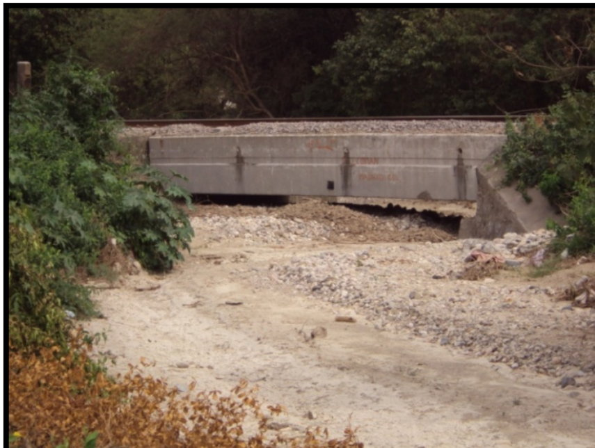
Imagen. 100 Punto de saturación del dren sobre las vías del tren entre las calles Carlos Vázquez Tecomán y Avenida Américas.
