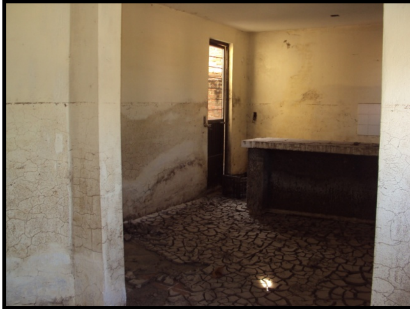
Imagen. 51 Interior de la vivienda donde se muestra la altura a la que llegó la crecida del agua que desbordo del dren arrasando prácticamente con todo los bienes materiales.
