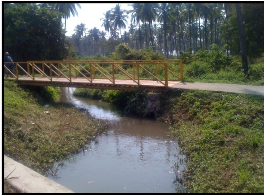
Imagen. 120 En este punto se presentó desbordamiento del dren que presento aproximadamente 2.50 mts. De altura afectado parte de la carretera que comunica a las localidades de Caleras -Madrid.
