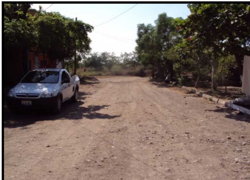
Imagen. 83 Calle Francisco I. Madero donde se presentan inundaciones de tipo pluvial año con año en forma de caudal.
