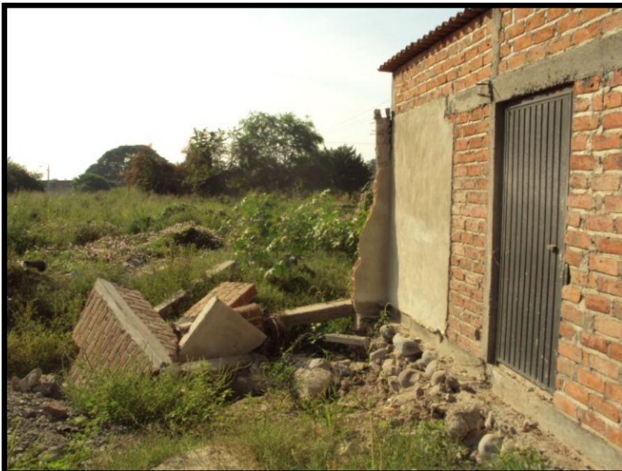
Imagen. 52 Vivienda abandonada que presenta los estragos que dejó la crecida del cauce: varios muros y el techo desplomados, la finca presenta cuarteaduras severas.
