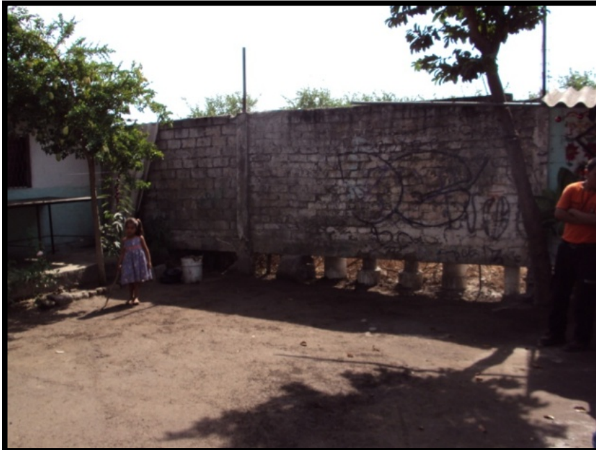
Imagen. 75 Calle Río Bravo donde se presenta una saturación de agua que alcanza los 50 cm aproximadamente.
