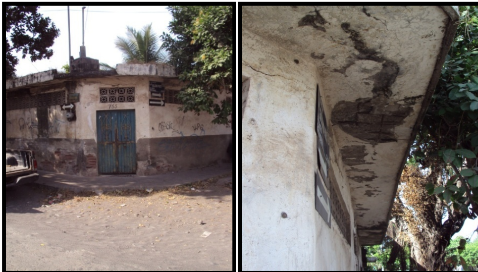
Imagen. 8 Finca ubicada sobre la calle Morelos y Guillermo Prieto que actualmente se encuentra abandonada. Sobre la bóveda de la vivienda se evidencia el desprendimiento de enjarre y series de cuarteadura debido a la presencia del sismo.
