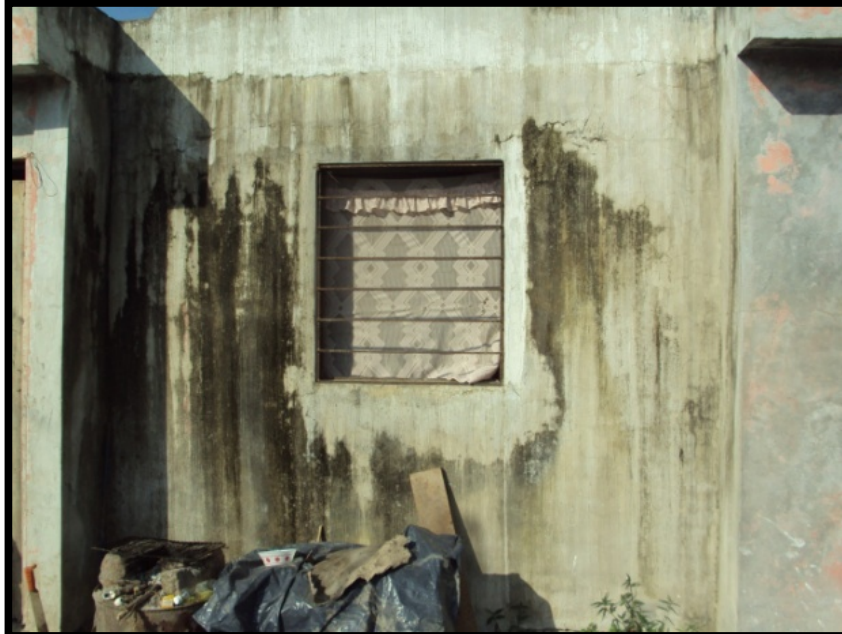
Imagen. 53 Otra vivienda afectada ubicada en la calle río Alcuzahue en el Fraccionamiento La Cuarta, donde se muestra en el muro la altura a la que llegó el agua del cauce del dren Tecuanillo.
