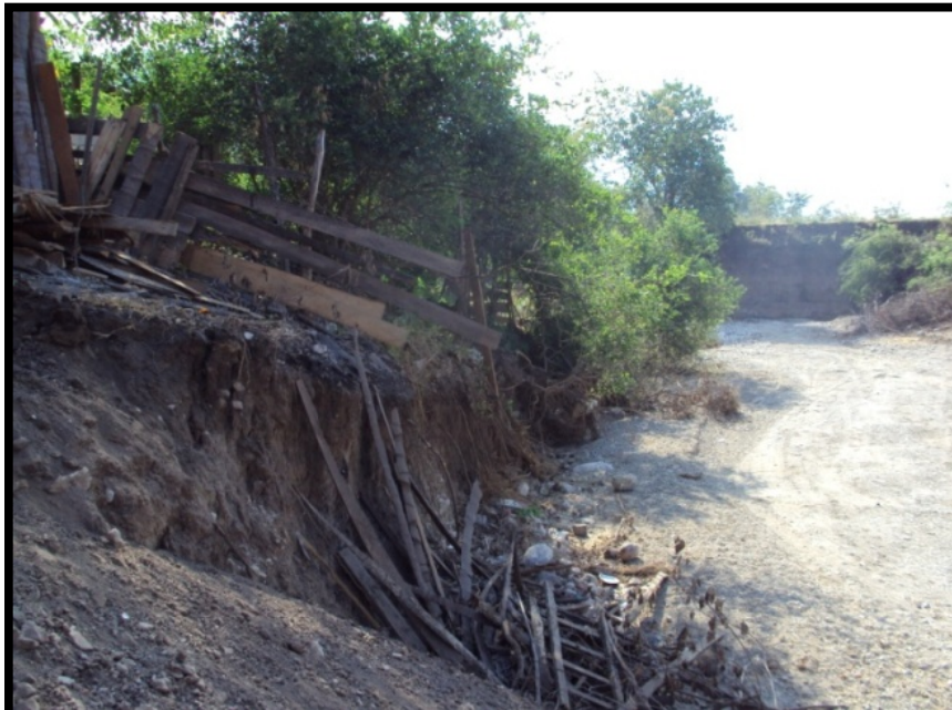
Imagen. 126 En las fotografías se puede observar el arrastre del material que se llevó la crecida del dren.
