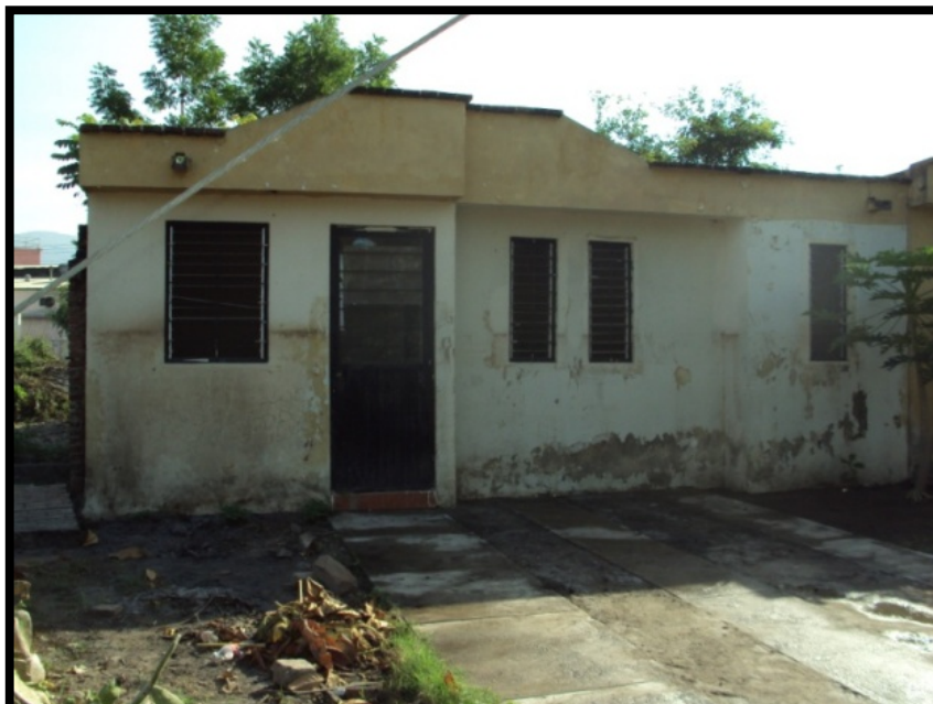
Imagen. 50 Vivienda afectada y actualmente abandonada por el desbordamiento del dren Tecuanillo.
