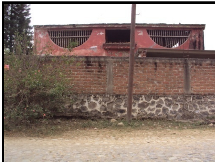
Imagen. 19 Finca ubicada en entre las calles Perú a su cruce con Guatemala, la cual quedo declarada como pérdida total, por presentar debilitamientos en los cimientos y muros por los movimientos telúricos que se han presentado en la localidad.
