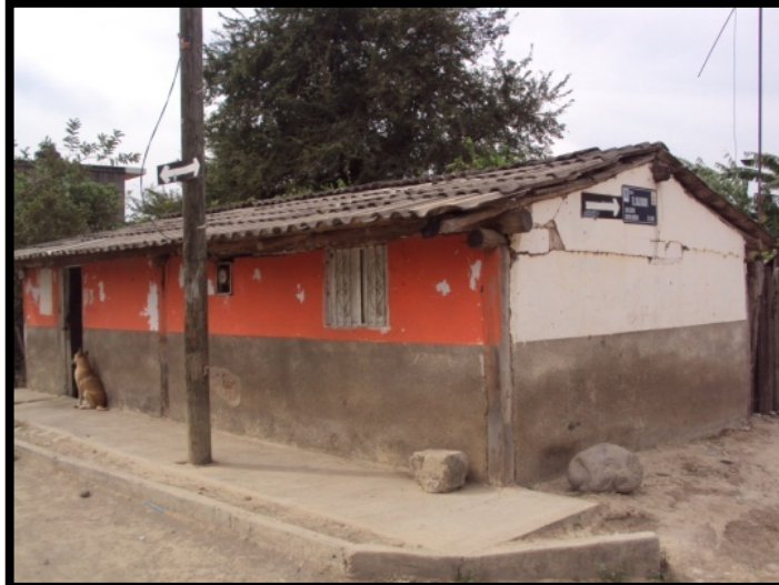
Imagen. 18 Muestra una de las viviendas que actualmente luce afectada por los estragos que han dejado los sismos en la localidad. Observando en su parte lateral alta, los diversos agrietamientos que van desde los 2.0 a los 2.20 metros de longitud aproximadamente.
