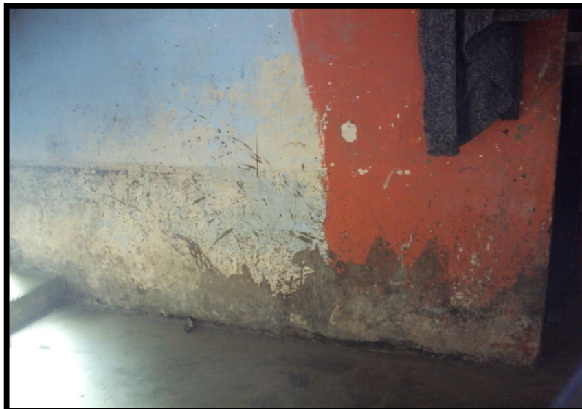
Imagen. 104 Vivienda que fue afectada por las precipitaciones intensas: introduciéndose al interior y alcanzando tirantes de 60 centímetros aproximadamente.
