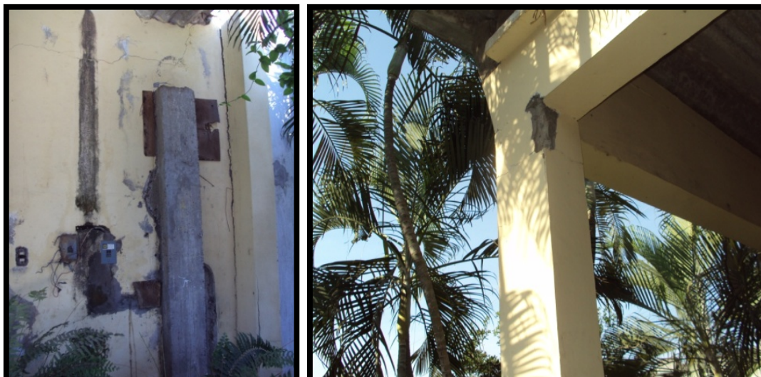
Imagen. 4 Muestra evidencia de los daños en muros y pilares a consecuencia de la manifestación por sismos: enjarre desplomado y cuarteaduras de más de dos metros de longitud declarándola como pérdida total. Sin embargo varios muros fueron apuntalados con una columna de concreto. Esta vivienda se localiza en la calle Independencia a su cruce con la calle Tlaxcala.
