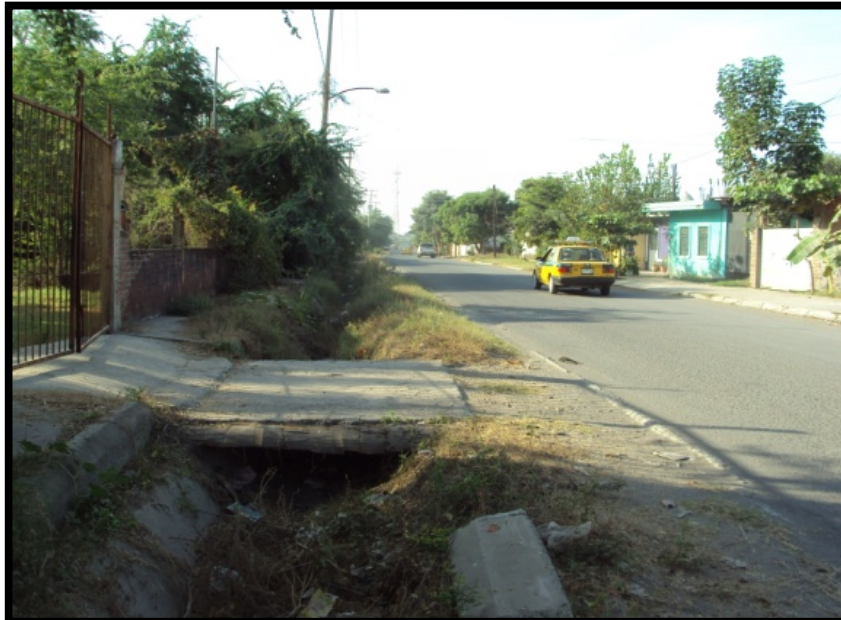
Imagen. 56 Calle Independencia: sobre la parte lateral se observa las condiciones en las que se encuentra el canal saturado de escombros, maleza y/o basura.
