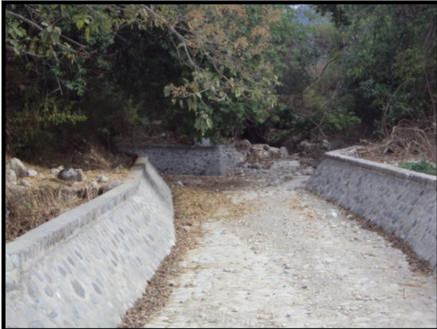
Imagen. 91 Se presenta las condiciones bajo las que se encuentra el cauce normal del dren antes de una precipitación intensa. Sin embargo al fondo en la parte derecha, se puede observar los estragos que atrae consigo las crecidas del dren: escombros y árboles derribados.
