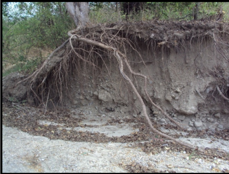
Imagen. 99 Evidencia de algunas partes el cauce del arroyo en la zona del panteón. Se muestra que prácticamente el tirante subió 2.50 a 3 metros de altura.
