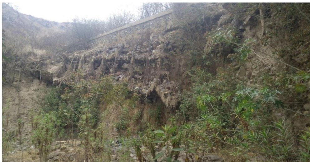
Figura 11.1.1.10 se observa socavación al final del tanque de amortiguamiento de la presa Infiernillo, se prevé erosión regresiva que pondría en riesgo la estabilidad de la cortina
