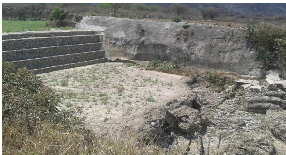
Figura 11.1.1.12 Cortina de la presa de retención de sólidos “la algodonera”, se observa la erosión regresiva en su tanque amortiguador
