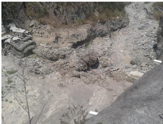
Figura 11.1.1.11 Cortina de la presa "La Algodonera" que fue destruida por la erosión regresiva
