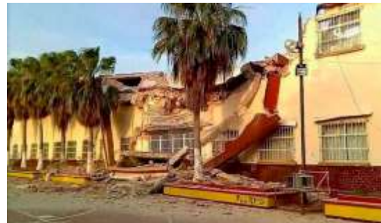
Ilustración 2 Escuela dañada después del sismo del 7 de septiembre, Juchitán, Oaxaca
