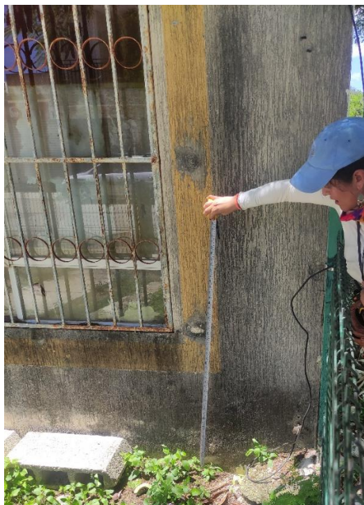
Imagen 13. Estimación de tirante de inundación en vivienda afectada en la calle Girasoles
