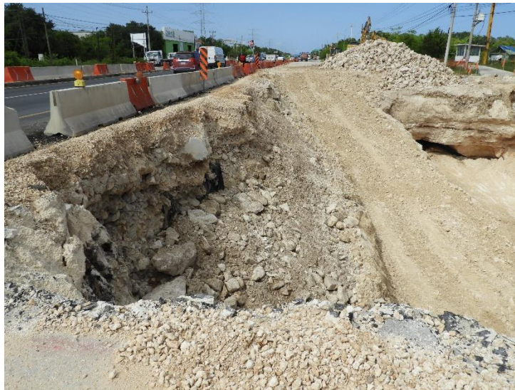
Imagen 3. Hundimiento sobre carretera federal. Posiblemente ocasionado por las obras del "Tren Maya". Se ubica en una zona de peligro medio y transición a peligro alto. Se observan pozos de extracción de agua subterránea cercanos al sitio
