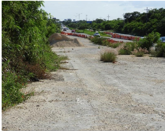
Imagen 2. Hundimiento "Iberostar" sobre carretera federal. Hundimiento reparado, posiblemente provocado por el flujo de agua subterránea. Se encuentra sobre una zona de peligro muy alto, con alta densidad de formaciones kársticas y pozos de extracción de agua subterránea.
