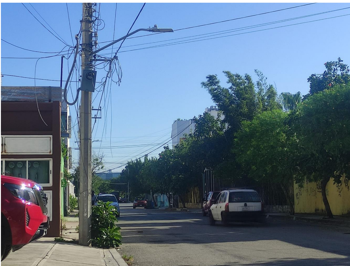
Imagen 11. Cableado eléctrico afectado por vientos fuertes en Playa del Carmen
