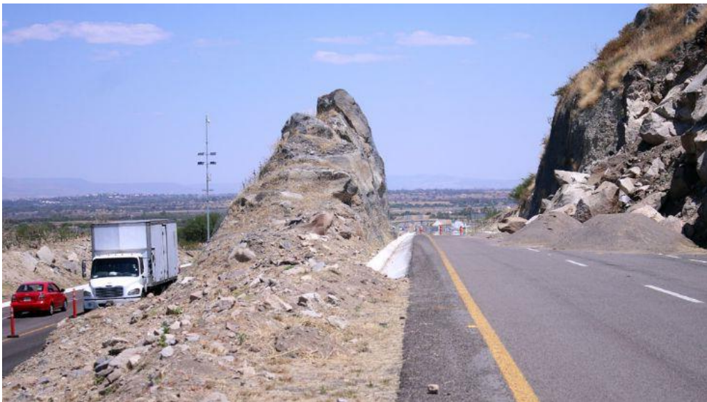
Figura 49. Presencia de laderas inestables en el municipio de Romita. Fuente: (CEPC, CMPC 2021)
