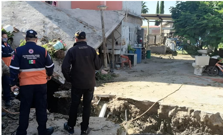
Figura 36. Afectación estructural a vivienda expuesta a agrietamientos y hundimientos diferenciales en el Estado de Guanajuato. Fuente: Gobierno del Estado de Guanajuato.
