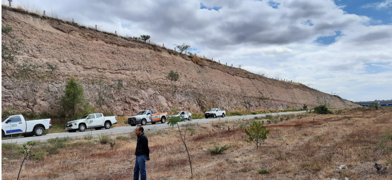
Figura 51. Zona de susceptibilidad a la inestabilidad de laderas en Carretera Eje Metropolitano del Rincón, Purísima del Rincón. Fuente: (CEPC 2021)
