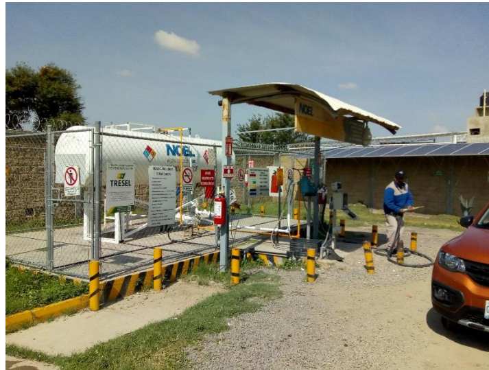
Figura 88. Estación de Gas L.P. para carburación ubicada en el municipio de León (Coordinación Municipal de Protección Civil, n.d.).
