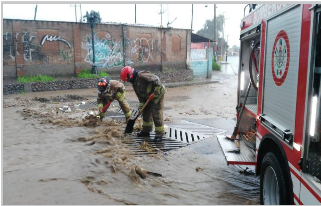
Imagen 56: Regillas obstruidas en el Arenal y Vialidad a Zacango. Fuente: Coordinación de Protección Civil y Bomberos de Metepec 2021.
