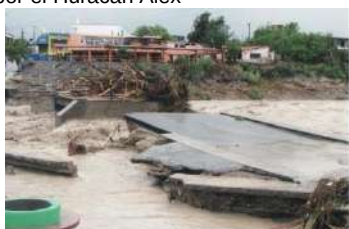
Destrucción del vado provocada por Huracán Alex.
