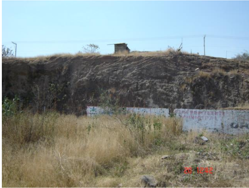
Fotografía 8. Vista del corte de terreno por construcción del libramiento carretero, lugar donde pueden ocurrir derrumbes, se distingue por la ausencia de vegetación.
