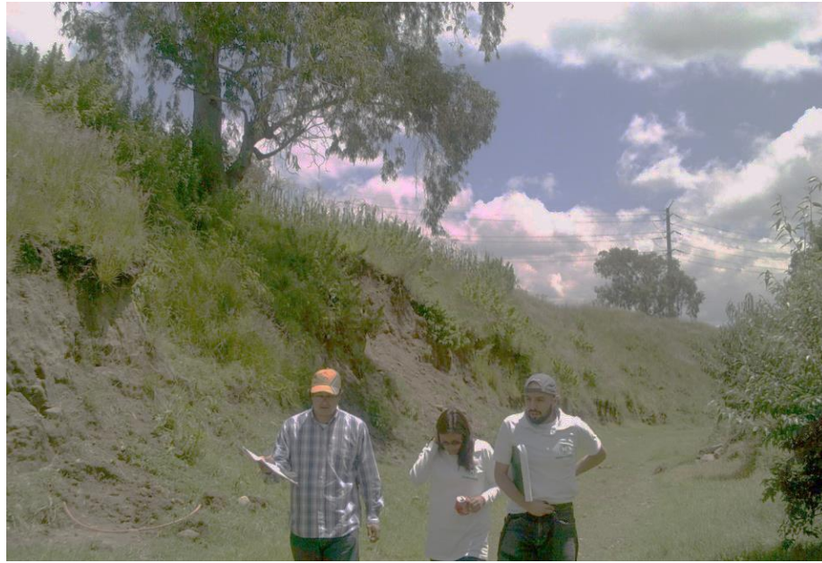
ILUSTRACIÓN 70. EN LA IMAGEN SE OBSERVAN DOS DESLIZAMIENTOS DE SUELO EN EL MARGEN DERECHO, SON RECIENTES DEBIDO A QUE NO EXISTE VEGETACIÓN, ADEMÁS SU AUSENCIA INDICA QUE ESTÁN ACTIVOS.
