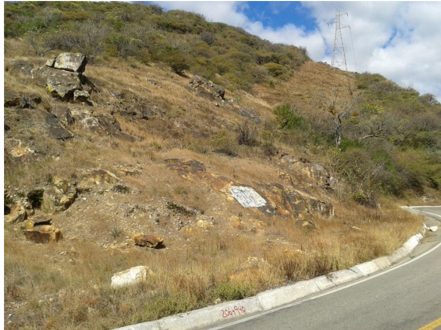
Figura 34. Fotografía en donde se observan bloques sueltos que pueden caer en la carretera que va a Tuxtepec.
