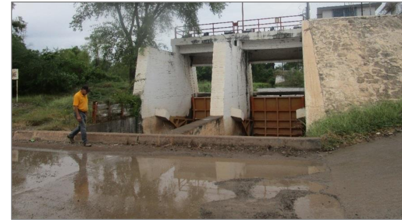
Figura 5.2.11.10. Compuertas del Río Sinaloa en los límites de la cabecera municipal. Fuente EM Capital.
