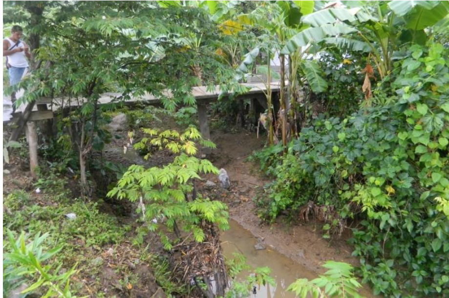
Fig. 36. Canal en la localidad de El Llano, en caso de flujos se no habría acceso a las casas.
