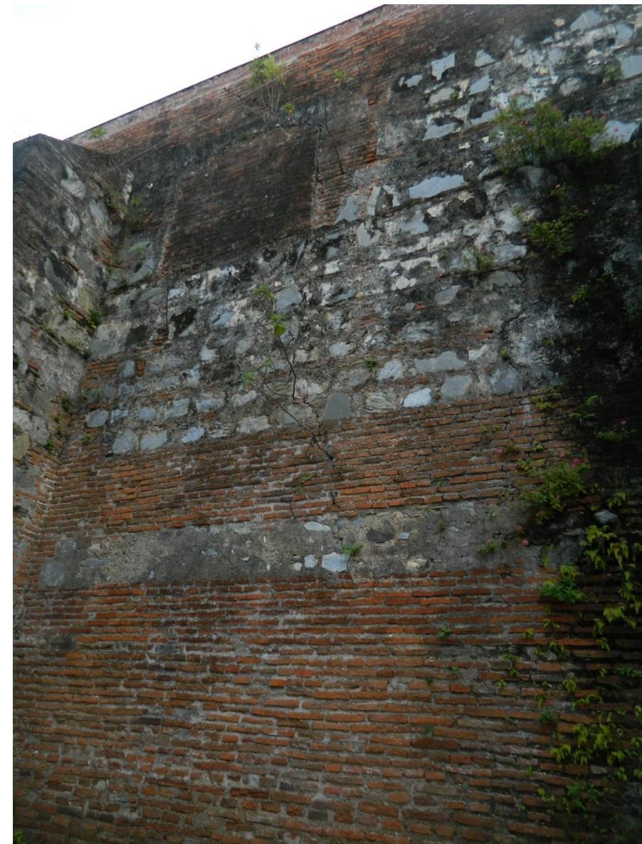
Fig. 26. Grieta en la Iglesia de Santa María Petapa.
