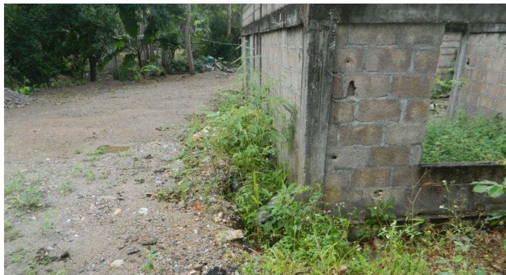
Fig. 37. En El Llano se observa que la crecida de los ríos han sedimentado, por esta razón los ríos se comportan como flujos de lodo. Se observa como poco a poco sepulta una construcción.
