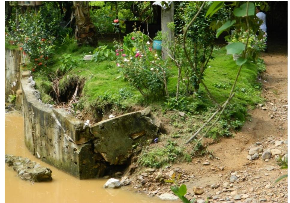
Fig. 41. Reblandecimiento del suelo por erosión fluvial, colapso de la barda de contención del río.
