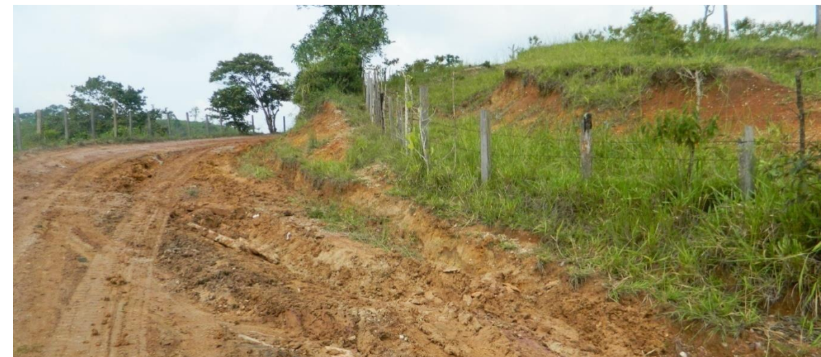
Fig. 31. Deslizamiento del suelo por fuerte erosión pluvial en el camino que conecta a Rancho Nuevo.
