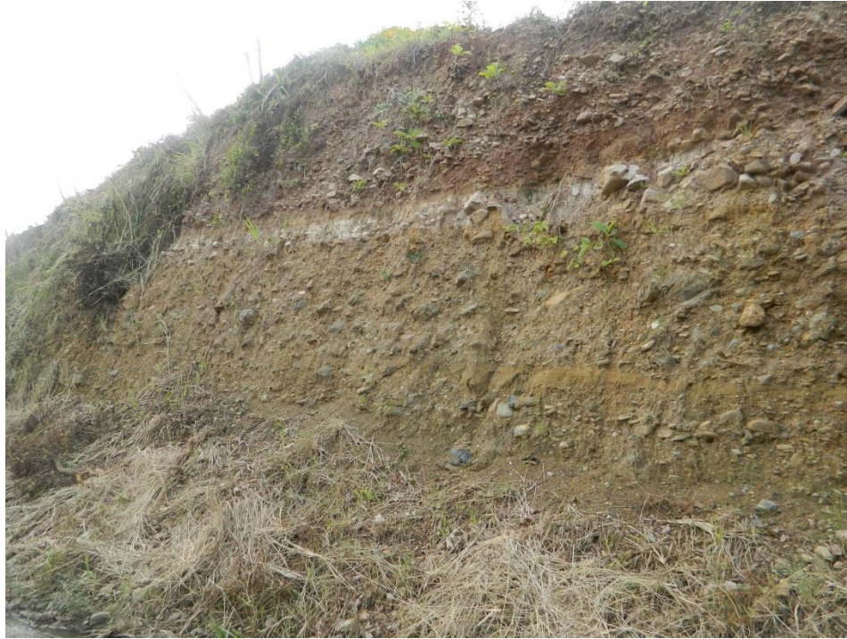
Fig. 34. Carretera hacia El Polvorín, cortes con pendientes cercanas a la vertical, susceptible a la remoción de escombros por caída.
