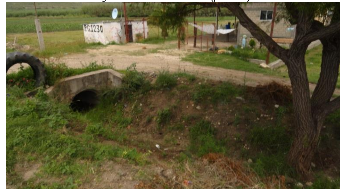
Figura 61. Zona de inundación (punto 11)
