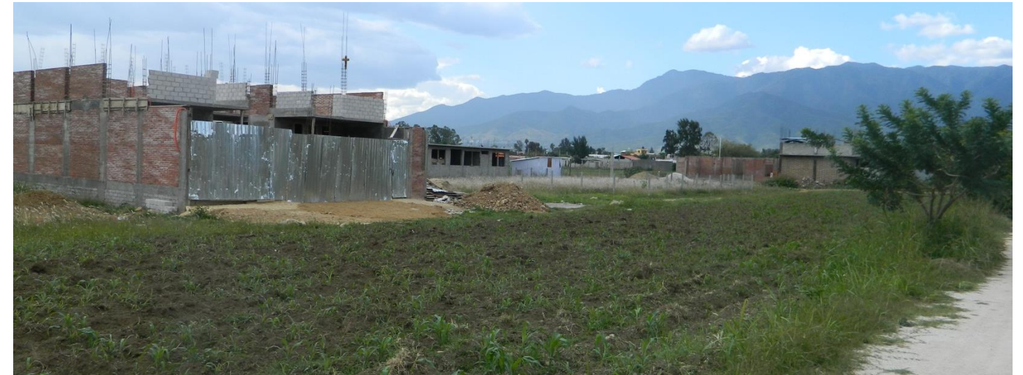
Figura 22Límite de la zona urbana de Santa María del Tule. Se observa que las construcciones tienen pilares y no rebasan el segundo piso. Es importante que se cumplan con las normas de construcción vigentes, ya que el poblado se encuentra en una zona de amplificación de ondas sísmicas.
