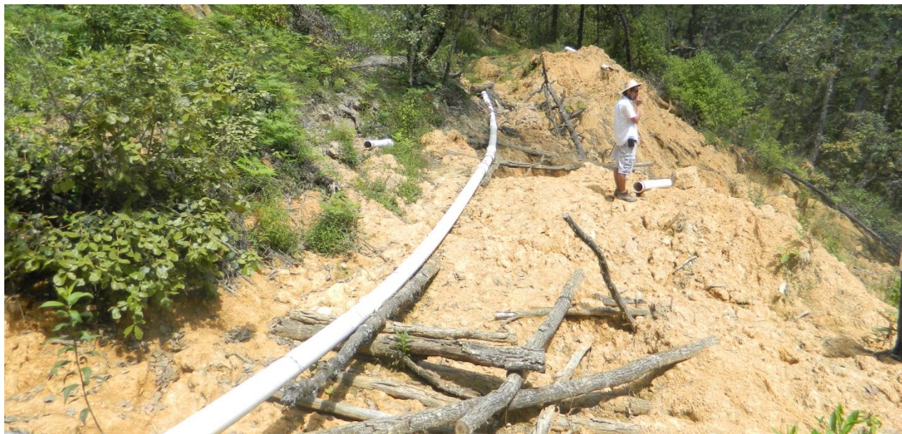
Foto. 9. Zona erosionada en donde inicia el desarrollo de grietas de desplazamiento. Esto puede llevarse el tubo que vierte agua potable a la cabecera municipal.
