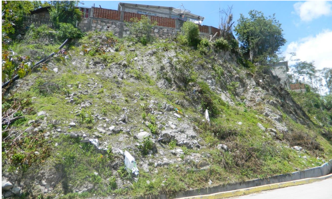
Foto. 8. Zona de deslizamiento potencial (inestabilidad de ladera bajo) en los alrededores de la cabecera municipal. Nótase la construcciones en la parte superior del escarpe. Es importante no permitir el crecimiento en vertical en zonas potenciales a presentar deslizamientos de tierra.
