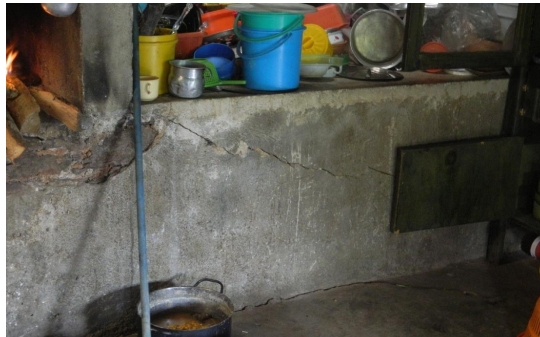
Foto. 13. Grieta en la cocina de una casa localizada sobre la ladera, en el poblado de Santa María Zoogochi, nótese como la grieta a separado la repisa del suelo, además de que la grieta continua por el suelo de la casa.
