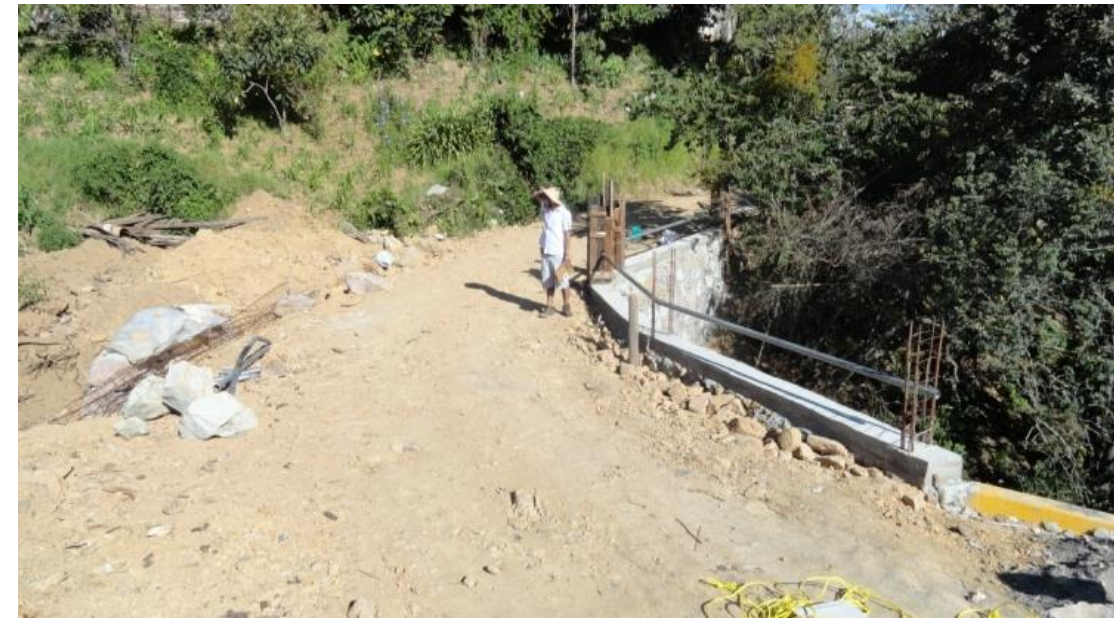
Figura 39. Dique destruido por lluvias.
