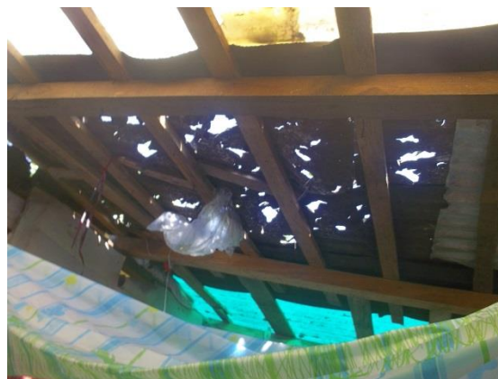
Techos más destruidos.
