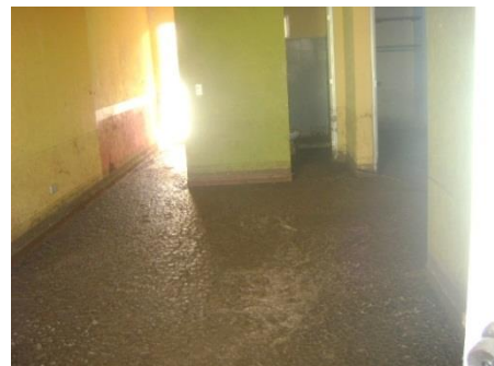
Riesgo Muy Alto
