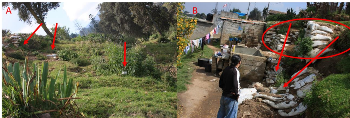
Figura 46. Laderas con pendientes pronunciadas mayores de 35^\circ , en el mes de mayo los pobladores pusieron costales con arena para detener el movimiento y la erosión del suelo. En la foto A, se aprecian costales que se deslizaron por la ladera a consecuencia de las lluvias de los meses de septiembre y en la foto B los costales caídos por acción de la gravedad y movimiento del terreno.
