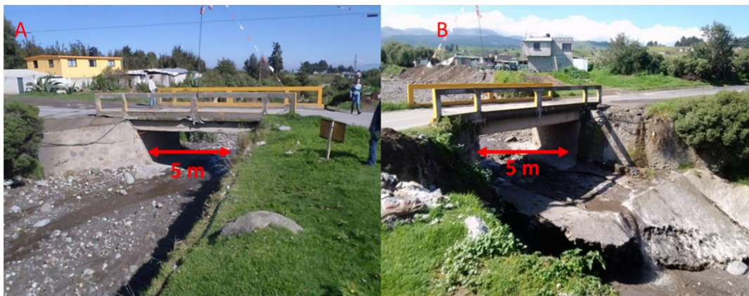
Figura 41. Puente con diámetro menor al caudal del río que en caso de una emergencia será insuficiente para desahogar las grandes cargas de flujos.
