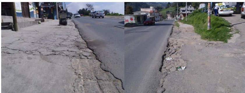
Figura 48. Agrietamientos en las banquetas de la población de Santa María del Monte que pueden afectar los tramos carreteros debido a las fallas y fracturas.
