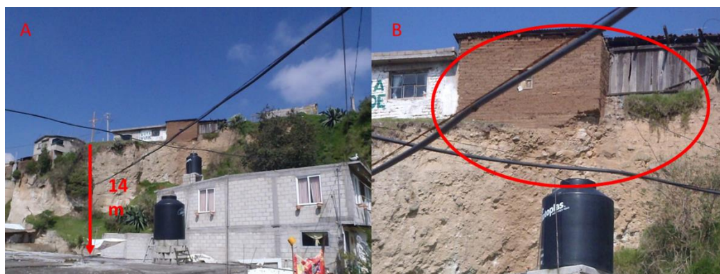
Figura 42. Viviendas ubicadas en Santa María del Monte debajo de un escarpe pronunciado en una ladera con alto grado de peligro, en la foto B se puede apreciar los deslizamientos generados por rellenos de materiales.
