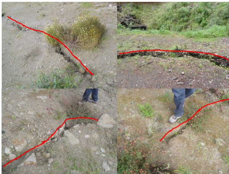
Figura 49. Agrietamientos en el suelo a lado de las carreteras entre los km 23 y 27 del tramo carretero Toluca-Cd Altamirano.
