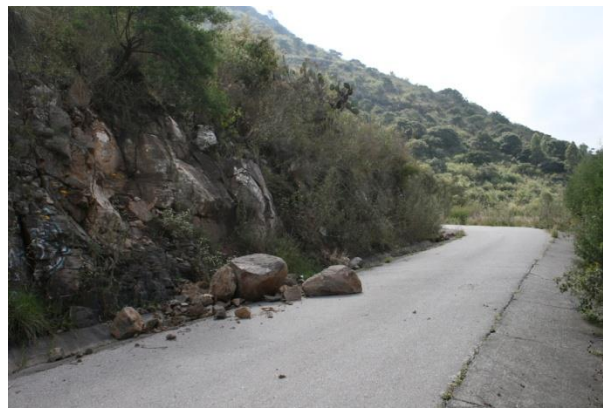
Sierra de Guadalupe: Los cortes realizados en terrenos de alta pendiente ocasionan caídos y derrumbes.
