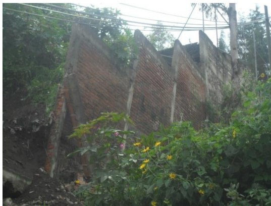
Peligro de deslizamientos de tierra y derrumbes en la Escuela Primaria Isidro Fabela (Colonia San Marcos)
