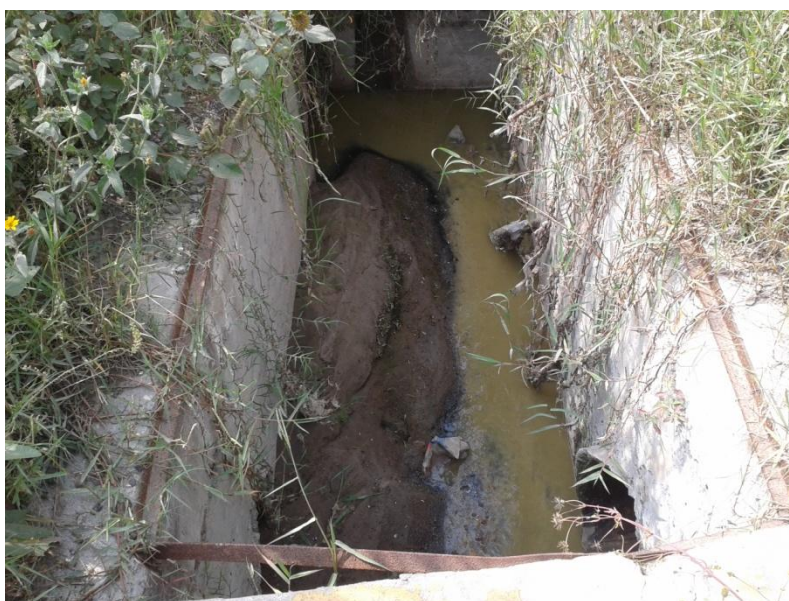
Ilustración 23. Sedimentos acumulados en las coladeras.
