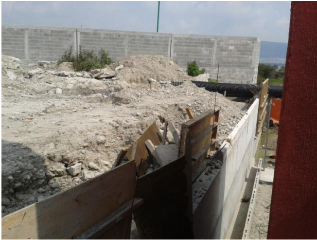
Ilustración 25. Muro destruido por el escurrimiento del agua.
