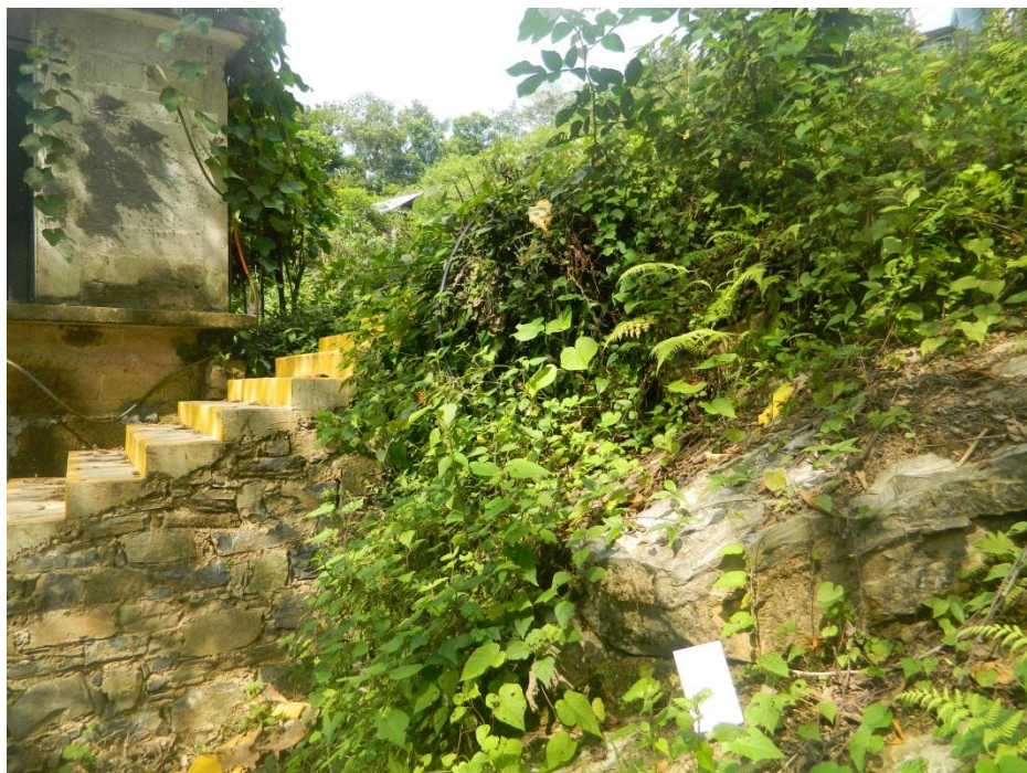
Figura 35. Escalinata que conduce al CDI, nótese como las capas de caliza se encuentra dispuestas de manera paralela a la superficie, lo que favorece la ocurrencia de deslizamientos planares.
