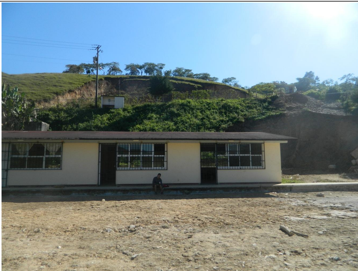
Figura 29. Fotografía del Bachilleres que se emplazo en un antiguo depósito de deslizamiento. Nótese la cicatriz de desprendimiento en la parte superior, y su geometría semicircular, típica de los deslizamientos rotacionales.
