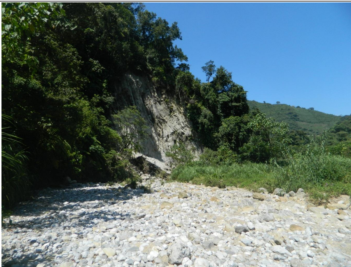
Figura 47. Fotografía del fondo del río de Tehuantepec en donde se observa un escarpe producto de la socavación del río.
