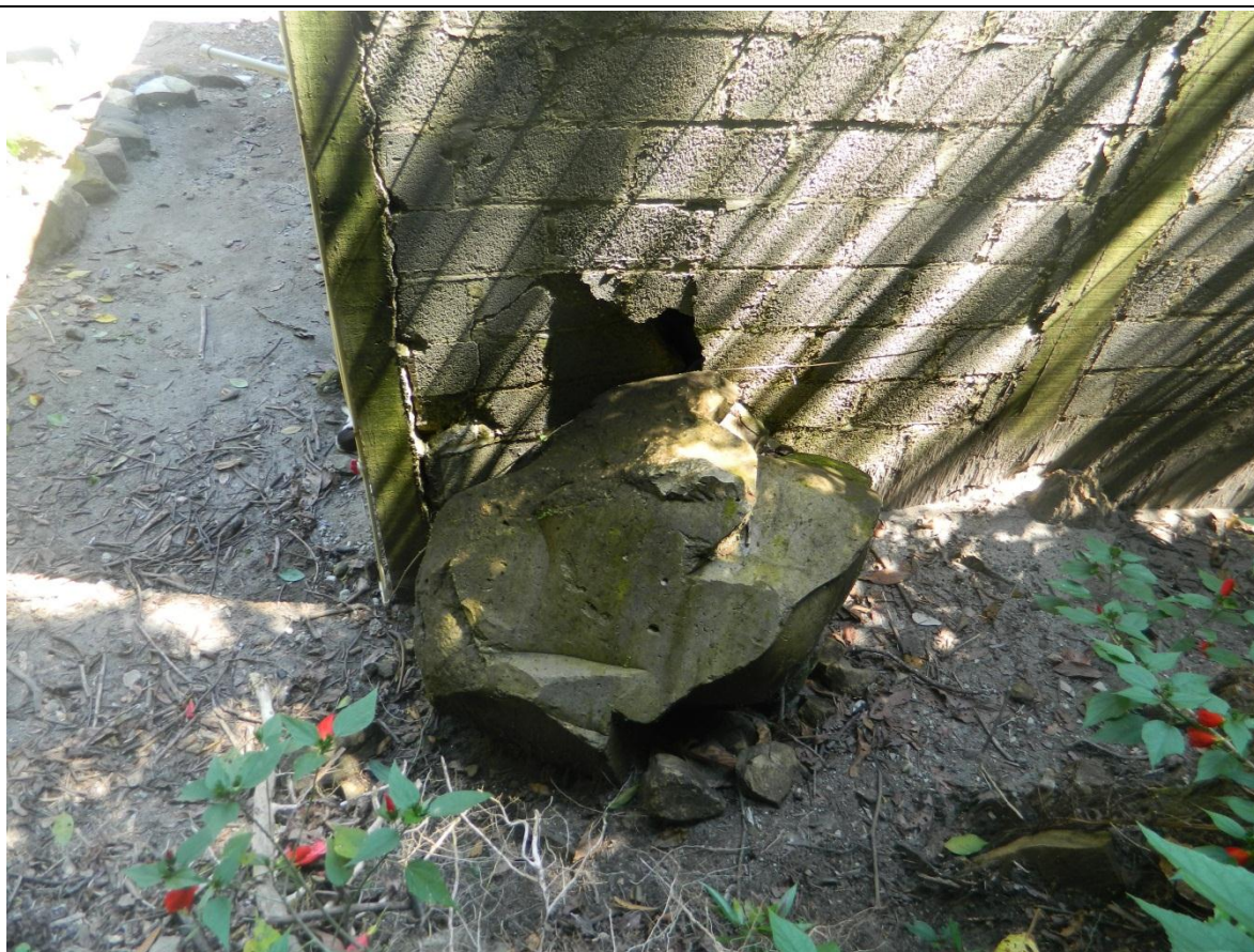
Figura 41. Bloque que impacto la construcción emplazada en una terraza fluvial al sur de la cabecera municipal.
