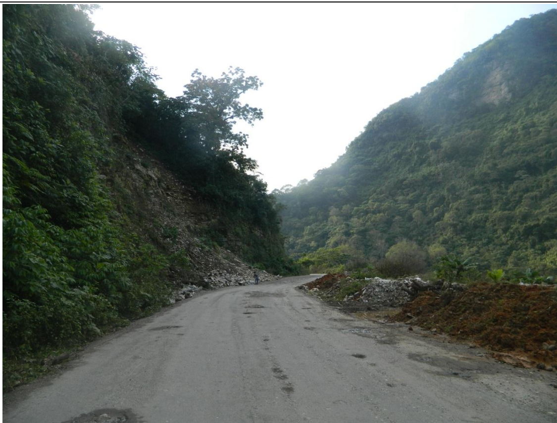
Figura 81. Deslizamiento de ladera que ocupo el camino hacia la cabecera municipal, dirección Jonotla.
