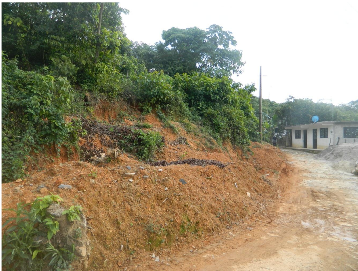
Figura 44. Depósito del deslizamiento de la Fig. 6. Nótese como el material principalmente es detrítico, lo que quiere decir que gran parte de la ladera esta completamente intemperizado, lo que facilita la infiltración. También es importante señalar que este depósito cubrió el camino (derecha de la foto) y ocurrió en la época de lluvias de este año (julio 2012). Es importante mencionar que por debajo de este camino se encuentra una escuela, por lo que la susceptibilidad de ser sepultada por un deslizamiento es muy alta.
