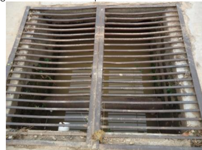
Figura 69. Alcantarilla tapada en la colonia Las Flores
