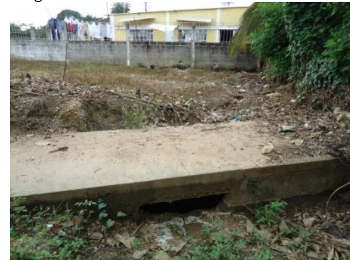
Figura 73. Alcantarilla en malas condiciones
