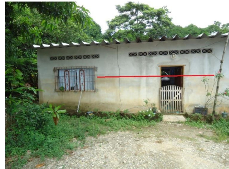
Figura 52. Nivel del agua durante la crecida de 2010, (1.70m aprox de altura del nivel del piso)
