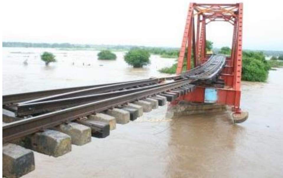
Figura 41. Puente Cujuliapan dañado por los fuertes flujos pluviales. Inundación causada por Huracán Carlota
