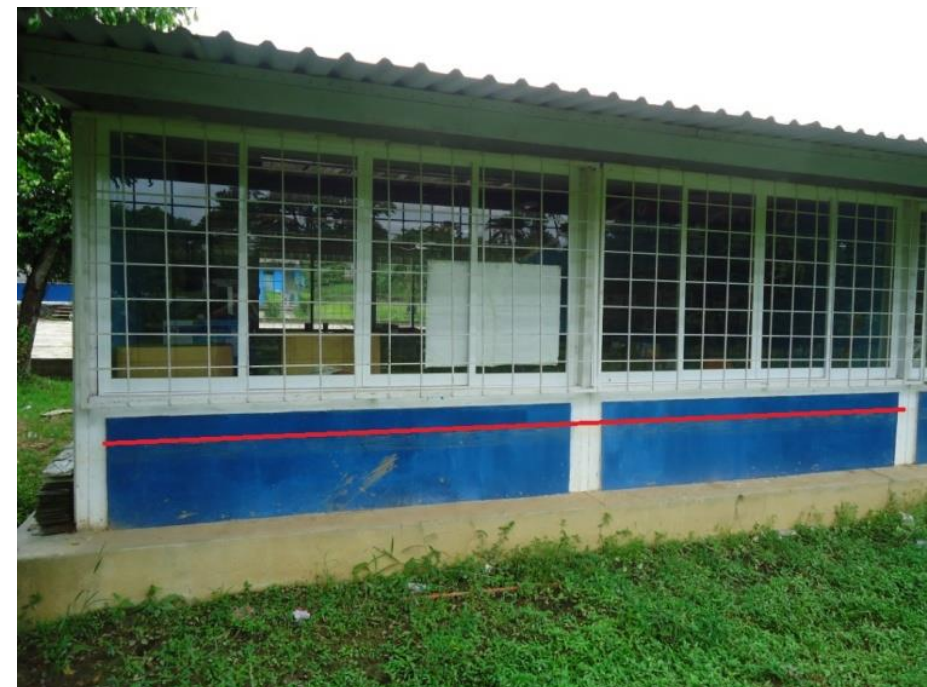
Figura 46. Nivel de la inundación en una de las paredes de un aula de la escuela Primaria Nicolás Bravo en la localidad Mixtán.
