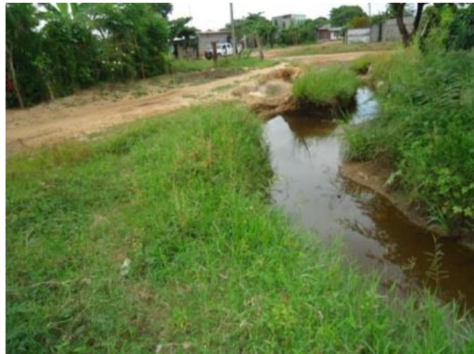
Figura 74. Canal de la colonia Libertad en malas condiciones.
