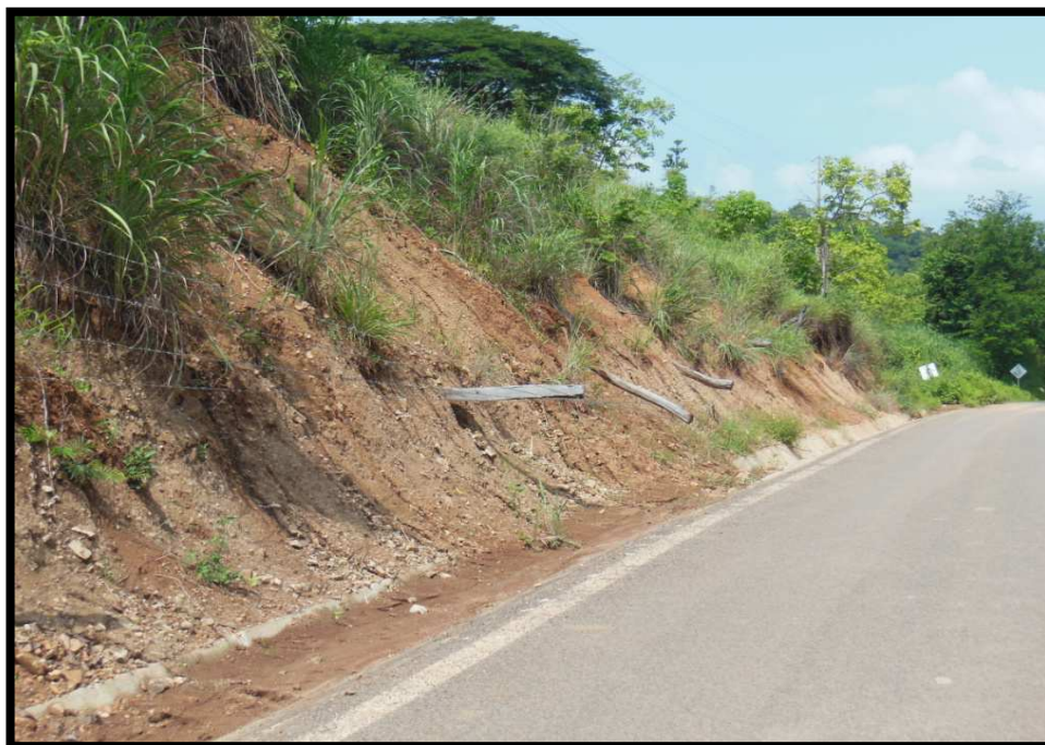
Imagen 61. Se muestran derrumbes de suelo sobre la carretera que va hacia la localidad El Veladero de Camotlán.
