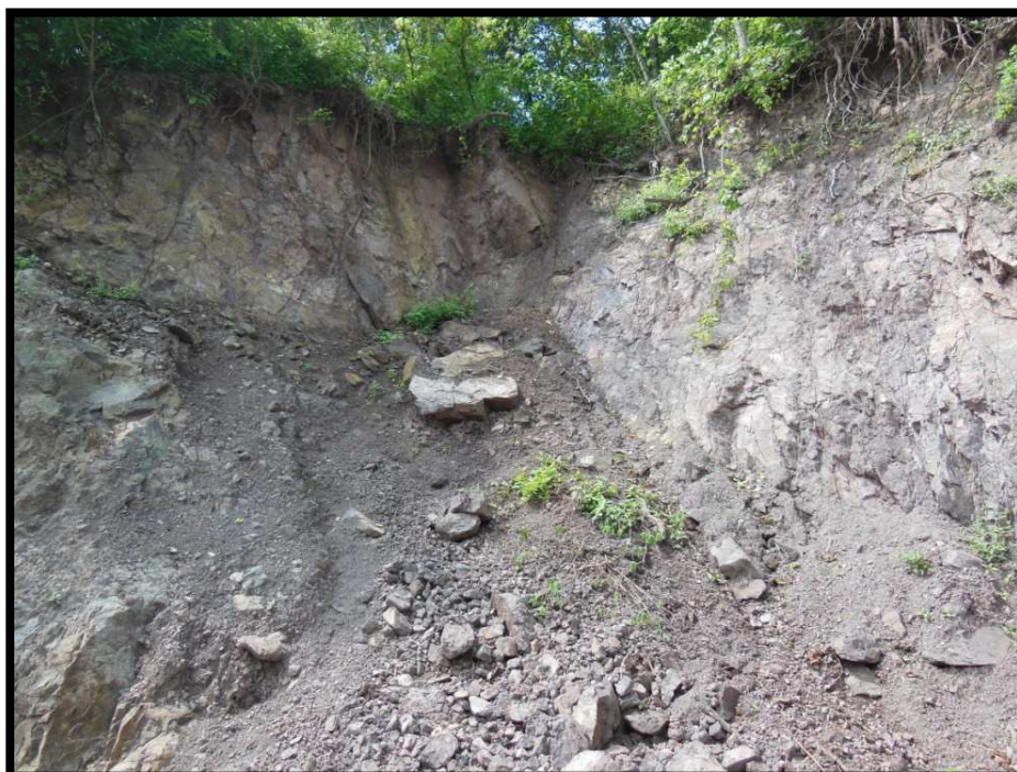
Imagen 60. Sobre el Camino al Veladero de Camotlán se localizan zonas con peligro de derrumbes.
