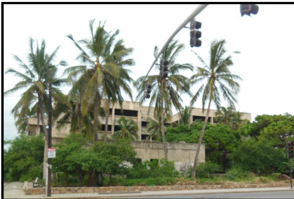
Imagen 3. El Hospital del IMSS ubicado sobre el Blvd. Miguel de la Lamadrid con daños estructurales por el sismo del 8 de octubre de 1995 (Mw=8) uno de los pocos edificios dañados severamente por el sismo que aún queda en pie. Fuente: propia
