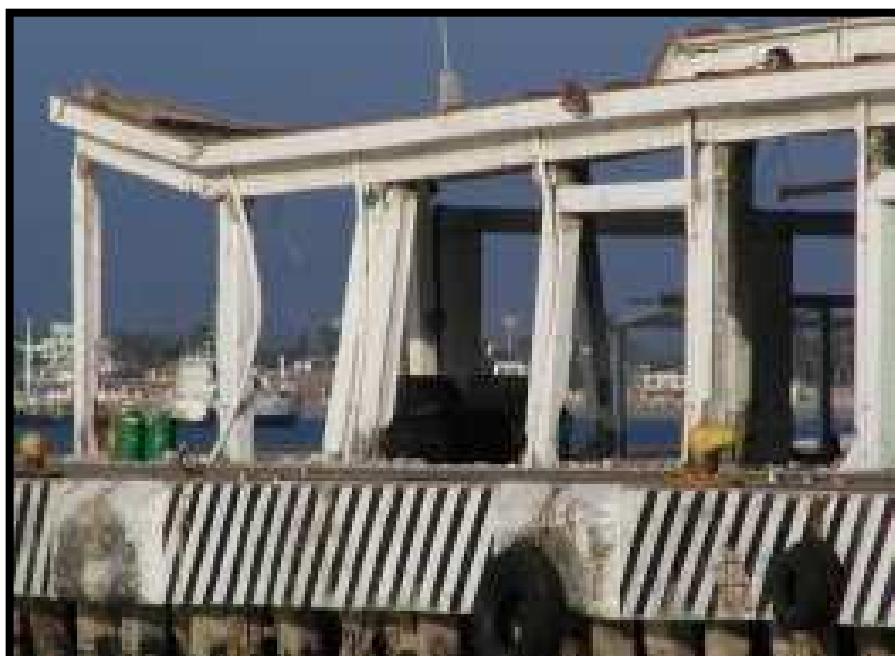
Imagen 7. Daños estructurales al desaparecido muelle fiscal de la zona portuaria. Fuente: CENAPRED.
