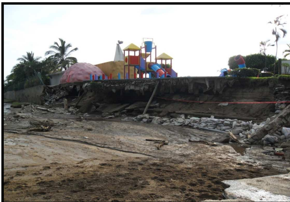
Imagen 113. Daños generados por socavamiento del Arroyo Chandíablo a la altura del Country Club. A causa del huracán "Jova" en 2011.
