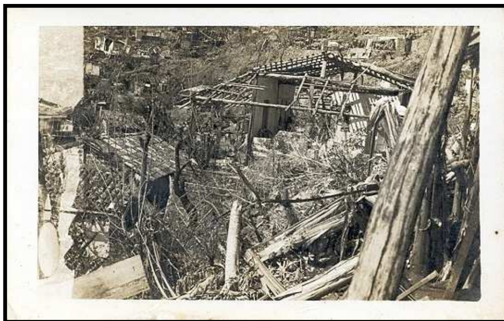
Imagen 94. Se observan los daños ocasionados sobre viviendas construidas con materiales frágiles del municipio, por la fuerza de los vientos del huracán de 1959. Fuente: archivo fotográfico del INPLAN.
