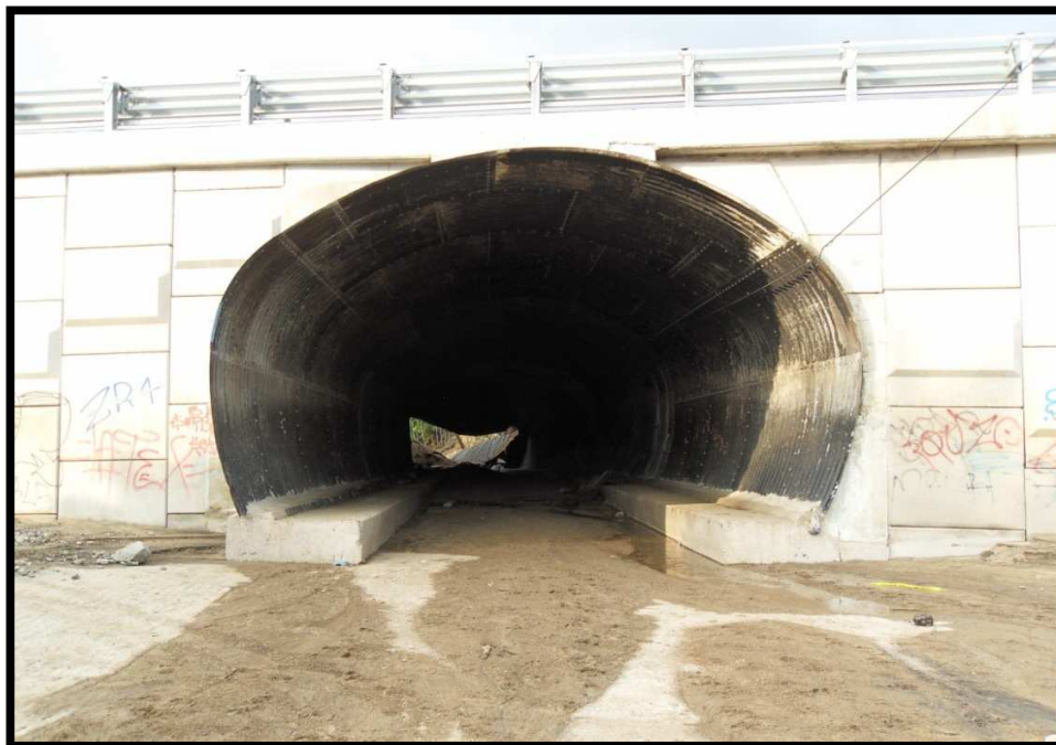
Imagen 112. Se observa restos del azolvamiento por flujos de lodos sobre alcantarillas a lo largo del libramiento Manzanillo-Cihuatlán. A causa del huracán "Jova" en 2011.
