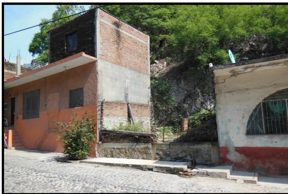
Imagen 42. Colonia el Rocio. Se muestran asentamientos en áreas potenciales de deslizamientos.
