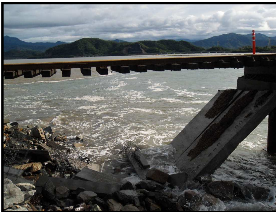
Imagen 109. Se observan otra vista de los daños ocasionados a puente del F.F.C.C. sobre la laguna de Cuyutlán, a causa del huracán "Jova" en 2011.
