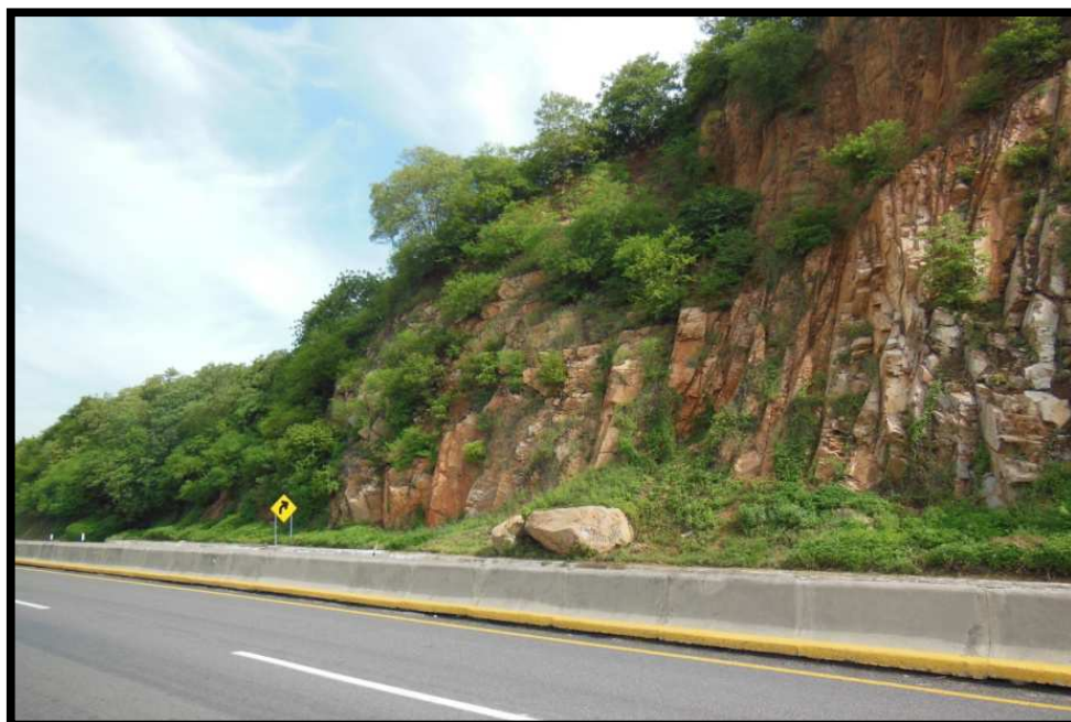
Imagen 53. Zona susceptible de derrumbes o caída de rocas en la Autopista Manzanillo - Colima en la altura de la Laguna de Cuyutlán. En este punto se observa evidencia de derrumbes de roca sobre la autopista.
