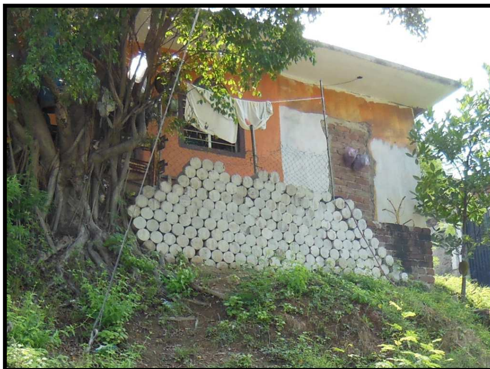
Imagen 43. Colonia el Rocío. Asentamiento con muros de contención para prevenir deslizamientos.
