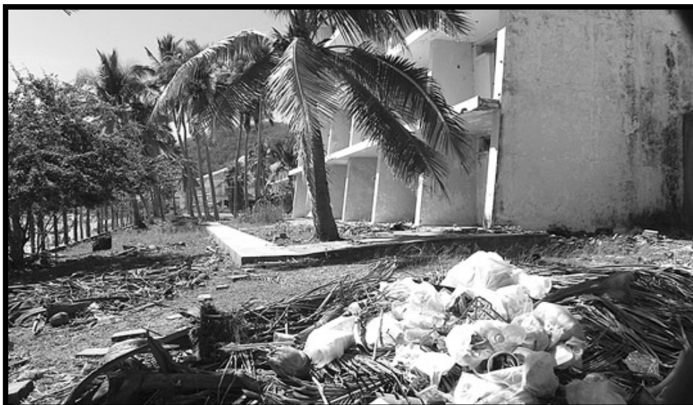
Imagen 1. Daños estructurales a fincas en la zona costera de Manzanillo por el sismo del 8 de octubre de 1995 (M=8) Fuente: Archivo Fotográfico del INPLAN.
