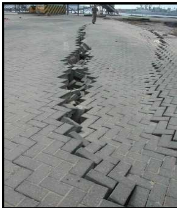
Imagen 6. Evidencias de licuación de suelos sobre las instalaciones del puerto de Manzanillo, debida al sismo de 2003 (Mw=7.6) Fuente: CENAPRED.
