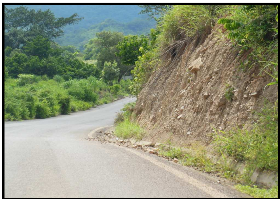
Imagen 62. Camino a San José de Lúmbler. Se encuentran zonas con peligro de derrumbes, caída de suelo y rocas.
