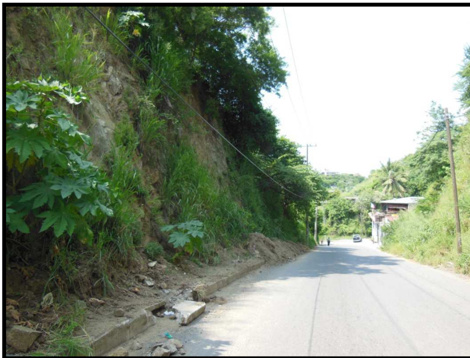
Imagen 51. En la imagen se muestra derrumbes sobre la Avenida Miguel de la Madrid de la Colonia de la Cruz.
