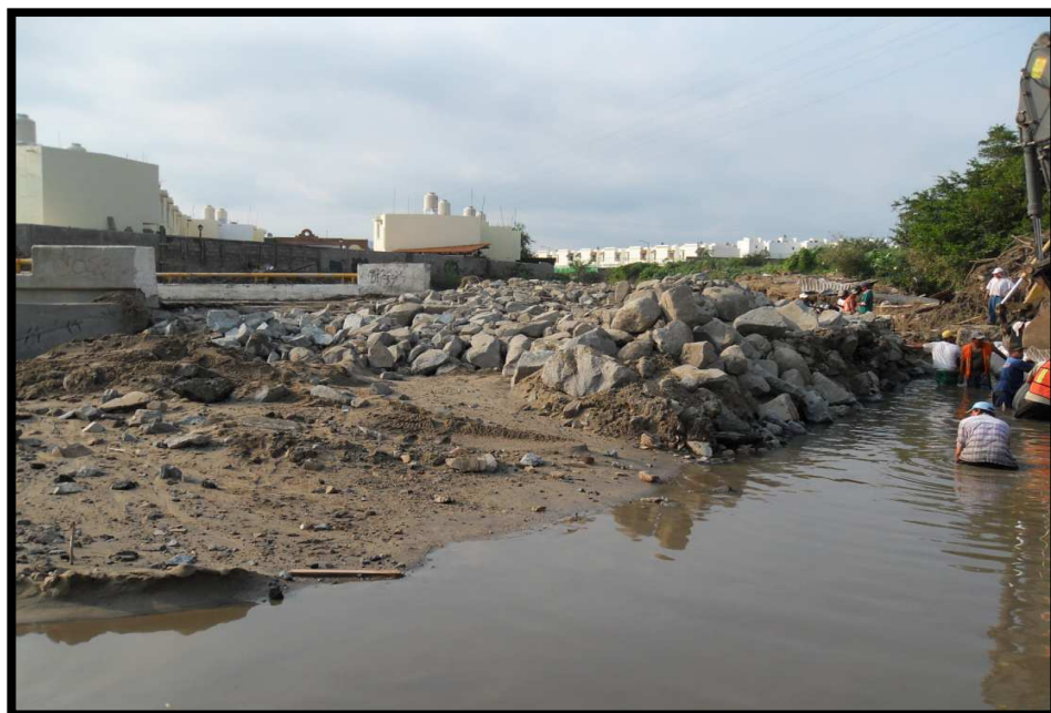
Imagen 114. Daños generados por los flujos de lodo sobre el arroyo Chandíablo a la altura del fraccionamiento "La Floresta". A causa del huracán "Jova" en 2011.
