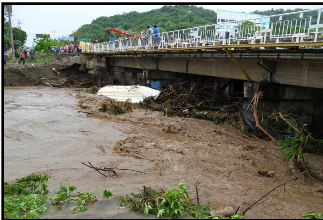
Imagen 123. Daños ocasionados por la crecida del Arroyo Chandiablo a la altura del puente Santiago, sobre el Boulevard Miguel de la Madrid.
