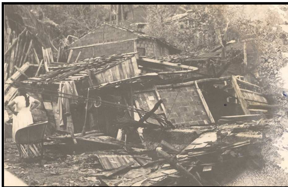
Imagen 93. Se observan los daños ocasionados sobre viviendas construidas con materiales frágiles del municipio, por la fuerza de los vientos del huracán de 1959. Fuente: archivo fotográfico del INPLAN.
