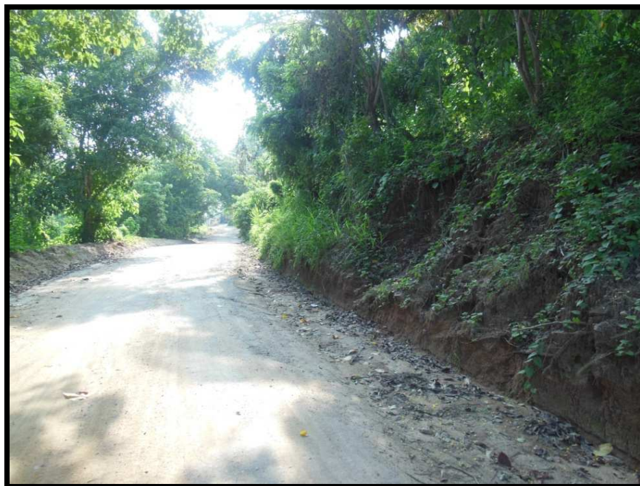
Imagen 52. Sobre el camino hacia la localidad El Charco se localizan áreas de deslizamiento.
