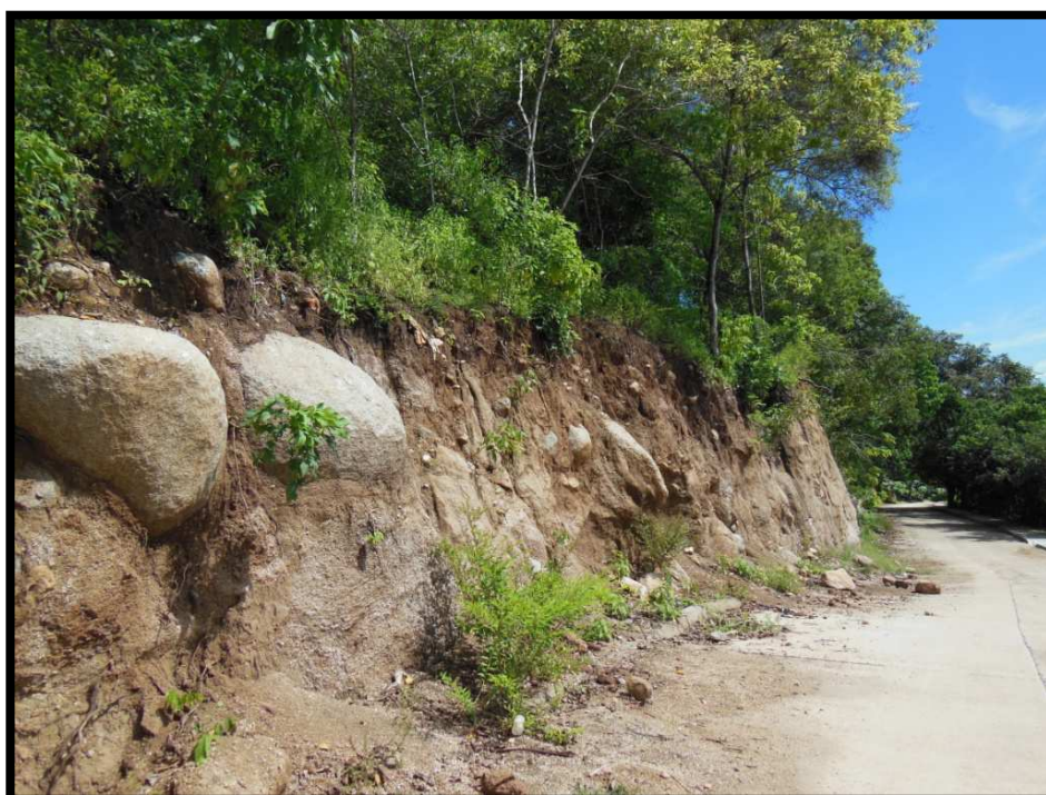
Imagen 70. Zona de derrumbes sobre el camino hacia la localidad de Chandiablo.
