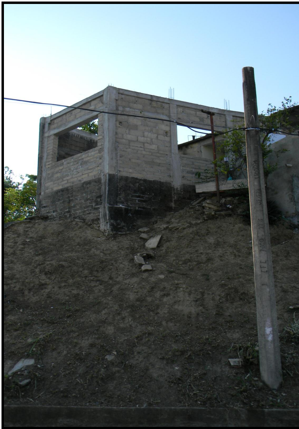
Figura 12.- Casa en construcción sobre un lomerío, en peligro de deslave Colonia Lázaro Cárdenas de la Cabecera Municipal.
