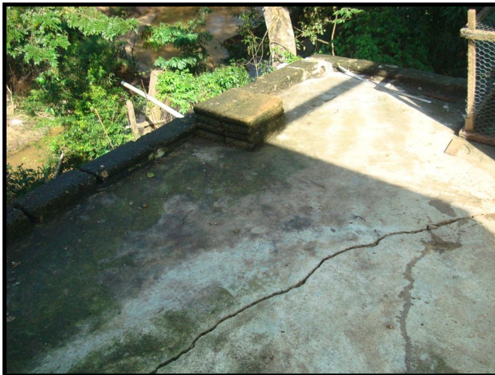
Figura 51. Agrietamiento de concreto del patio de una vivienda provocado por erosión hídrica. Fuente: Protección Civil Municipal.
