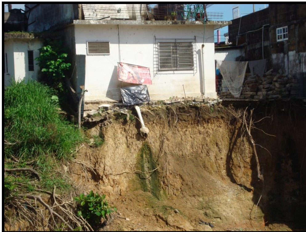
Figura 53. Vivienda en riesgo por deslave en la Cabecera Municipal.
