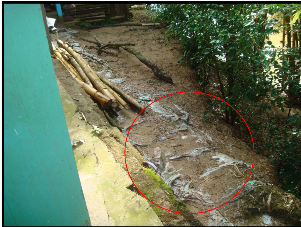
Figura 40. Muros de contención improvisados por habitantes debido a erosión hídrica en la colonia Kilómetro 2.5.
