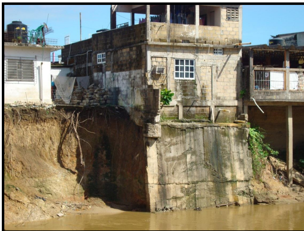
Figura 53. Muros de contención sobre río Agua Dulce.
