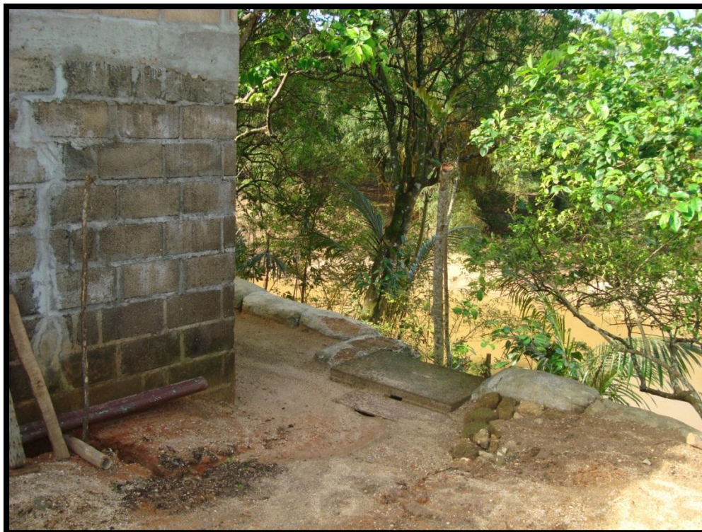
Figura 47. Vivienda en riesgo por desbordamiento de río Agua Dulce.
