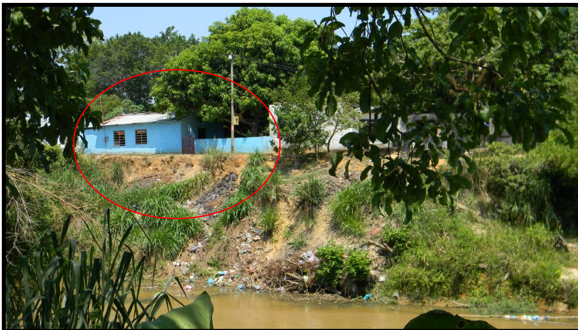
Figura 3.- Viviendas (otro lado del río, en la colonia Nueva Del Río) con peligro de deslavarse.
