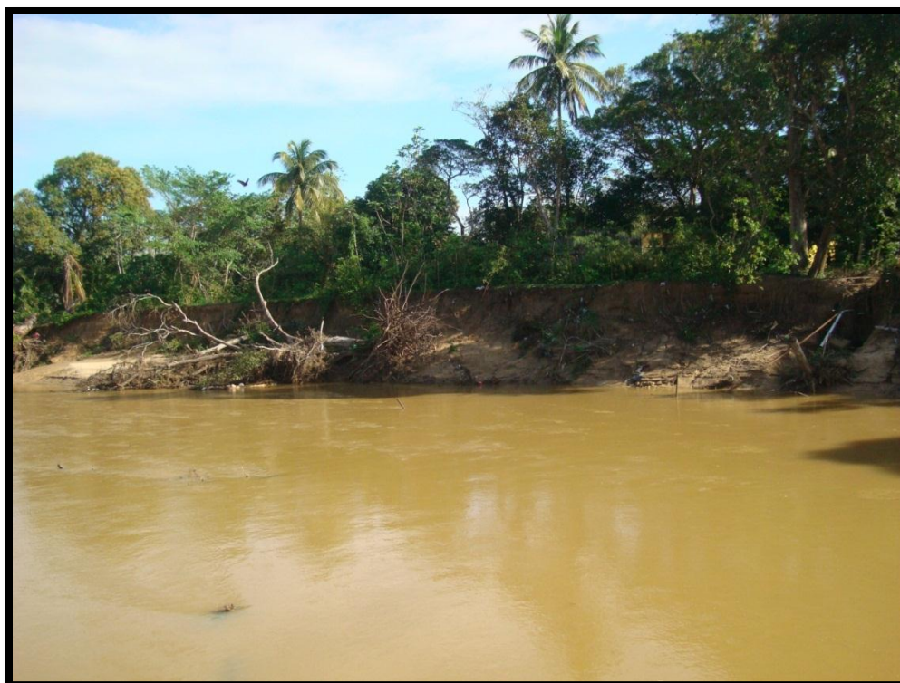
Figura 44. Erosión laminar del río Agua Dulce. Fuente: Protección Civil Municipal.
