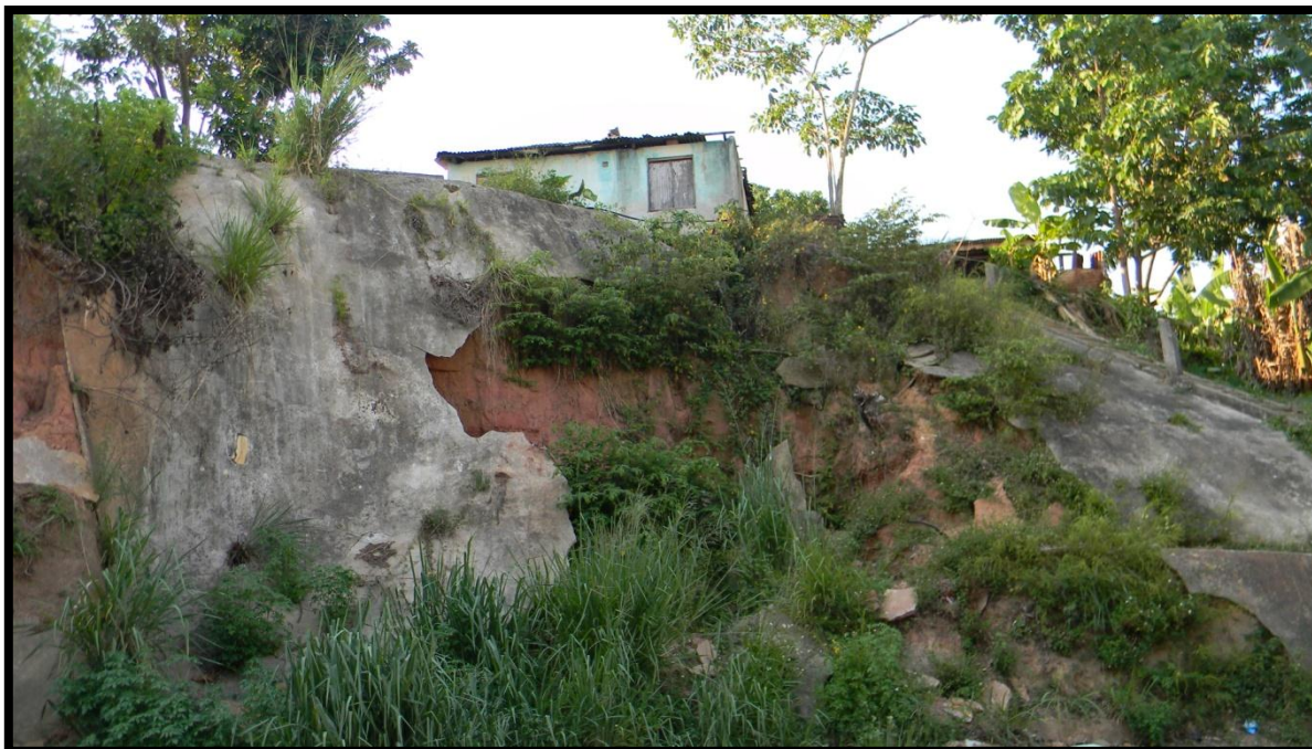
Figura 8.- Se identificó ladera con capa delgada de cemento (desgastado), dos casas en riesgo en la Colonia Emiliano Zapata de la Cabecera Municipal.
