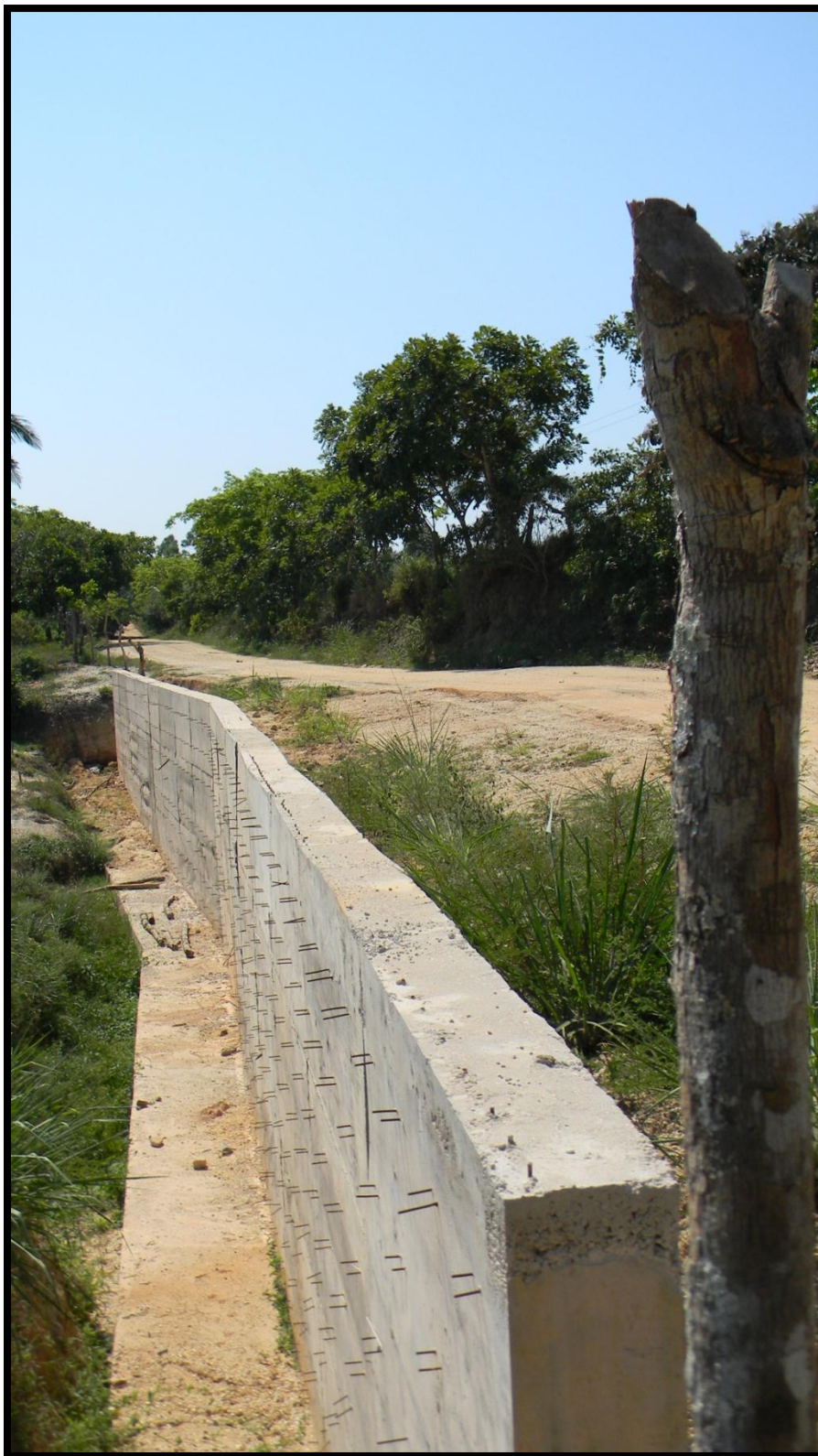
Figura 5.- Muro de contención, actualmente se inunda en localidad Los Soldados.
