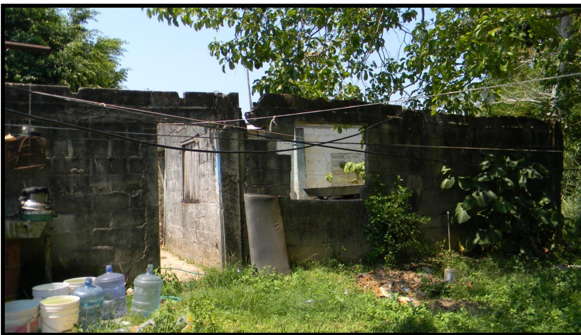
Figura 2.- Casa deshabitada debido a deslave en la Colonia Cuatro Camino de la Cabecera Municipal.
