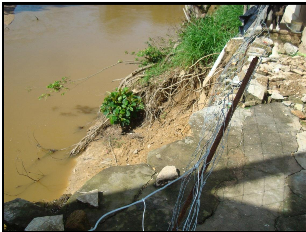
Figura 54. Concreto agrietado debido a erosión hídrica en la Cabecera Municipal. Fuente: Protección Civil Municipal.
