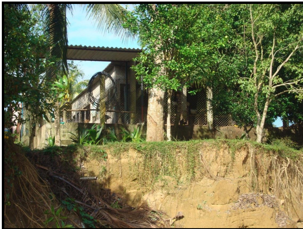
Figura 45. Vivienda en riesgo por deslave en la Colonia Cuatro Caminos. Fuente: Protección Civil Municipal.
