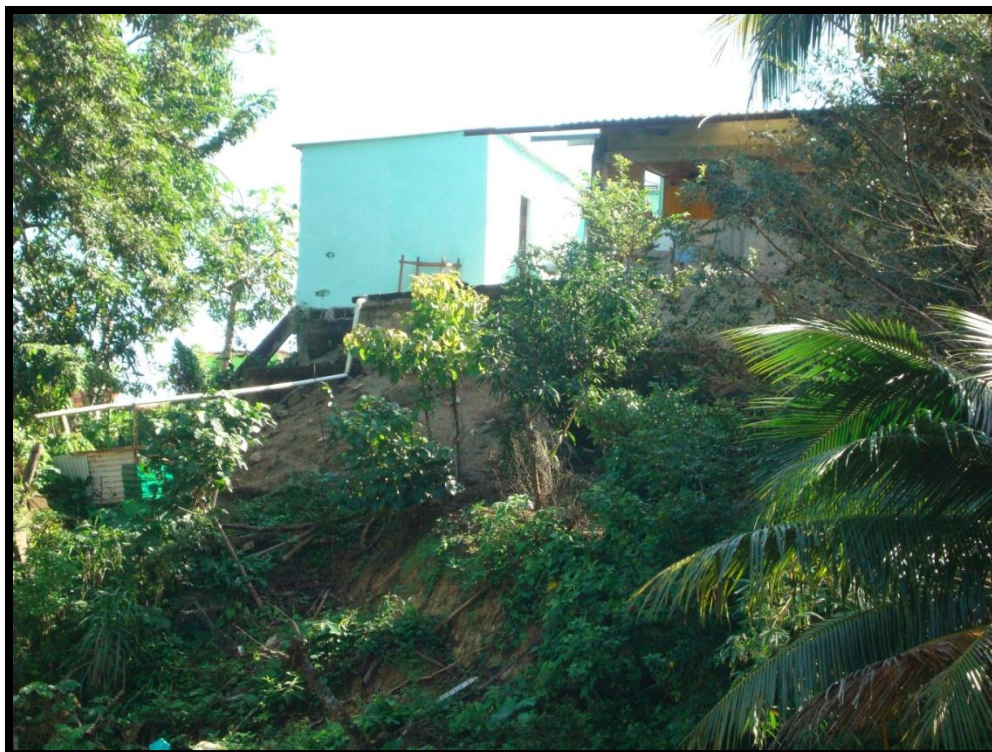
Figura 54. Vivienda en riesgo por erosión laminar del río Agua Dulce en la colonia Nueva del Río.
