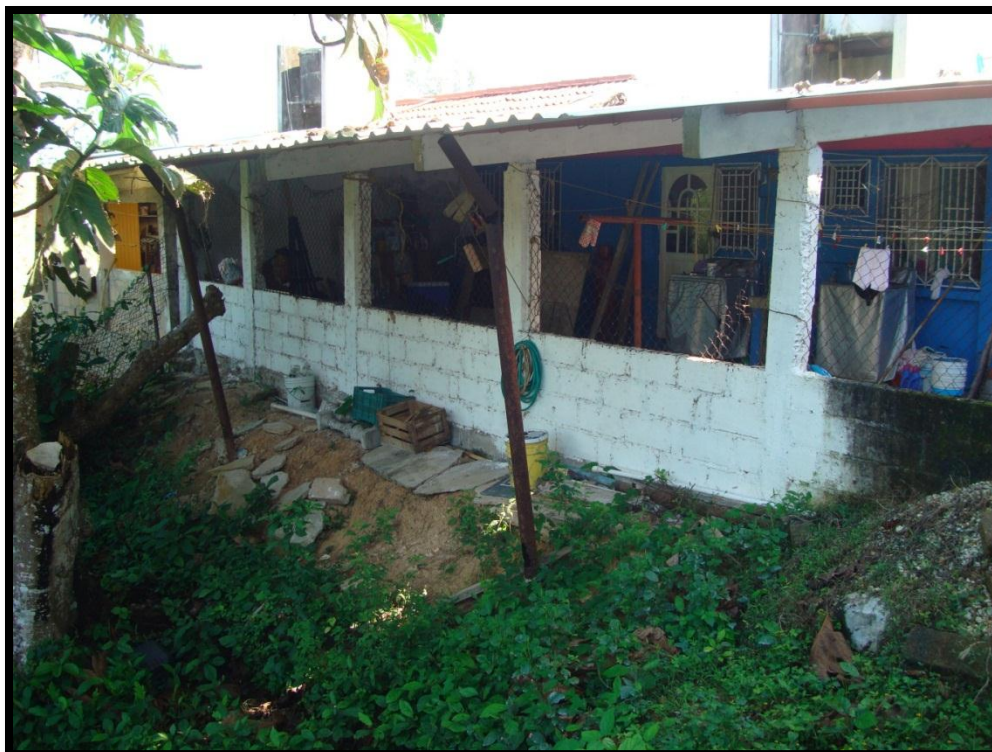
Figura 52. Vivienda en riesgo por deslave. Fuente: Protección Civil Municipal.
