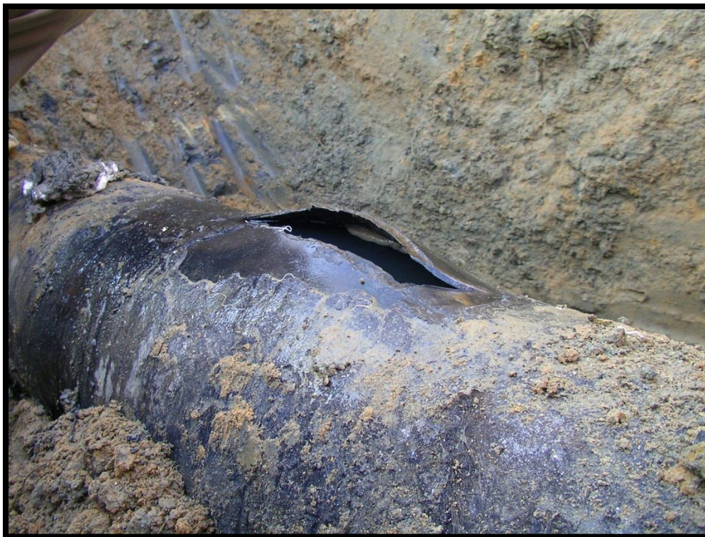
Fotografía 5.2. Ruptura de Gasolinoducto a la altura de la localidad Kilómetro 25.
