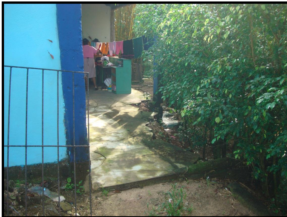
Figura 39. Vivienda afectada por erosión hídrica en la colonia Kilómetro 2.5 Fuente: Protección Civil Municipal.
