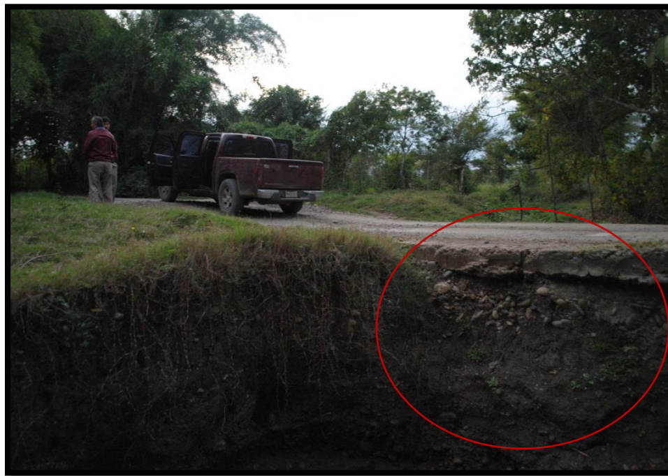
Figura 18. Puente dañado por erosión lineal. Tramo hacia la localidad Potrero de Brasil.
