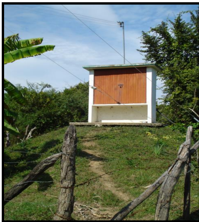
Figura 9. Estación de Bombeo, en la localidad Alto de Vega Rica.
