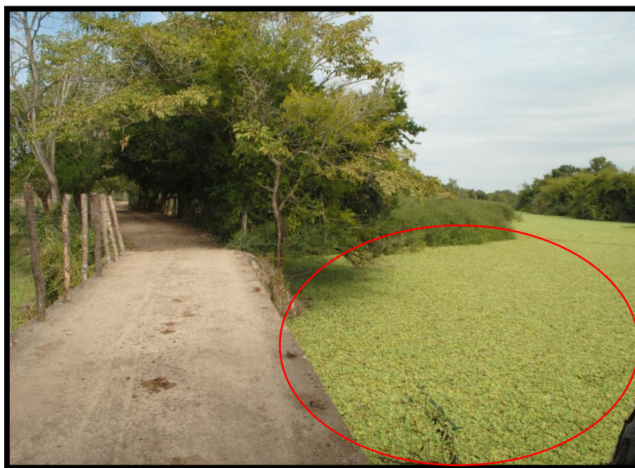
Figura 6. Afectaciones por inundación al puente Ejido Alto del Pato, se observa eutrofización de cuerpo de agua.
