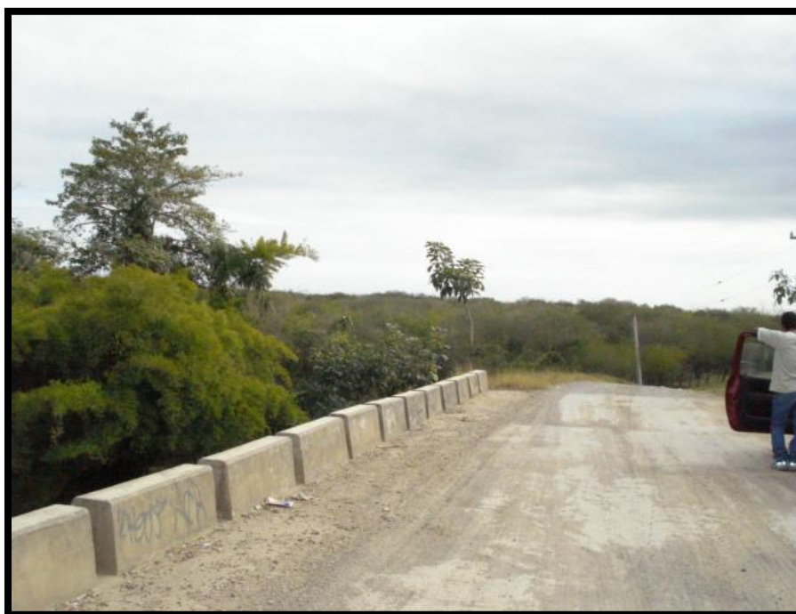
Figura 47. Zona inundable en puente camino hacia Alto de Vega Rica..
