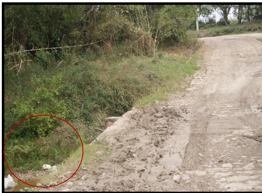
Figura 62. Zona de inundación por desbordamiento de corriente intermitente comunicando a localidades aledañas, camino Arroyo Hondo – Santa Magdalena. Se observan cárcavas de erosión.
