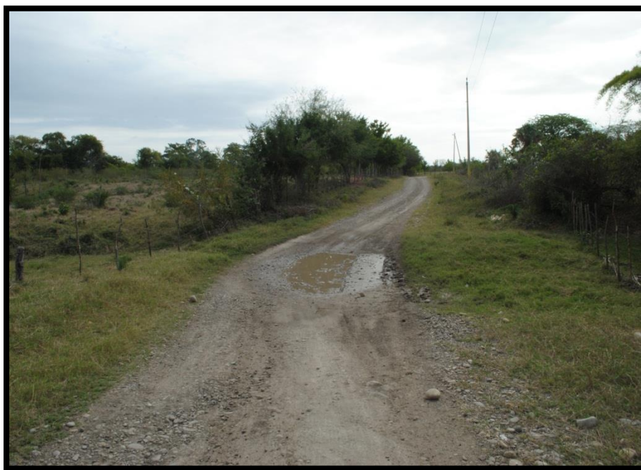
Figura 31. Zona de escurrimiento pluvial, en temporada de lluvia afecta el camino de Arroyo Canchey - El Sancudo.
