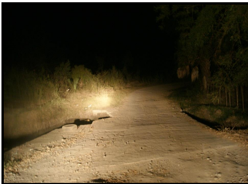
Figura 70. Vía de comunicación afectada por el desbordamiento del Arroyo El Barbecho.
