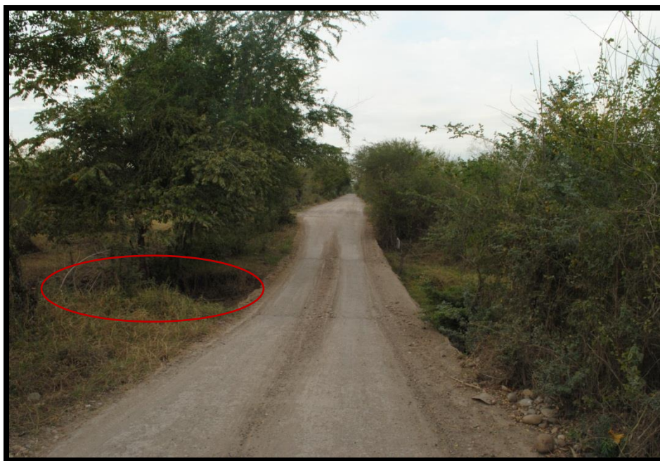
Figura 37. Escurrimiento superficial intermitente que incomunica a la población en temporada de lluvias. Camino El Barranco – El Jobo.
