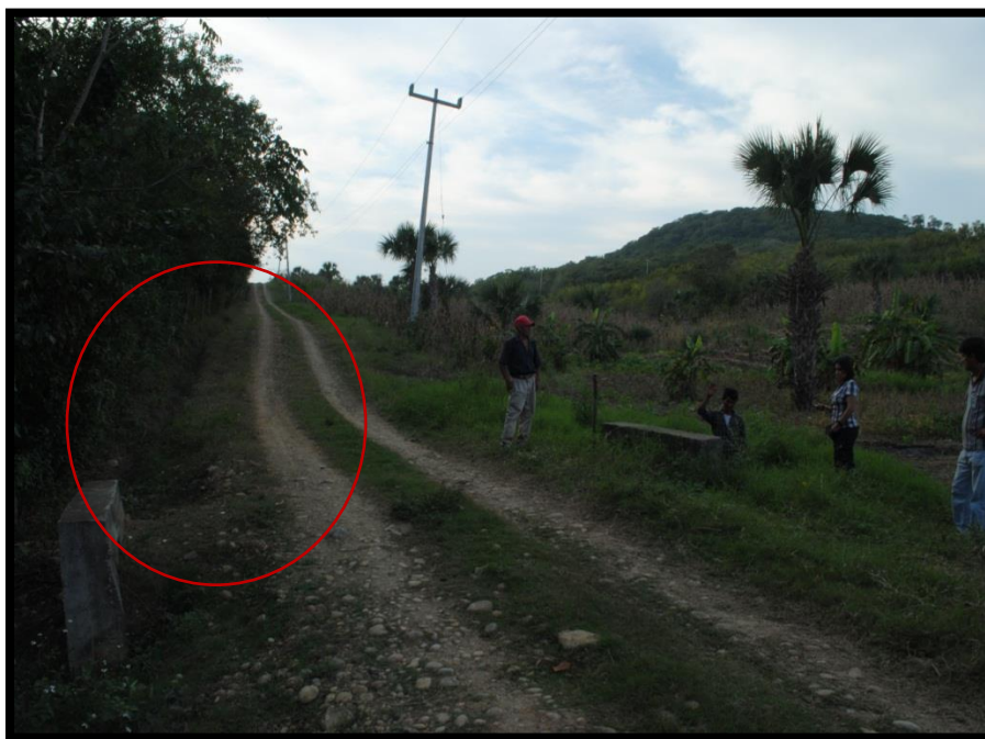
Figura 24. Afectación en vías de comunicación por inundación y socavamiento. Presencia de erosión hídrica, localidad Los Manantiales.
