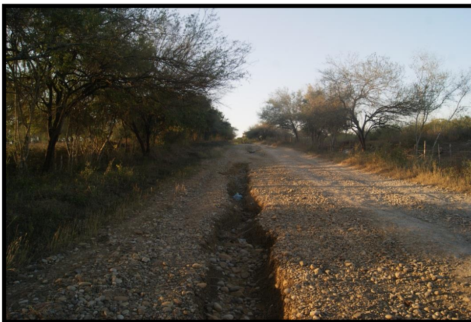
Figura 56. Presencia de erosión lineal que afecta la vialidad, localidad Corozal.
