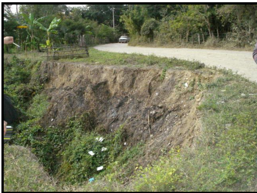
Figura 49. Deslave provocado por la erosión lineal del río Temporal, localidad El Ranchito.
