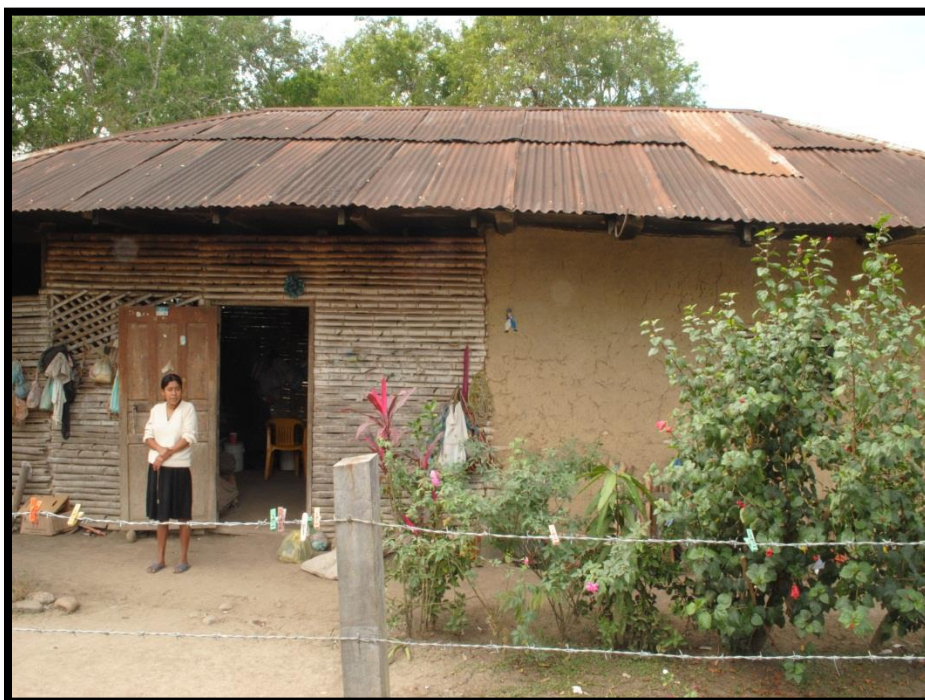
Figura 5. Vivienda afectada por inundación debido al desbordamiento del río Tempoal, ejido Alto del Pato.
