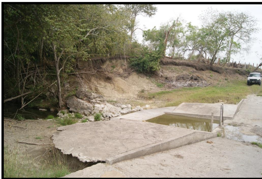
Figura 57. Presa instalada para abastecimiento de agua en Arroyo Los Tronconales, localidad El Tronconal.
