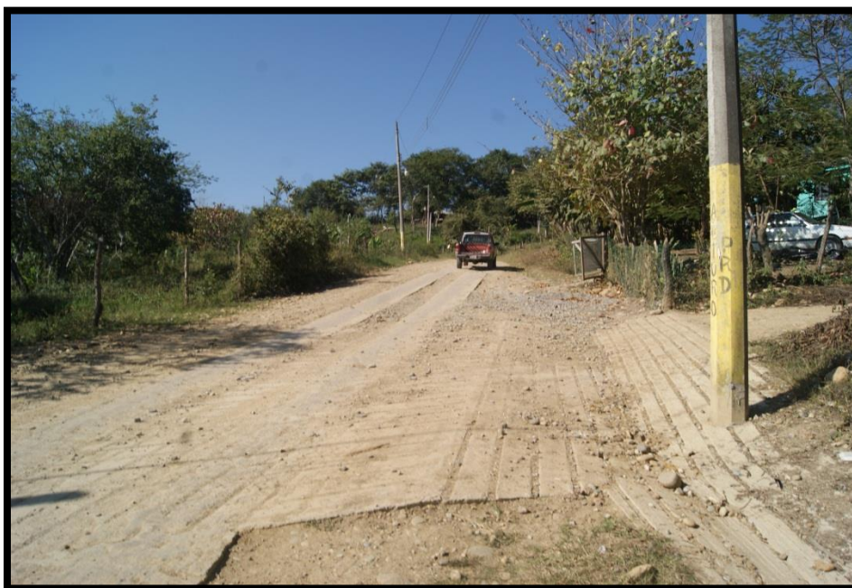
Figura 60. Afectaciones a vialidades por arrastre y depósito de sedimento, localidad Santa Fe.
