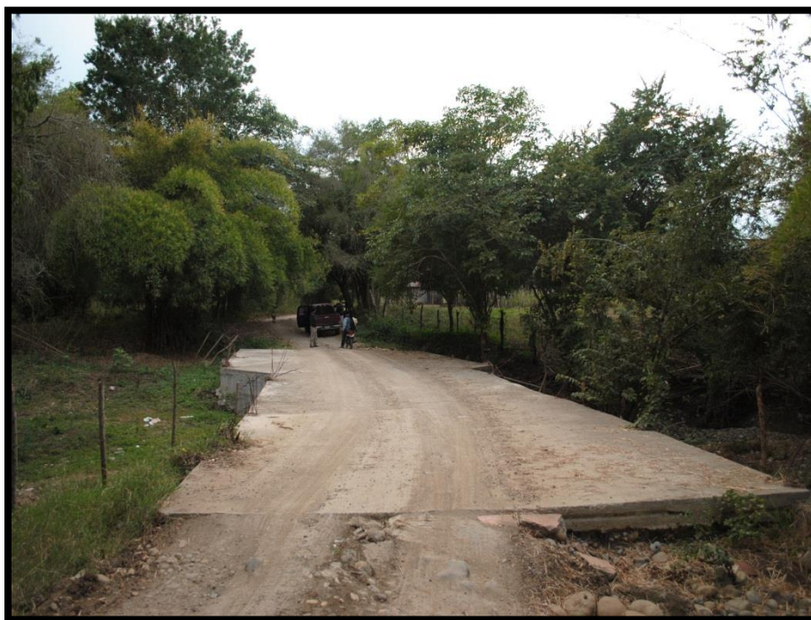
Figura 38. Puente dañado por corriente intermitente, se ha construido en varias ocasiones, camino Las Mesas – Potrero de Brasil.
