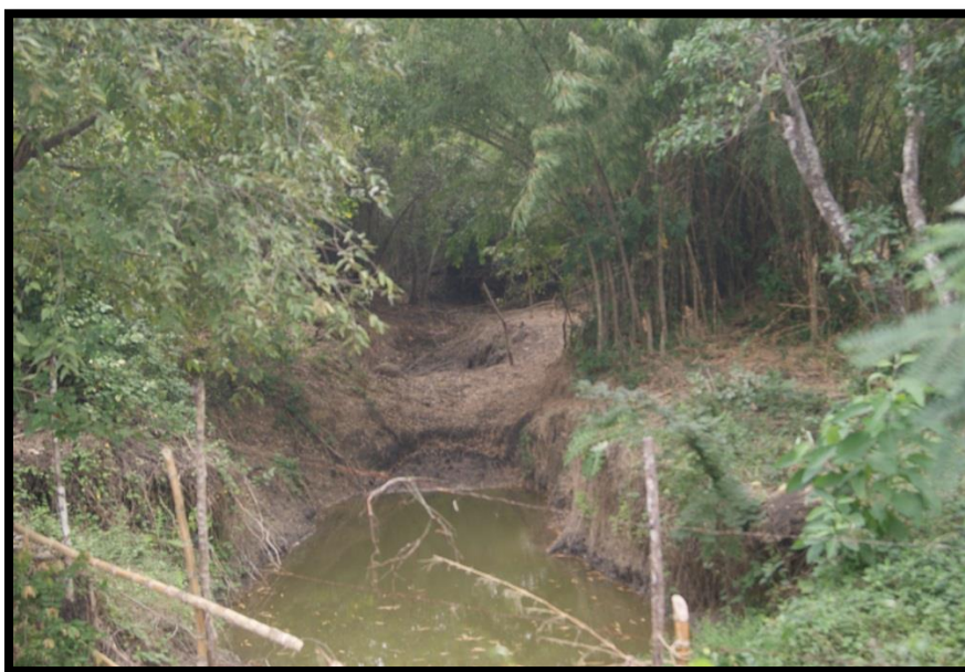
Figura 63. Anegamiento de aguas pluviales, camino Arroyo Hondo – Santa Magdalena.
