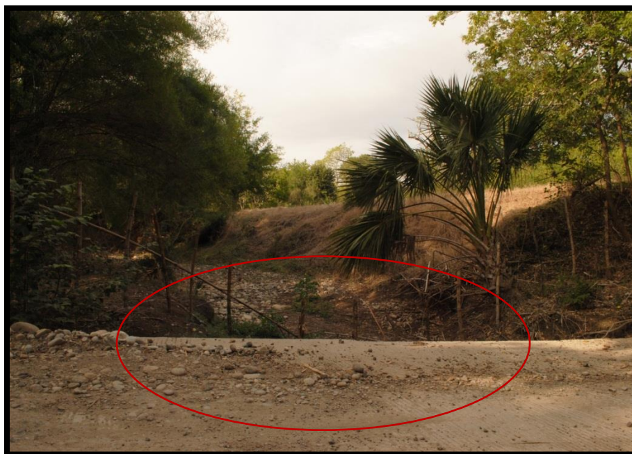
Figura 32. Puente afectado por corriente intermitente, sedimentos y erosión hídrica. Camino Arroyo Canchey – El Hule.
