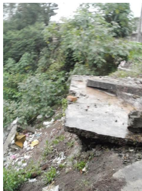
***Construcción dañada, donde se observa el relleno invasivo de las márgenes del río Blanco, Calle 5 de Mayo***
