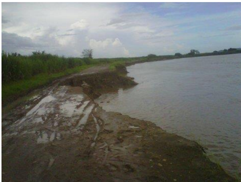
Foto 5.1.9. Afectación a terracería por socavamiento de cauce del río Pánuco, en el tramo Miravegas-Punta Arenas, zona centro-oriental del municipio.
