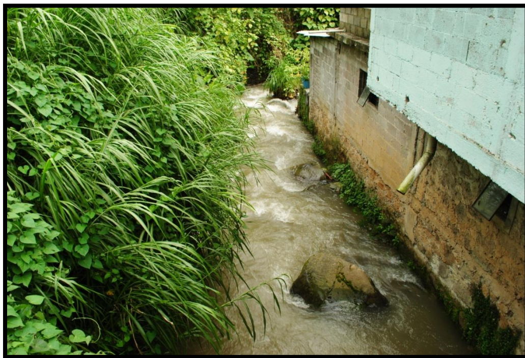
Figura 34. Viviendas en riesgo por erosión laminar en Colonia Chichipico.
