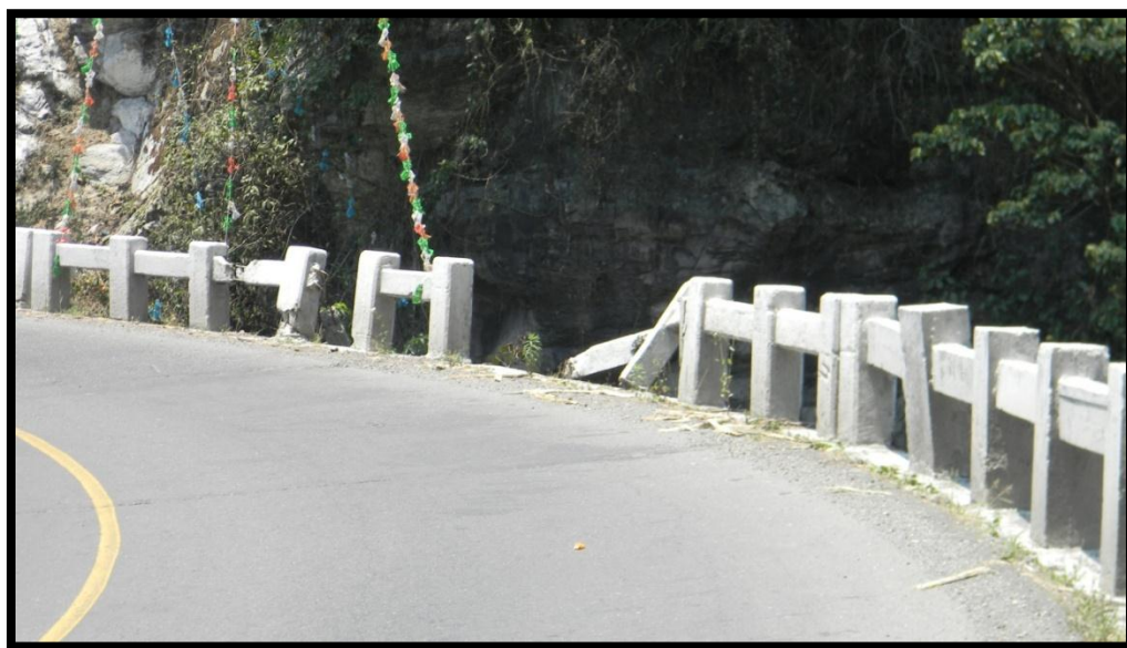
Figura 16. Puente ubicado en la carretera principal, se presentan accidentes frecuentemente.
