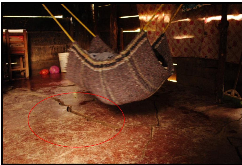
Figura 32. Vivienda de la localidad Tepepixco dañada por deslave de suelo, piso fracturado.
