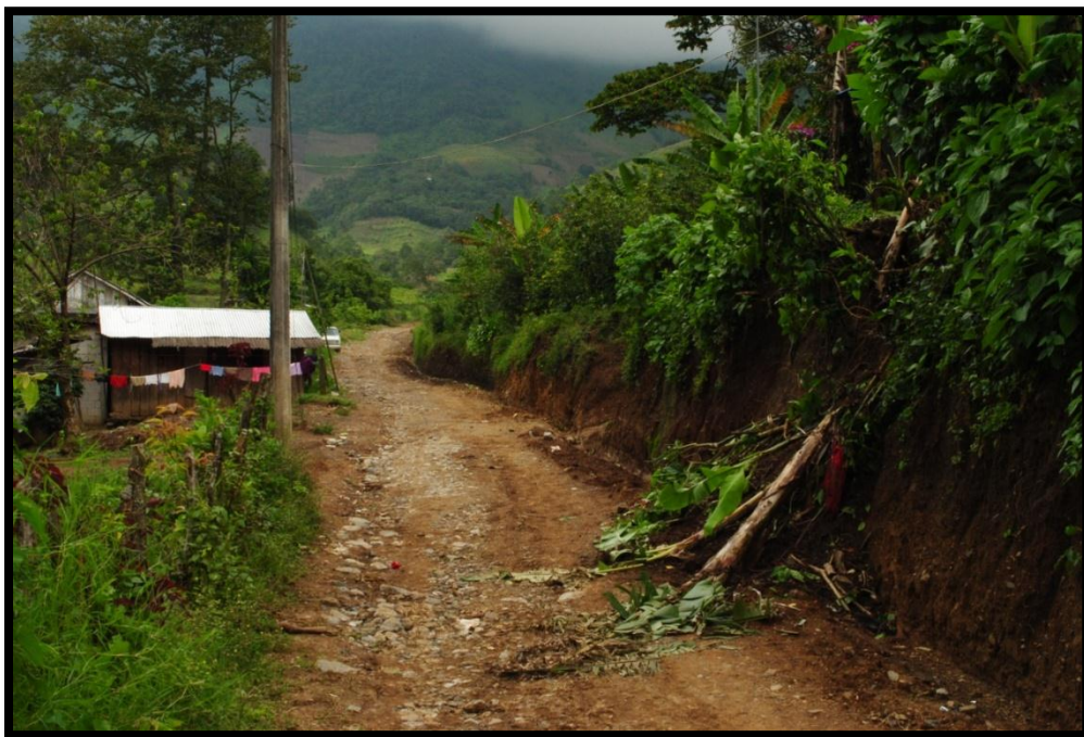
Figura 22. Zona de deslave en vialidad hacia Rincón Pintor.
