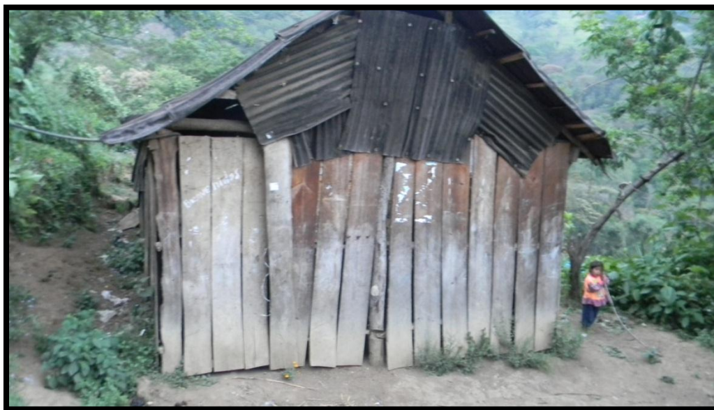
Figura 14. Vivienda con alta vulnerabilidad por suradas, viento de Este a Oeste, niebla y heladas en la localidad La Joya.
