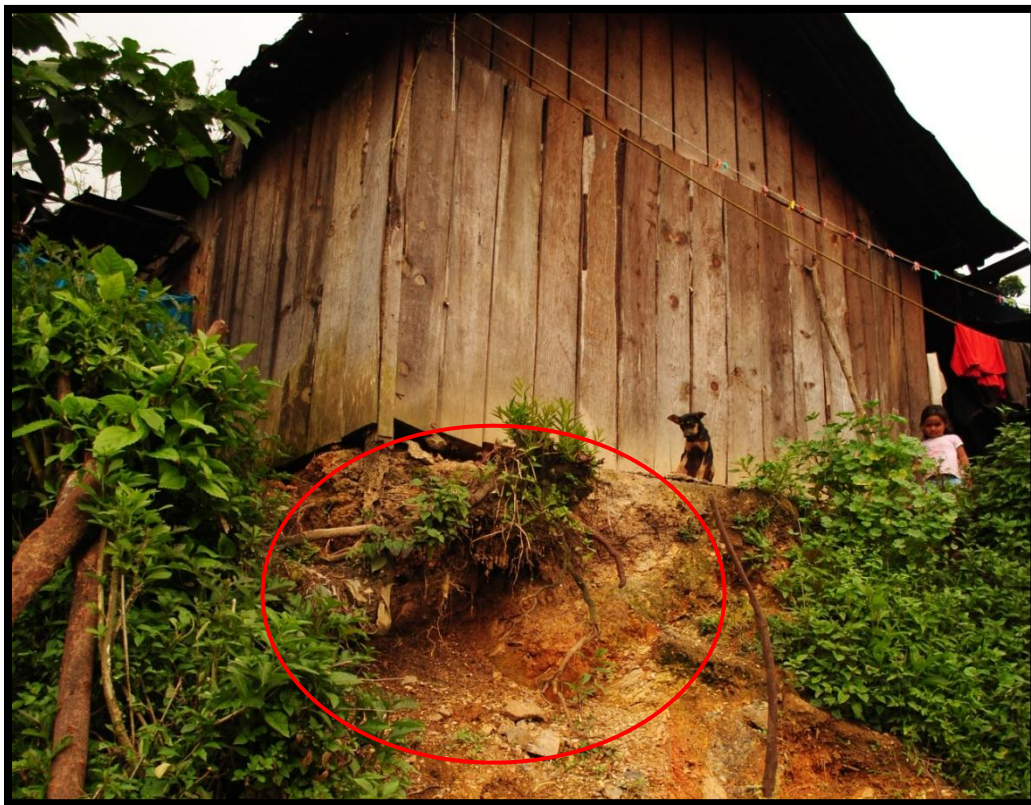
Figura 33. Vivienda en riesgo por erosión lineal en Colonia La Garita.
