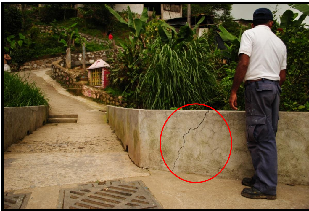
Figura 36. Fractura en concreto del Puente Hermenegildo Galeana.
