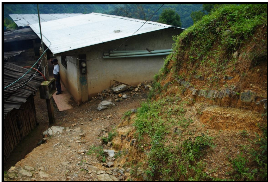
Figura 31. Vivienda en riesgo por deslave en localidad Tepepixco.
