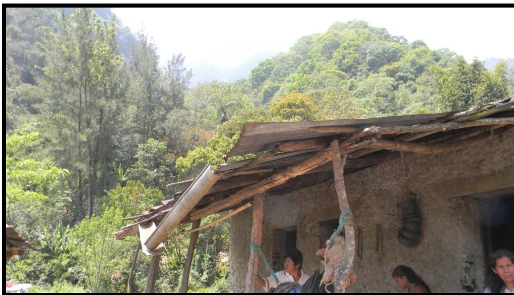
Figura 15. Vivienda afectada por desprendimientos rocosos en la localidad Calaquico.
