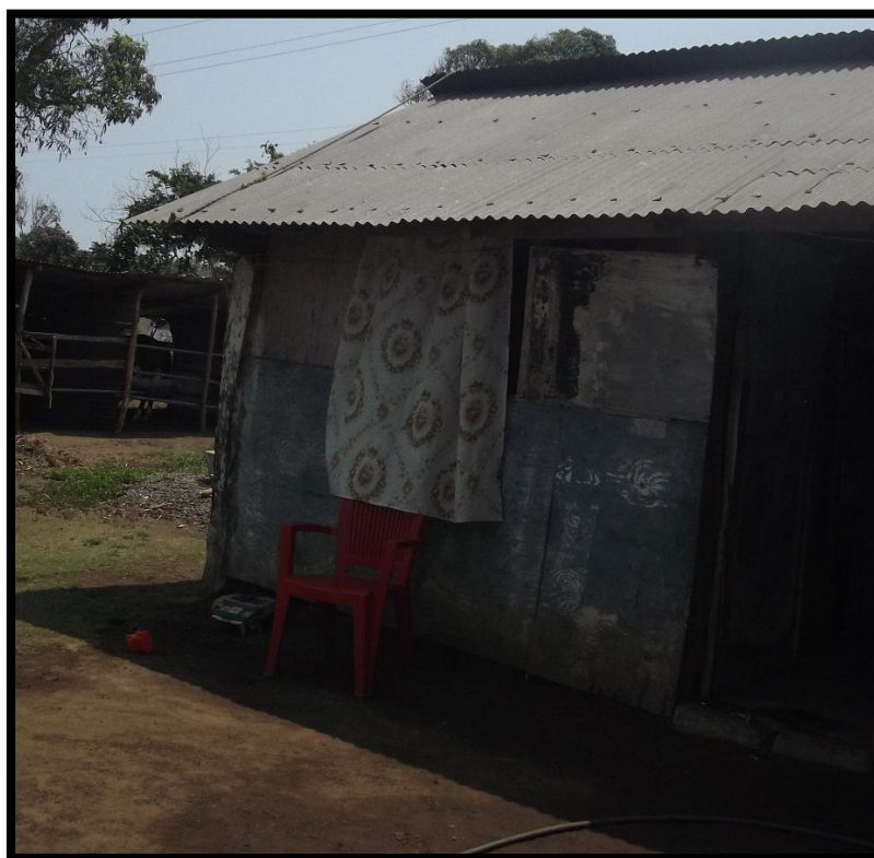
Figura 6. Vivienda ubicada en La Pureza en condiciones precarias debido a los estragos provocados por el huracán Karl.
