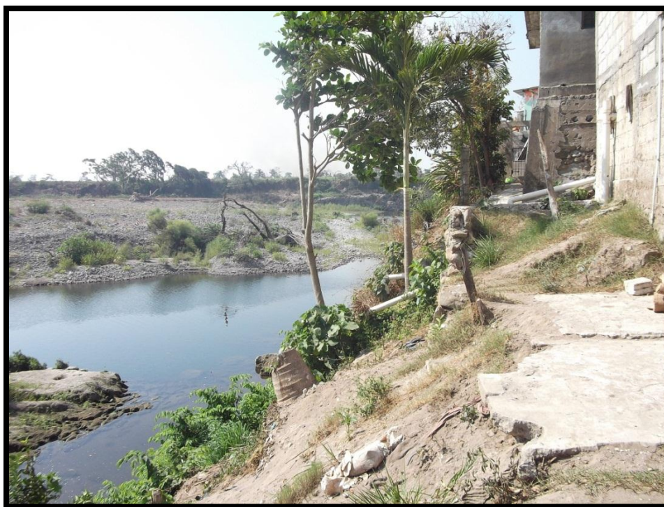
Figura 2. Erosión laminar provocada por río La Antigua, que afecta viviendas de la localidad de José Cardel.
