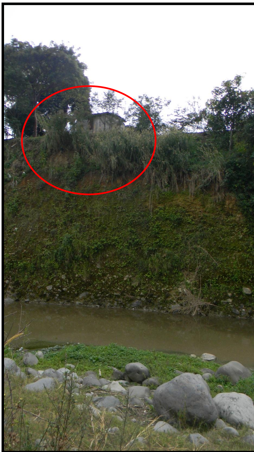
Figura 3.- Erosión Lineal Provocada por Río Seco. 3 Viviendas en Riesgo en la Localidad Paraje Nuevo, Amatlán de los Reyes.
