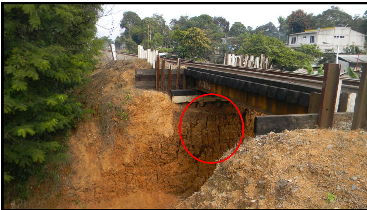
Figura 4.- Erosión Vertical Debido a Obras para Desvío de Escurrimiento Superficial Natural. Se Ubica en las Inmediaciones de Vía del Tren en la Localidad Guadalupe (La Patrona), Amatlán de los Reyes.
