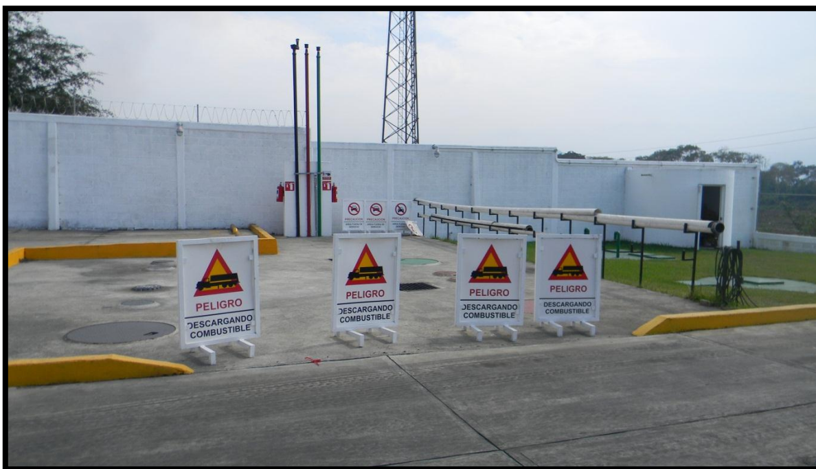
Figura 21.- Gasolinera E.S. 10073. Autoservicio Amatlán, S.A de R.L. de C.V. Instalada en Octubre de 2009, en la Localidad de Amatlán de los Reyes, Amatlán de los Reyes.
