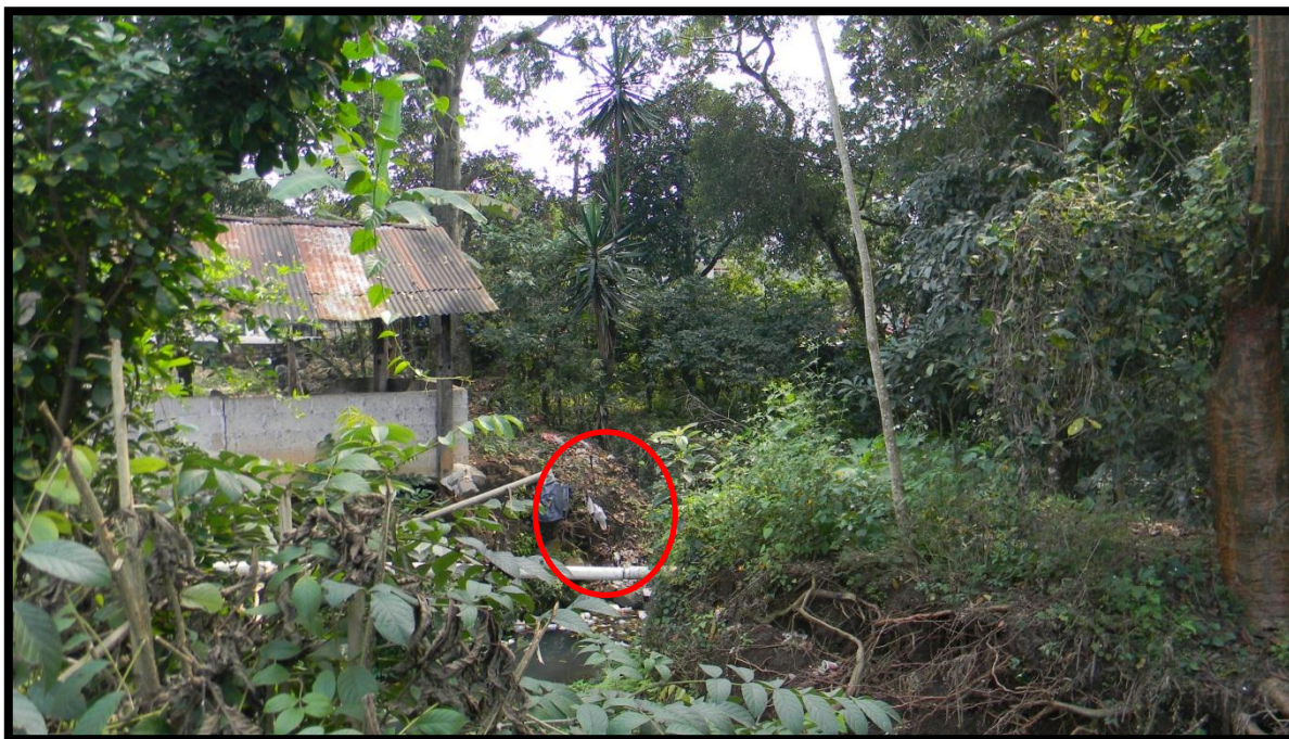
Figura 6.- Erosión Lineal Debido a Canal de Aguas Residuales, 6 Viviendas en Riesgo en la Localidad de Guadalupe (La Patrona), Amatlán de los Reyes.
