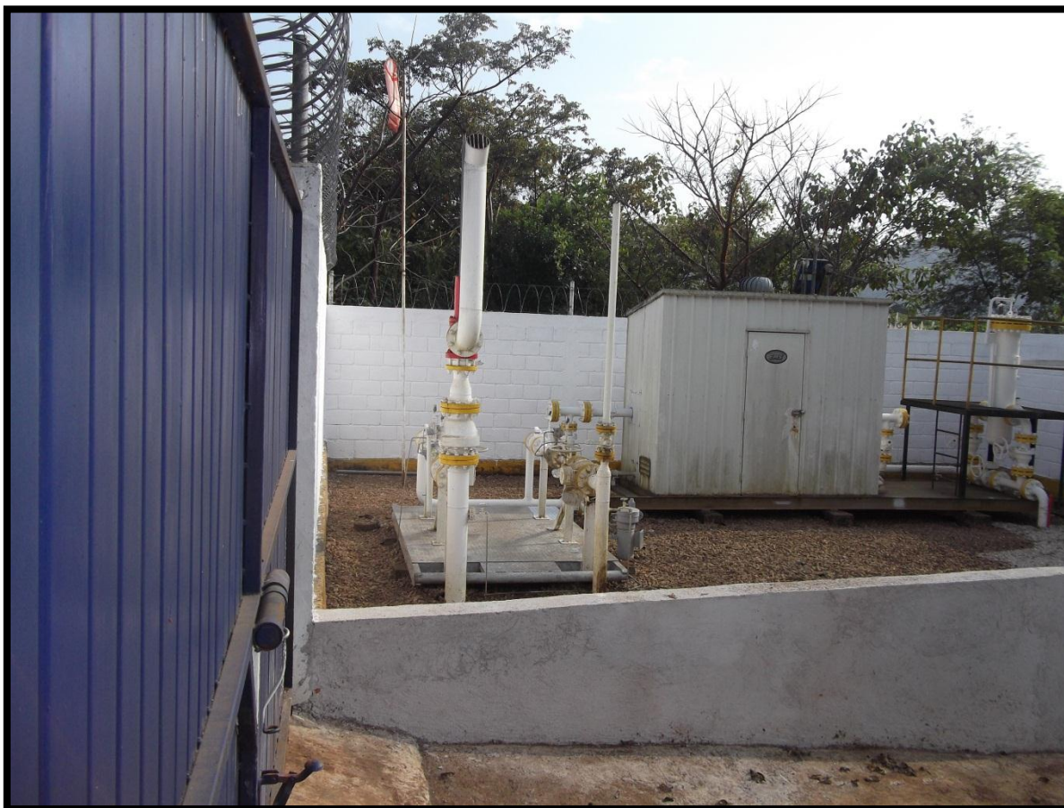
Figura 15.- Estación de Medición y Regulación de Gas No. 30109-01. Empresa "Igasamex" Sistema Cordugas en la Localidad de Chilpanapa, Amatlán de los Reyes.
