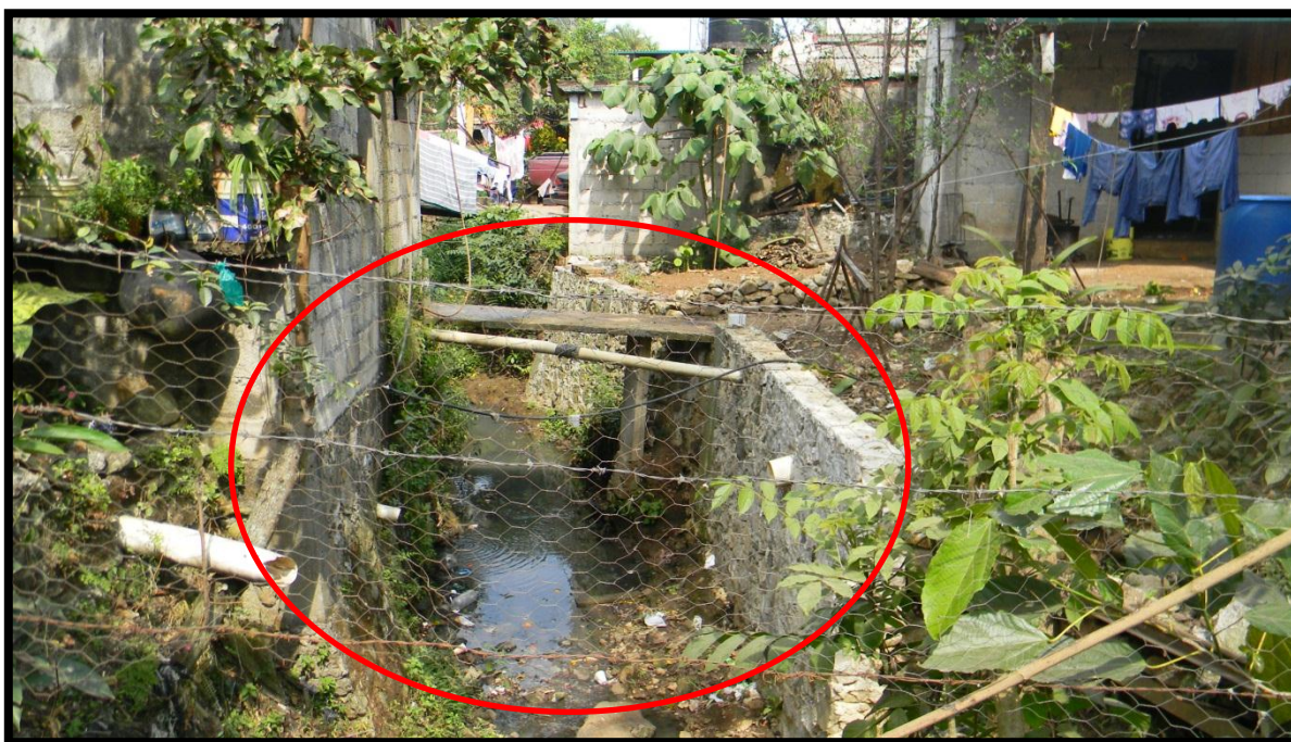
Figura 10.- Arroyo de Respuesta Rápida. Alrededor de 7 Viviendas Afectadas por Encharcamiento, en la Localidad de Guadalupe (La Patrona), Amatlán de los Reyes.
