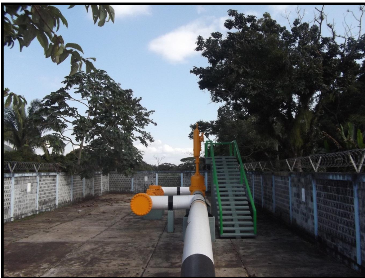
Figura 13.- Estación de Bombeo Pemex en la Localidad de Guadalupe (La Patrona), Amatlán de los Reyes.
