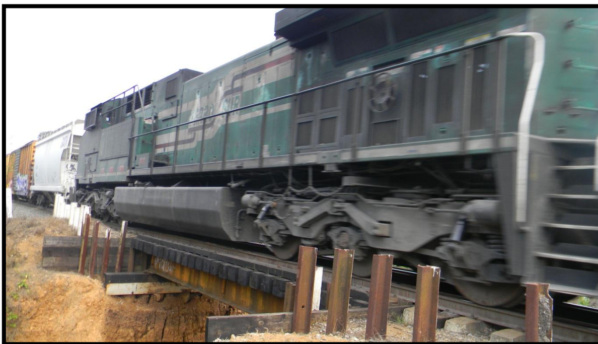
Figura 38.- Vía de Tren en Riesgo de Descarrilamiento en Localidad de Guadalupe (La Patrona), Amatlán de los Reyes.
