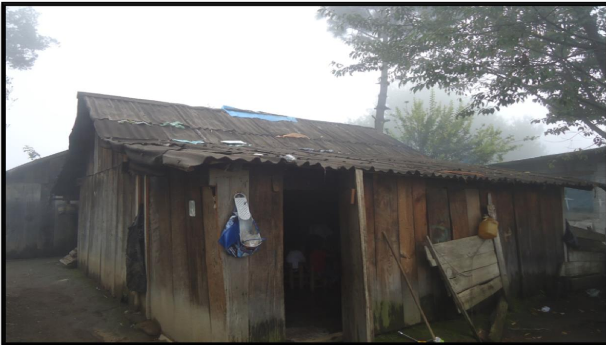
Figura 11.- Vivienda vulnerable a fenómenos meteorológicos como viento, precipitación y Granizo. Fuente: Protección Civil Municipal.
