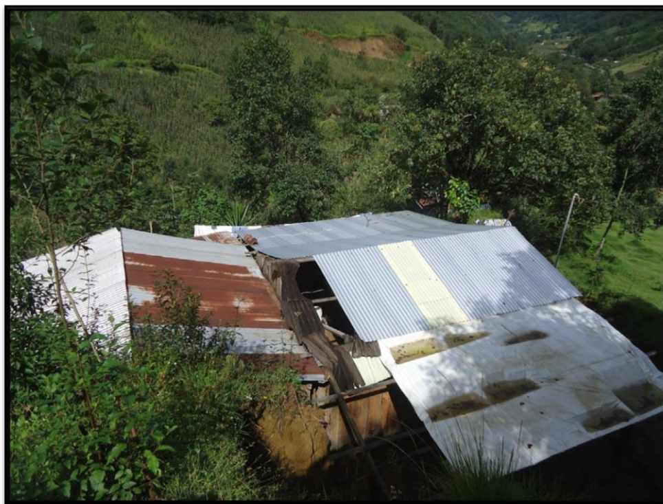
Figura 14.- Vivienda vulnerable a fenómenos meteorológicos como viento, granizo y precipitación Fuente: Protección Civil Municipal
