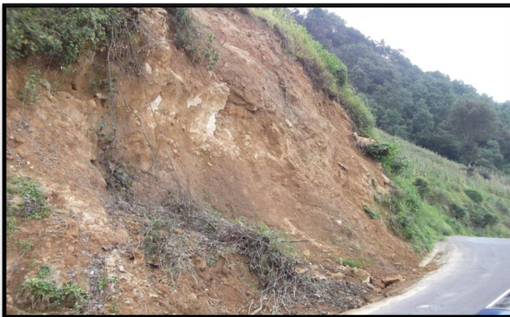
Figura 2.- Deslave en la carretera de Cocaltzingo.
