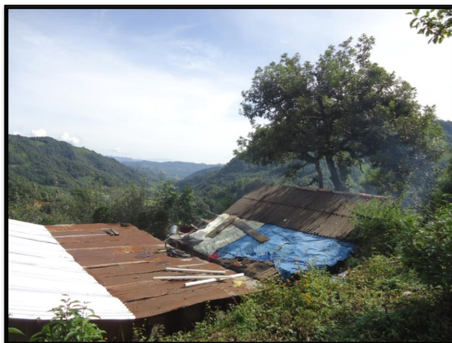
Figura 10.- Vivienda vulnerable a fenómenos meteorológicos como viento, precipitación y granizo. Fuente: Protección Civil Municipal.
