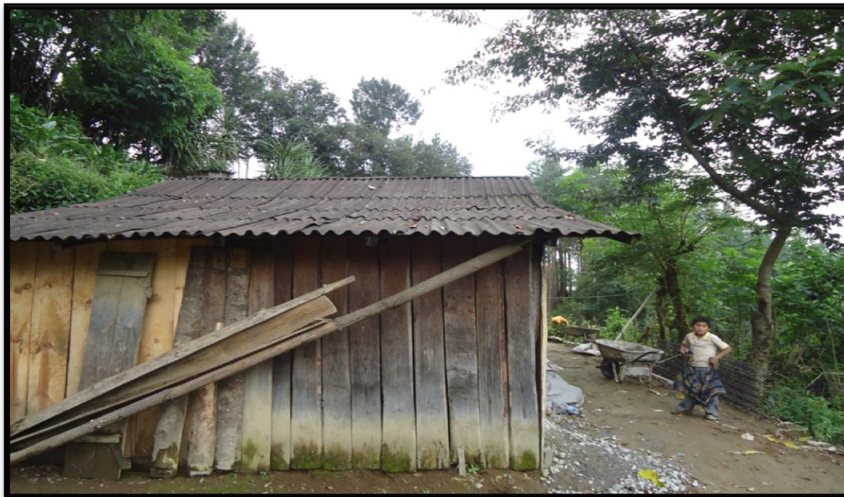
Figura 12.- Vivienda vulnerable a fenómenos meteorológicos como viento, granizo y precipitación. Fuente: Protección Civil Municipal.
