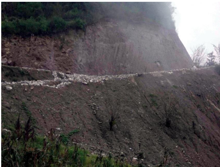
Fotografía 3.5. Material piroclástico en un corte de carretera muy propenso a experimentar cualquier tipo de remoción en masa, tramo Ayahualulco – Mesa de Buena Vista.
