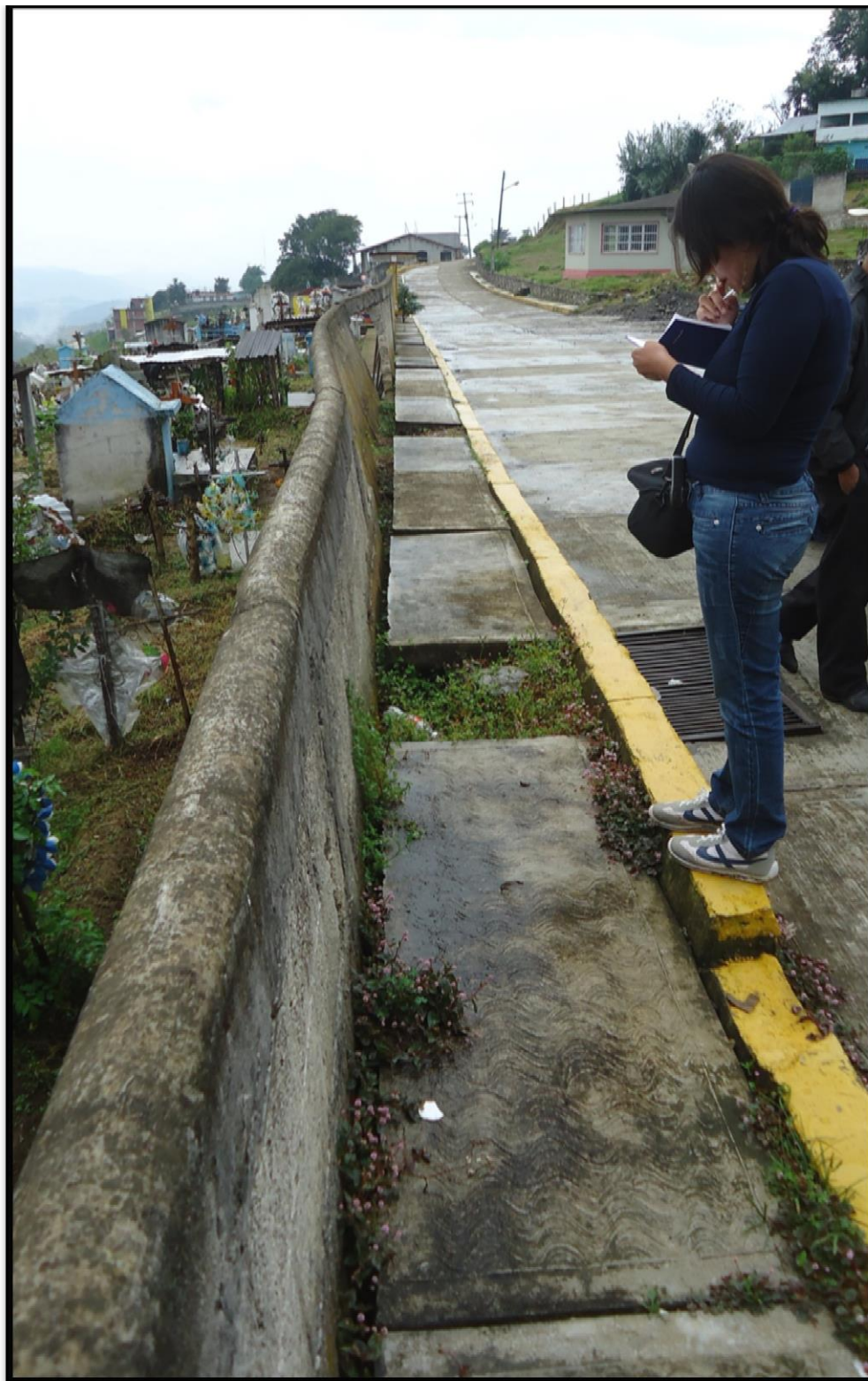
Figura 25.- Barda a punto de caerse debido al deslizamiento de la tierra ya que se encuentra localizada en una ladera en la cabecera municipal.
