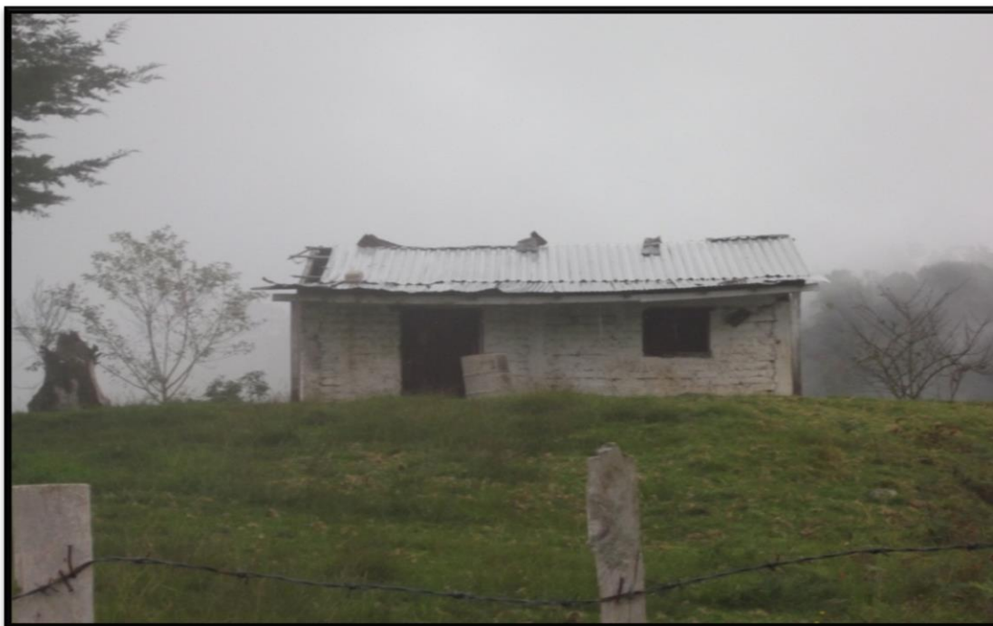
Figura 6. Bodega afectada por viento en la localidad El Águila
