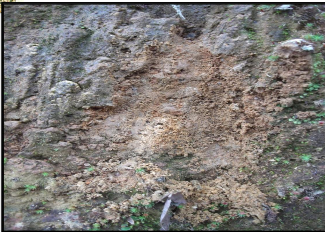
Figura 5. Deslave de tierra en tramo vial de Calzacayo- El Águila.
