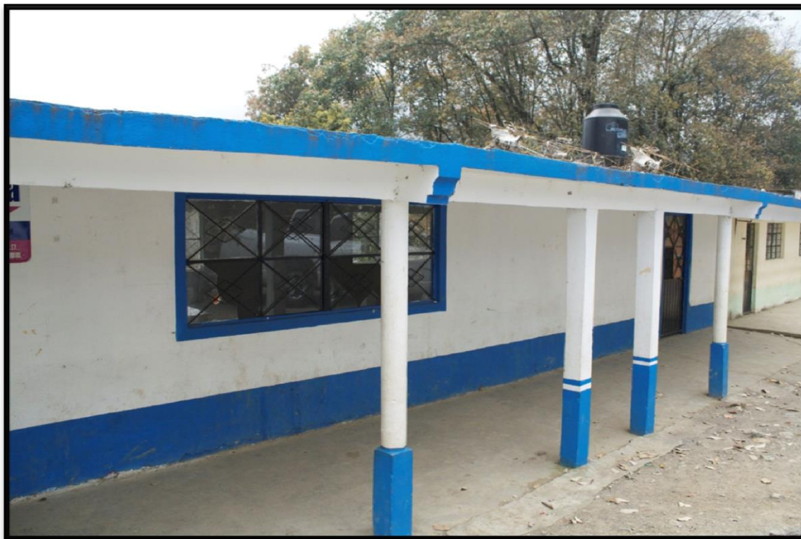
Figura 15.- Albergue localizado en la agencia municipal. Presencia de vientos fuertes en la localidad Cocalzingo.
