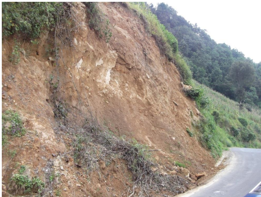
Fotografía 3.3. Corte de Carretera con Material Alterado Propenso a Derrumbes y Deslaves.
