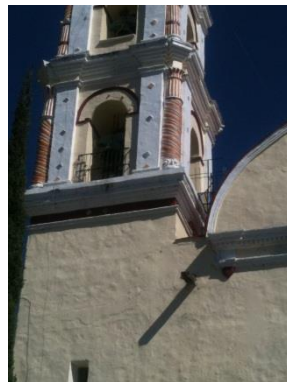
Foto 36. Iglesia del calvario dañada por sismo
