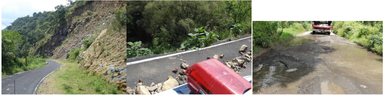
Foto 29, 30 y 31. Derrumbes en vías de comunicación de las localidades del municipio de Tochimilco (recorrido en campo 17/09/2011)
