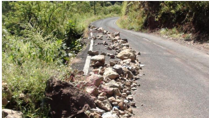
Foto 62. Rocas colocadas para inhabilitar carril
