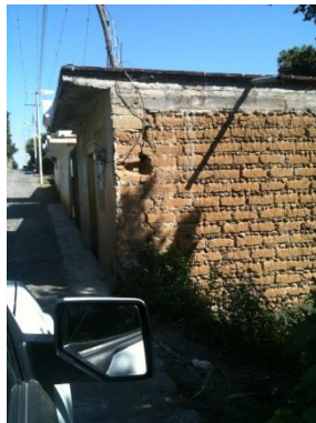
Foto 39. Casa dañada por sismo en Tochimilco
