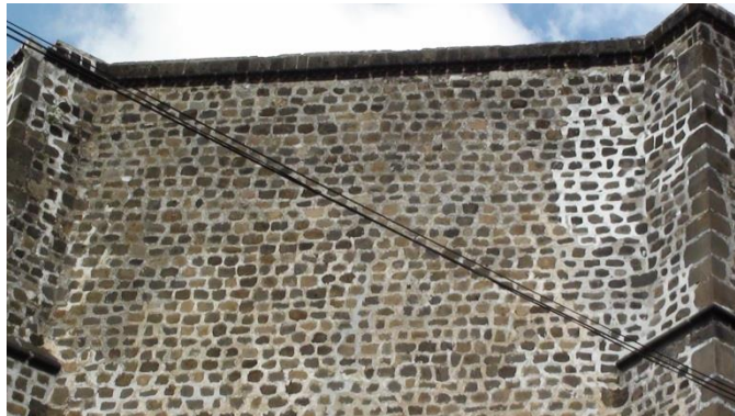
Foto 41. Ex-Convento dañado en su zona lateral
