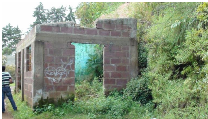
Foto 54. Vivienda dañada por deslizamiento en San Antonio Alpanocan
