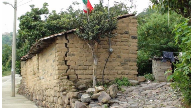
Foto 34. Casa dañada por sismo en La Magdalena
