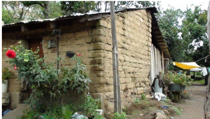
Foto 35. Casa dañada por sismo en La Magdalena
