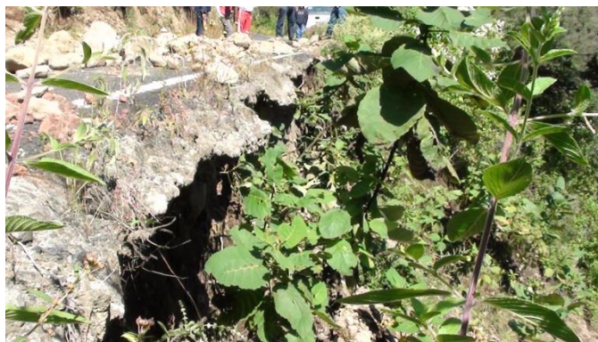
Foto 63. Pérdida de suelo
