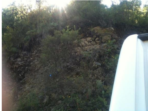
Foto 64. Talud con pérdida de vegetación
