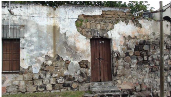
Foto 38. Casa dañada por sismo en Tochimilco
