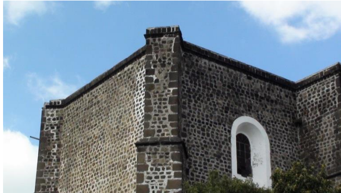
Foto 40. Ex-Convento dañado en su zona lateral
