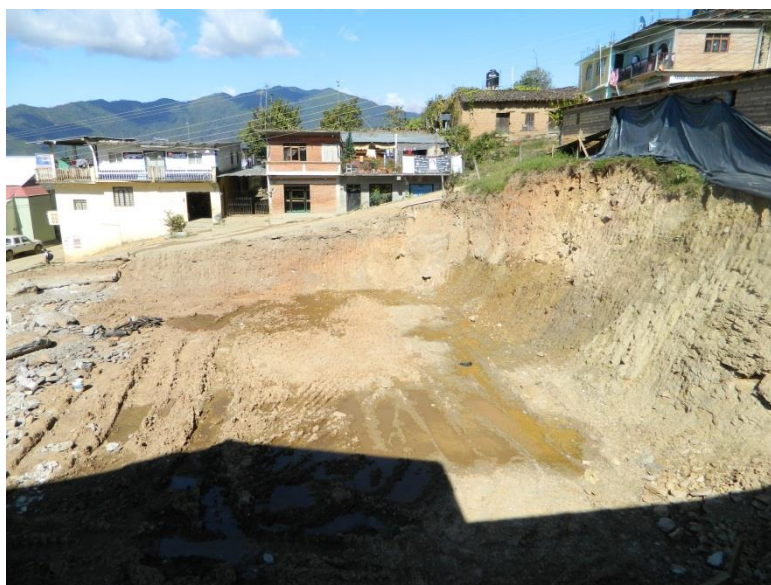
Figura 53.- Excavación en el centro del Municipio de San Juan Quiotepec. El sustrato expuesto indica antiguos deslizamientos (nótese el cambio de la coloración al interior, típico de una mezcla de material)
