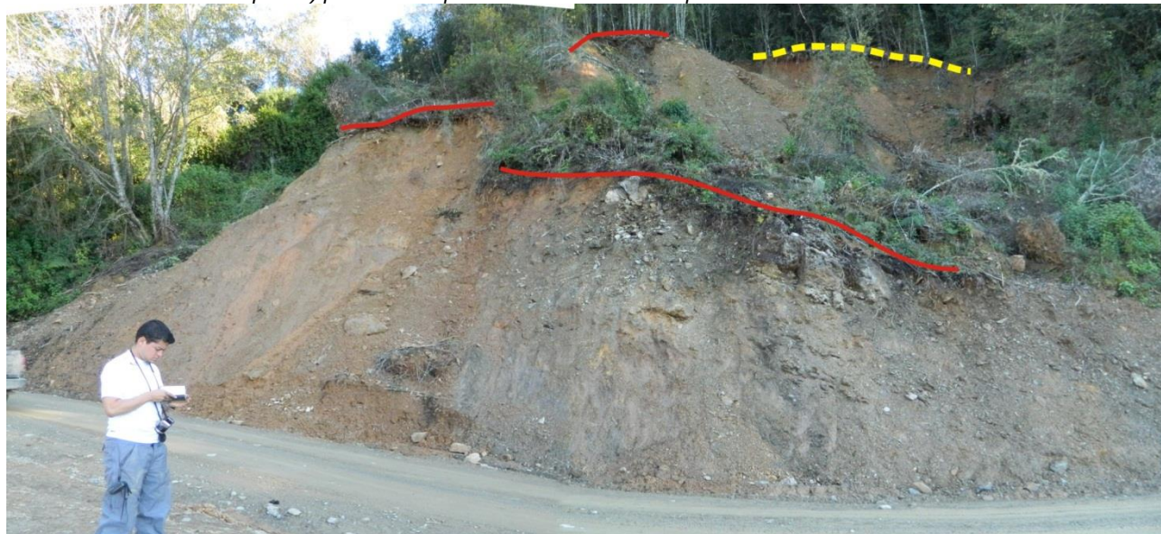
Figura 29. Fotografía de la zona superior de un deslizamiento rotacional (cerca de la entrada este de San Juan Quiotepec). En la parte superior derecha se observa un escarpe que indica la corona de desprendimiento (línea punteada), mientras que en primer plano se notan bloques (parte superior, línea continua) y como estos se basculan hacia el escarpe de la corona de desprendimiento. Nótese como el material se encuentra revuelto (diferentes tonalidades al interior del depósito) pero no completamente mezclado lo que indica la corta distancia de remoción.
