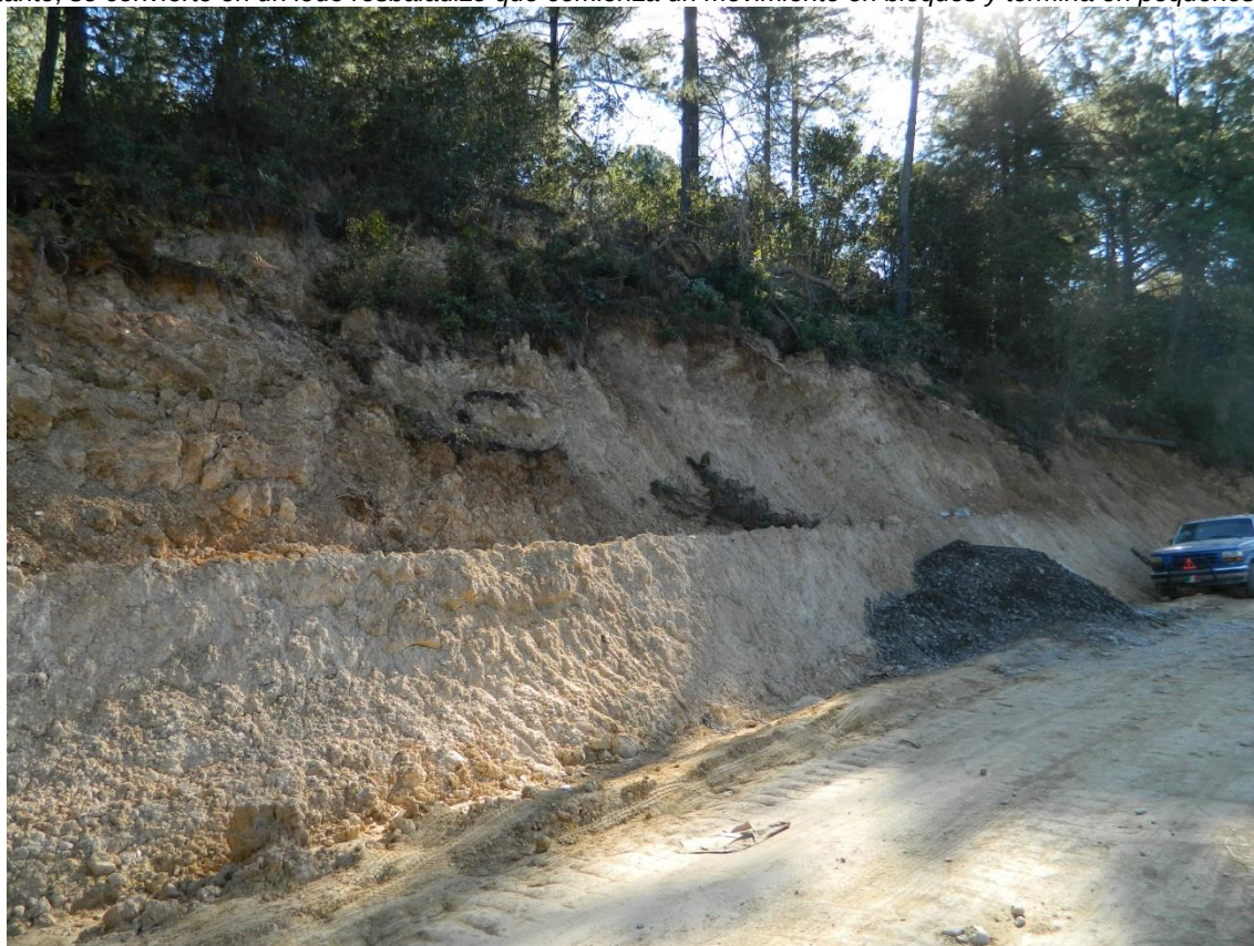
Figura 28. Ladera del camino hacia San Juan Quiotepec desde San Pedro Yólox, nótese como el material muestra un color café blanquecino. Aquí el material se ve muy alterado, cuando este material es hidratado en el caso de una lluvia constante, se convierte en un lodo resbaladizo que comienza un movimiento en bloques y termina en pequeños flujos.
