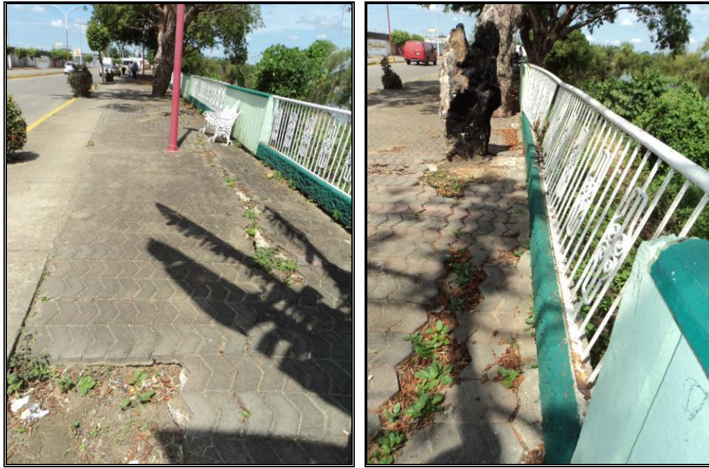
Fotografías 41 y 42. Afectaciones que se observan en el muro boulevard.
