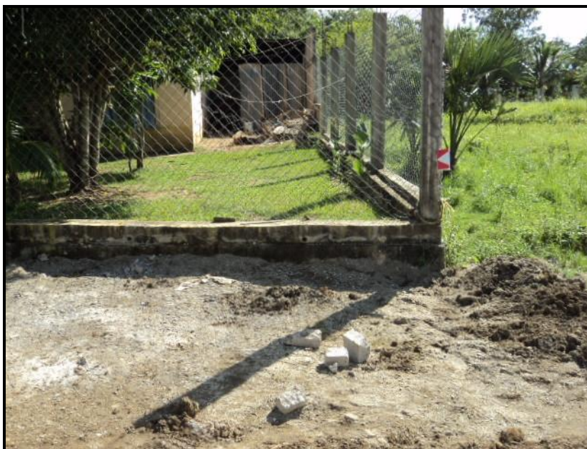
Fotografía 28. Vivienda afectada por encharcamiento.
