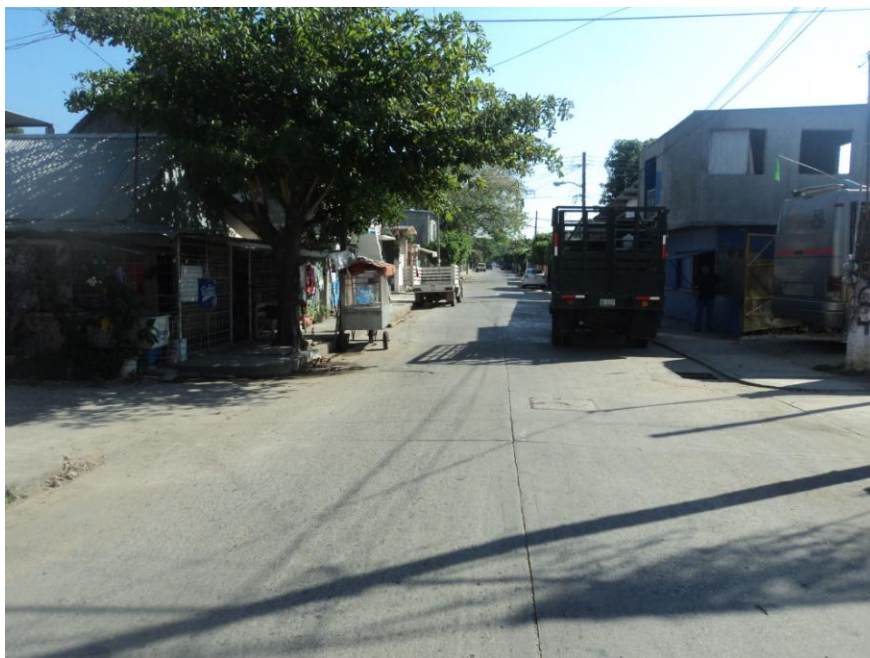
Fotografía No. 9. Sobre la Calle Morelos, Esq. René Azueta se tiene afectación por encharcamiento derivado de las diferentes elevaciones que se tienen en esta colonia.
