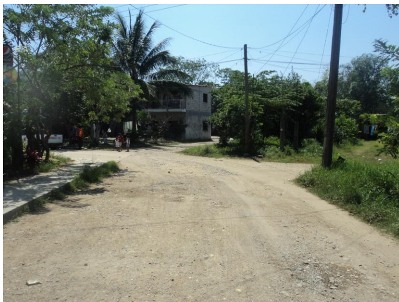
Fotografía No. 14. Sobre la Av. Las Palmas Esq. con Calle Reforma se tiene un promedio de altura de inundación de 1 m. ocasionada por la diferencia de elevación en esta parte de la colonia y por las condiciones del drenaje sanitario.
