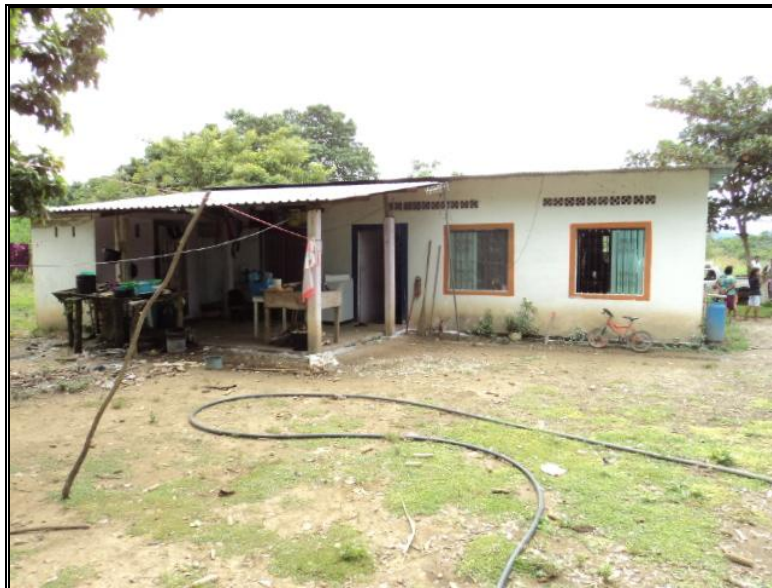
Fotografía 24. Única vivienda construida de ladrillo y techo rígido (nótese sobre la pared el nivel de inundación por desborde del Río Tonto).
