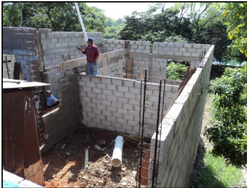
Fotografía 33. Ubicación del punto PIN-04 y donde se observa la construcción de viviendas sobre el cauce del Rio Papaloapan (Colonia El Reacomodo 2).
