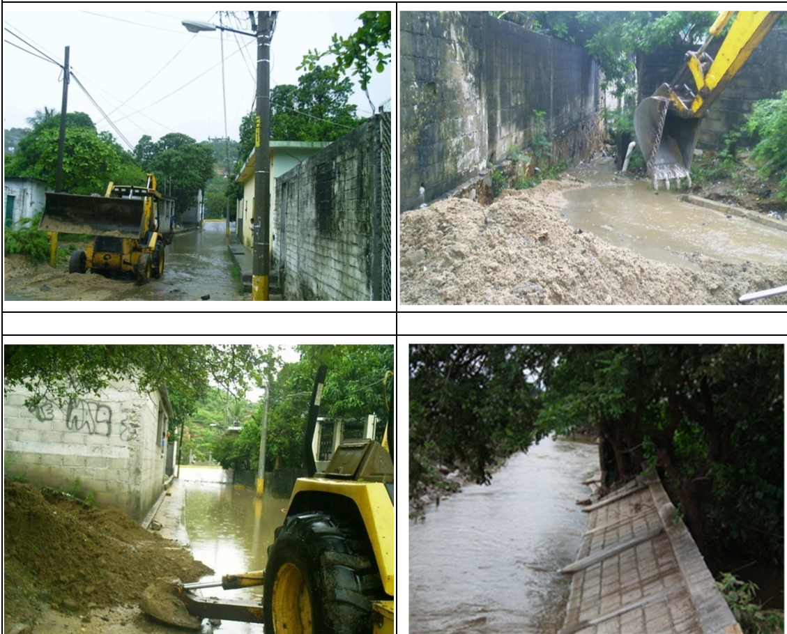
CUADRO N°35 FENÓMENO PERTURBADOR: INUNDACIÓN COL. 1° DE MAYO
