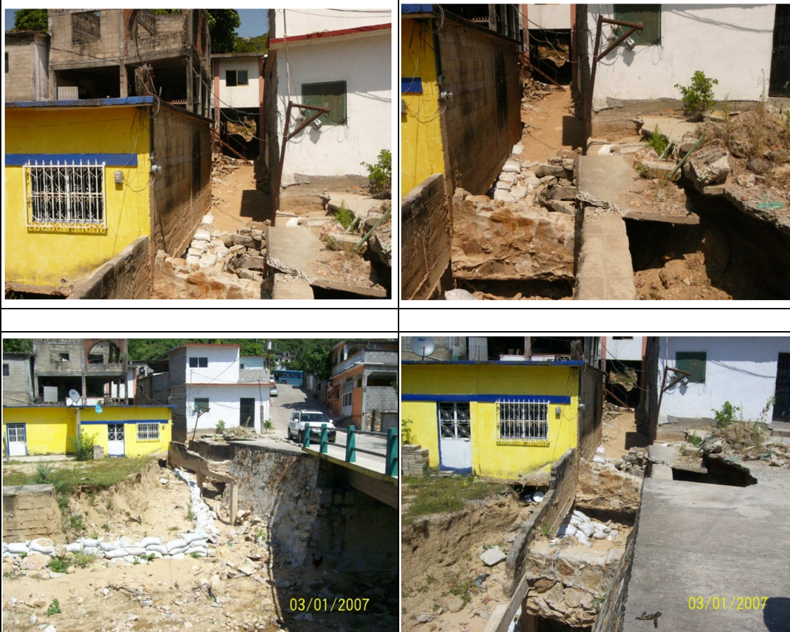
CUADRO N°21 FENÓMENO PERTURBADOR: EROSIÓN HÍDRICA COL. VICENTE GUERRERO
