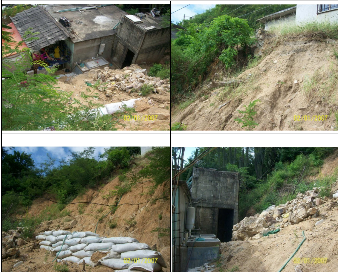
CUADRO N°11 FENÓMENO PERTURBADOR: DERRUMBE BARRIO ESPINAL NORTE
