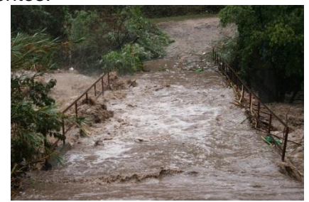
Ilustración 25.- El nivel de agua en el río superó la altura del puente.
