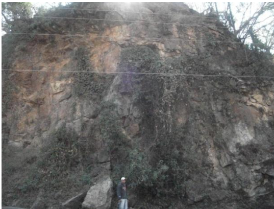
Ilustración 19.- Zona de derrumbe
