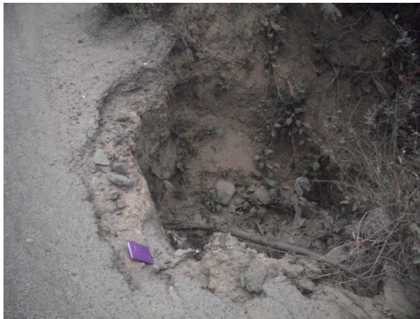
Ilustración 34.- Hundimiento a la orilla de la carretera. 2.70m de ancho y 1.70 de alto.
