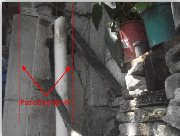
Ilustración 8.- Casa afectada por fracturas donde se compara cuál era la posición original de los muros.
