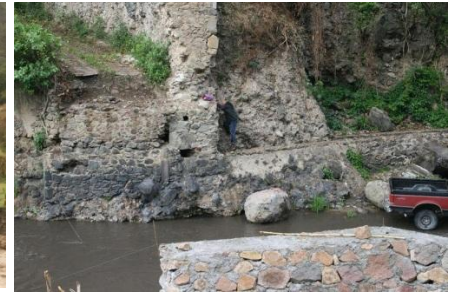
Ilustración 33.- Daño en vías de comunicación (desaparición de puente san Antonio).
