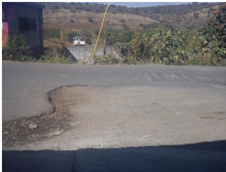
Foto 20. Zona de hundimiento en Parícuaro. Fuente: A+I Construcciones S.A. de C.V.
