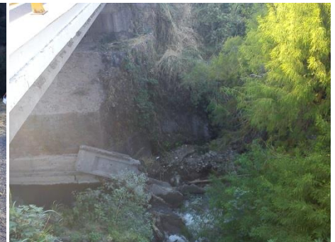
Foto 15. Cauce del río y situación de la vegetación inclinada en sus laderas. Fuente: A+I Construcciones S.A. de C.V.
