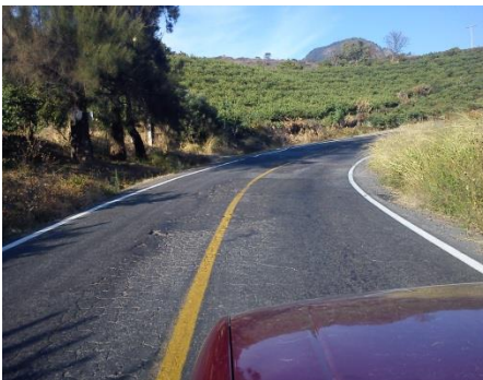
Foto 23. Hundimiento en carretera Trincheras-Benito Juárez. Fuente: A+I Construcciones S.A. de C.V.
