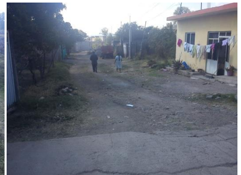
Foto 23. Deterioro y hundimiento en calles pavimentadas y de terracería. Fuente: A+I Construcciones S.A. de C.V.
