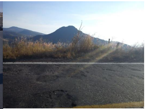
Foto 22. Hundimiento en carretera al noreste de Guanoro. Fuente: A+I Construcciones S.A. de C.V.
