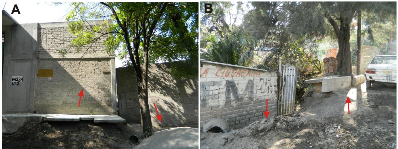
A) La construcción de la derecha se ha desprendido ligeramente del terreno, mientras que la construcción de la izquierda se ha basculado hacia la parte elevada. B) Del otro lado de la calle se observa el mismo proceso en sentido invertido (de acuerdo con la perspectiva de la foto).
