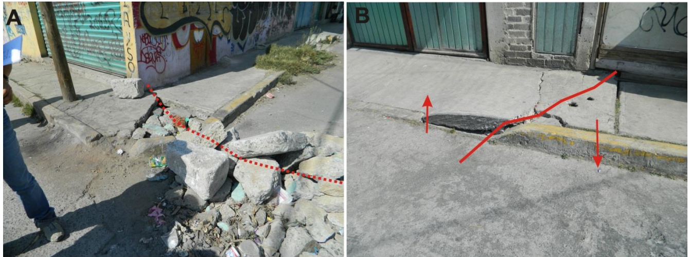
Figura 18. Agrietamiento en la zona baja de la zona lacustre del municipio de Valle de Chalco Solidaridad.
