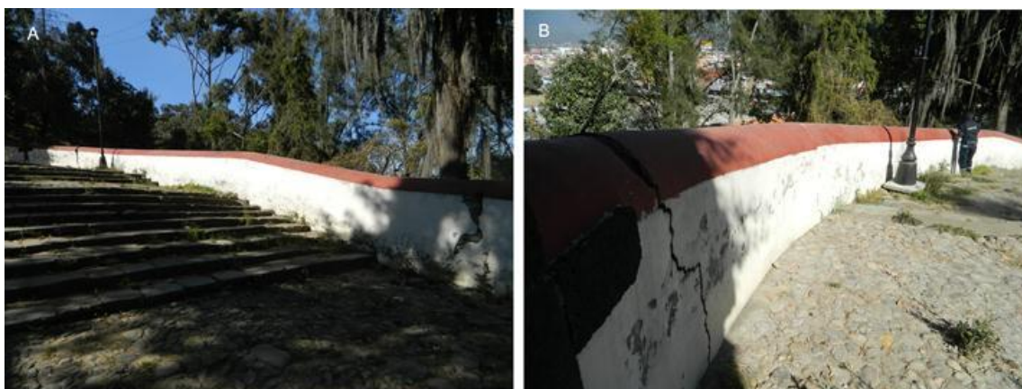
Figura 25 Agrietamiento en la iglesia del Señor del Sacromonte.
