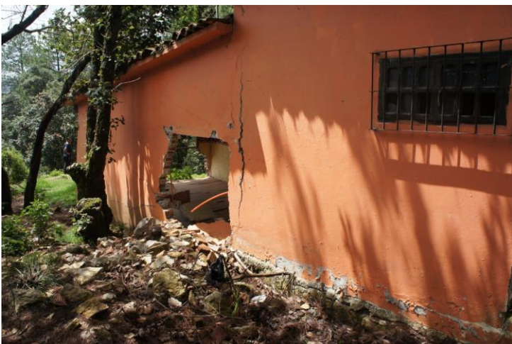
Localidad de San Felipe Ecatepec. Barda de casa habitación destruida por derrumbe.
