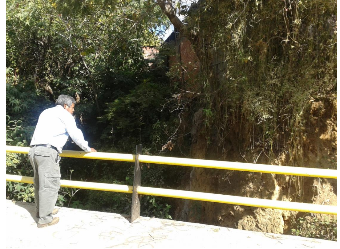
Figura 40. Construcción sobre el escarpe fluvial en San Agustín Yateraní, Oaxaca. Nótese que el sustrato está constituido por arena fina a gruesa, lo que hace factible la ocurrencia no solo de un deslizamiento pequeño si no de la caída o derrumbe de escombros.
