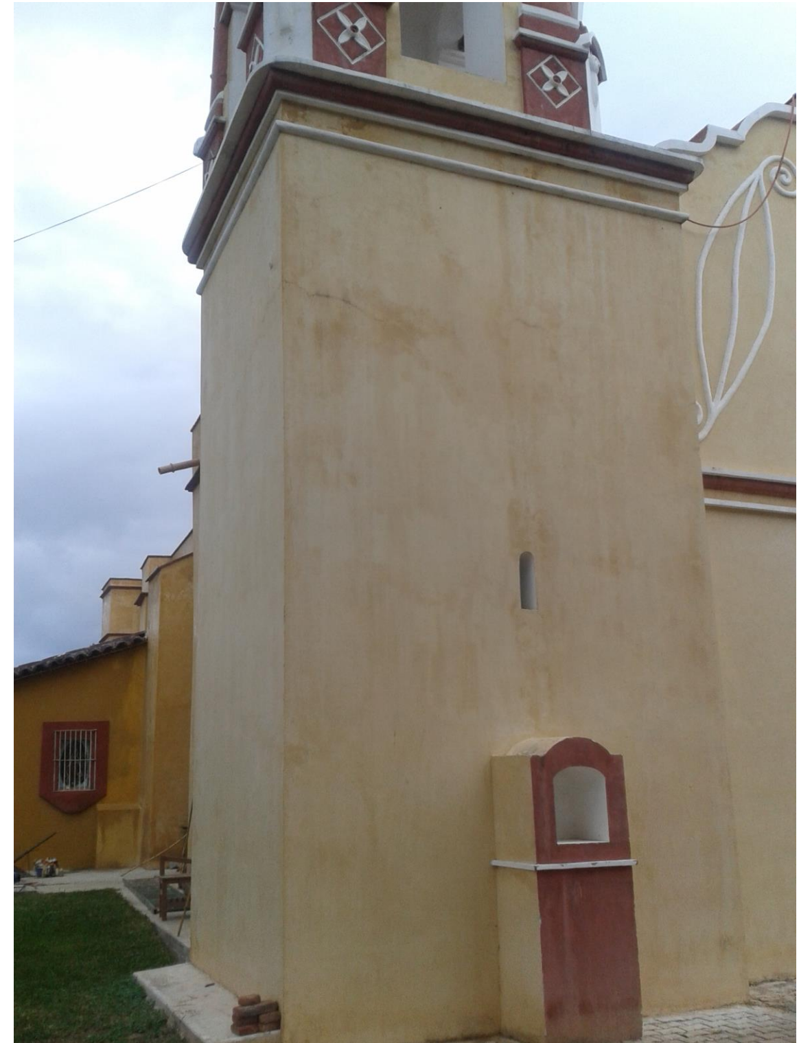
Figura 32. Grieta formada durante el sismo de 1997.
