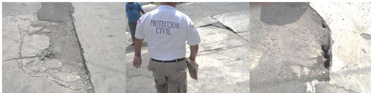
Figura 60. Ejemplificación de grietas en proceso de colapso en áreas de subsidencia, col. El Corralito.
