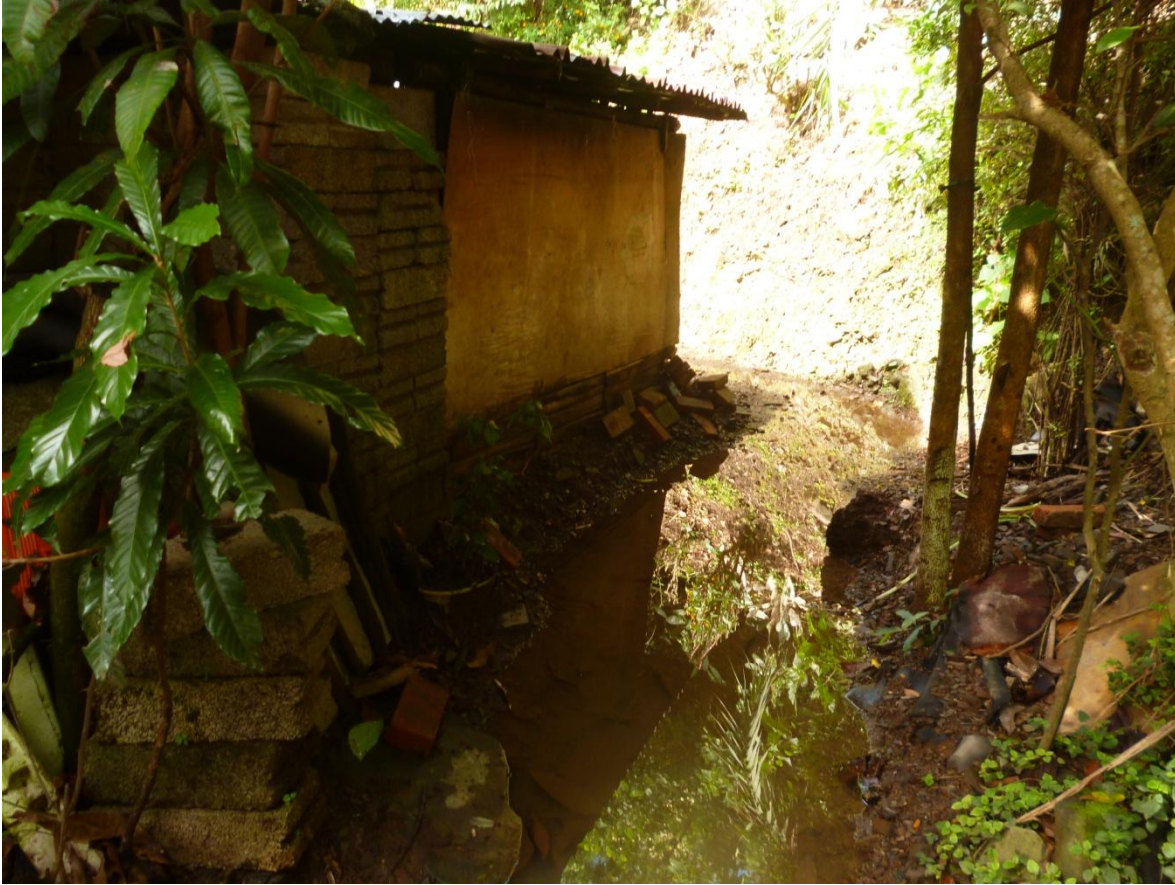
Fotografía 4. Esguerrimiento hídrico proveniente de uno de los múltiples manantiales en la localidad de Cuatahuatla.
