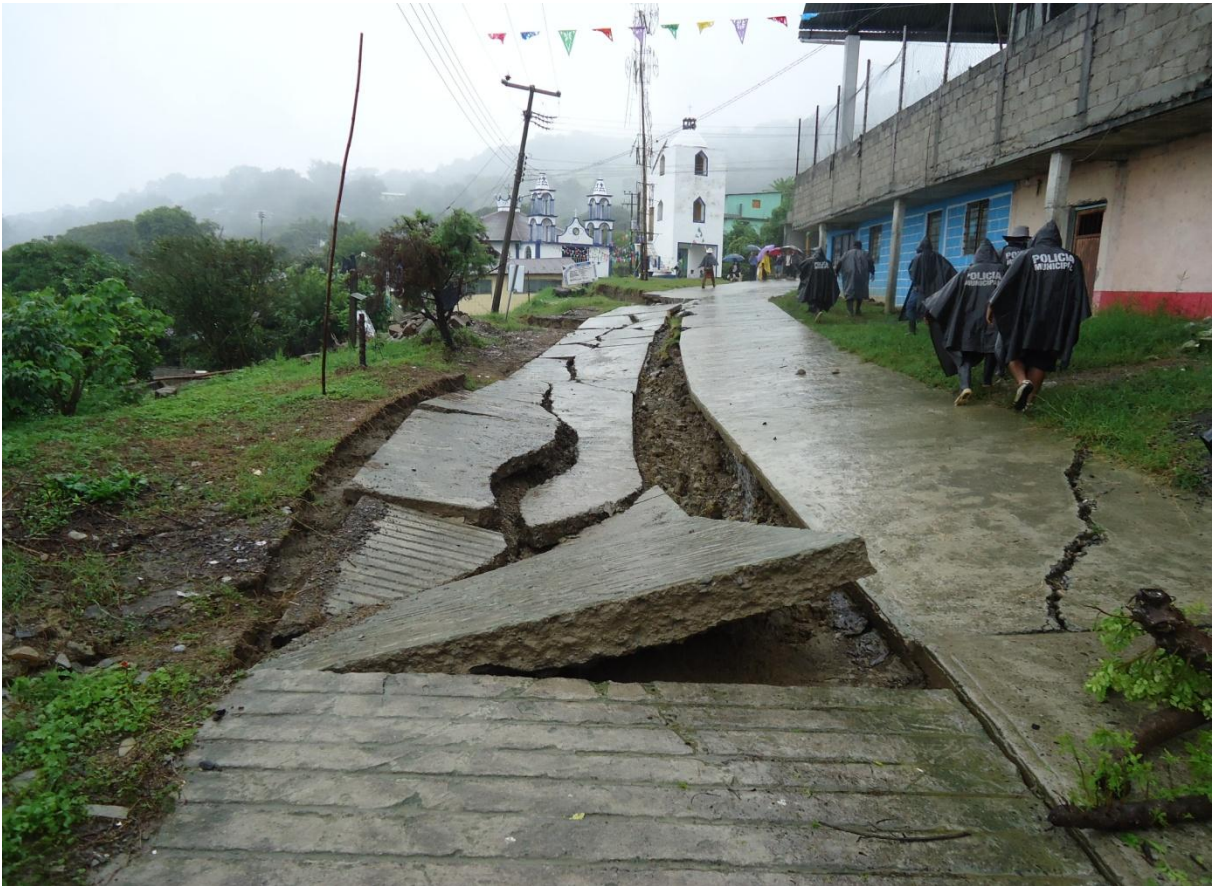
Fotografía 15. Deslizamiento de suelo ocurrido en septiembre de 2013 en la localidad de Cuatlimax.
