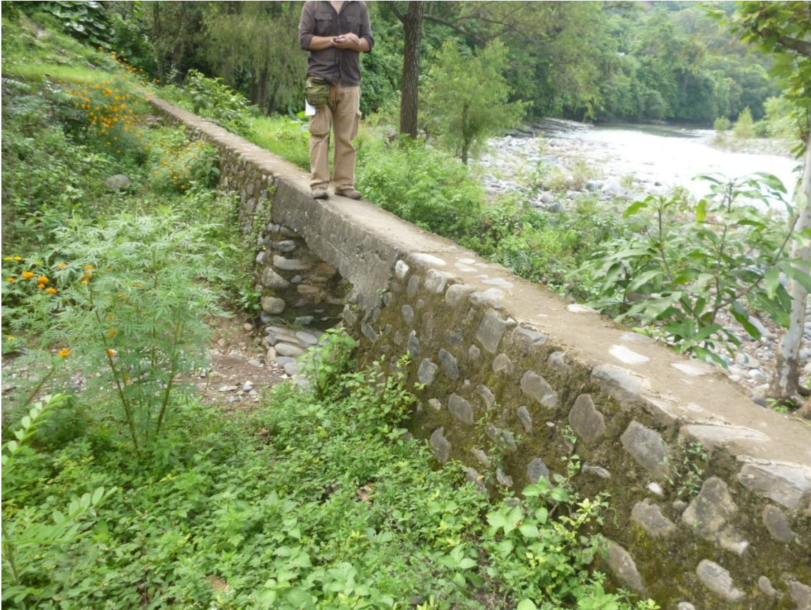
Fotografía 2. Muro de contención de la localidad Jalpa. Se observa la abertura de influencia hídrica.
