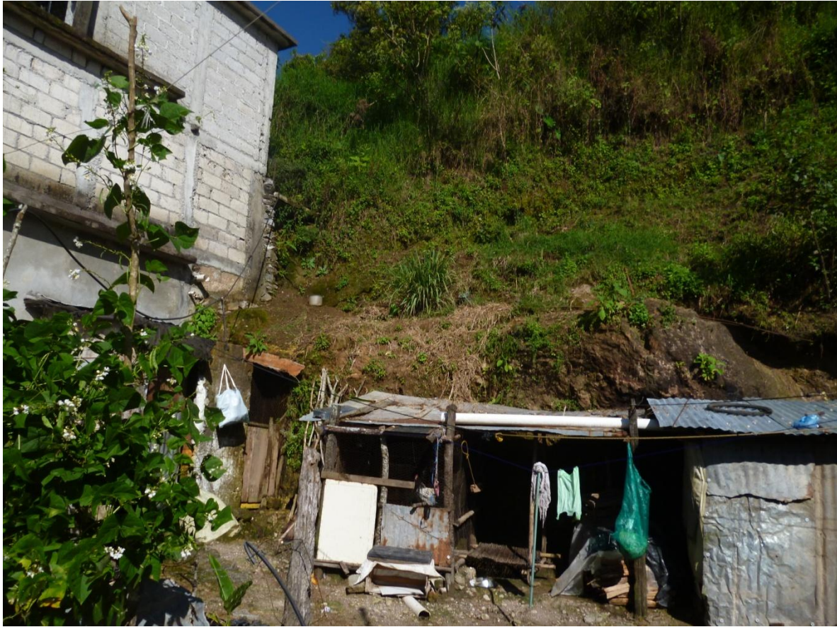
Fotografía 17. Casas en zonas inestables dentro de la cabecera municipal Tlanchinol.
