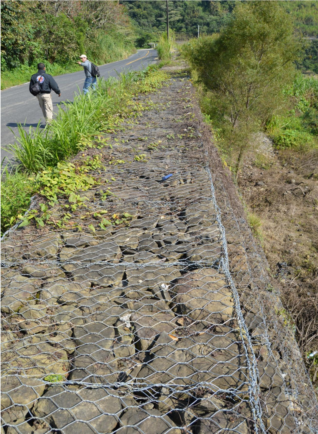
Fotografía 18. Muro de gaviones construido en la carretera estatal 105 Huejutla - Pachuca, para la retención de un deslizamiento antiguo.
