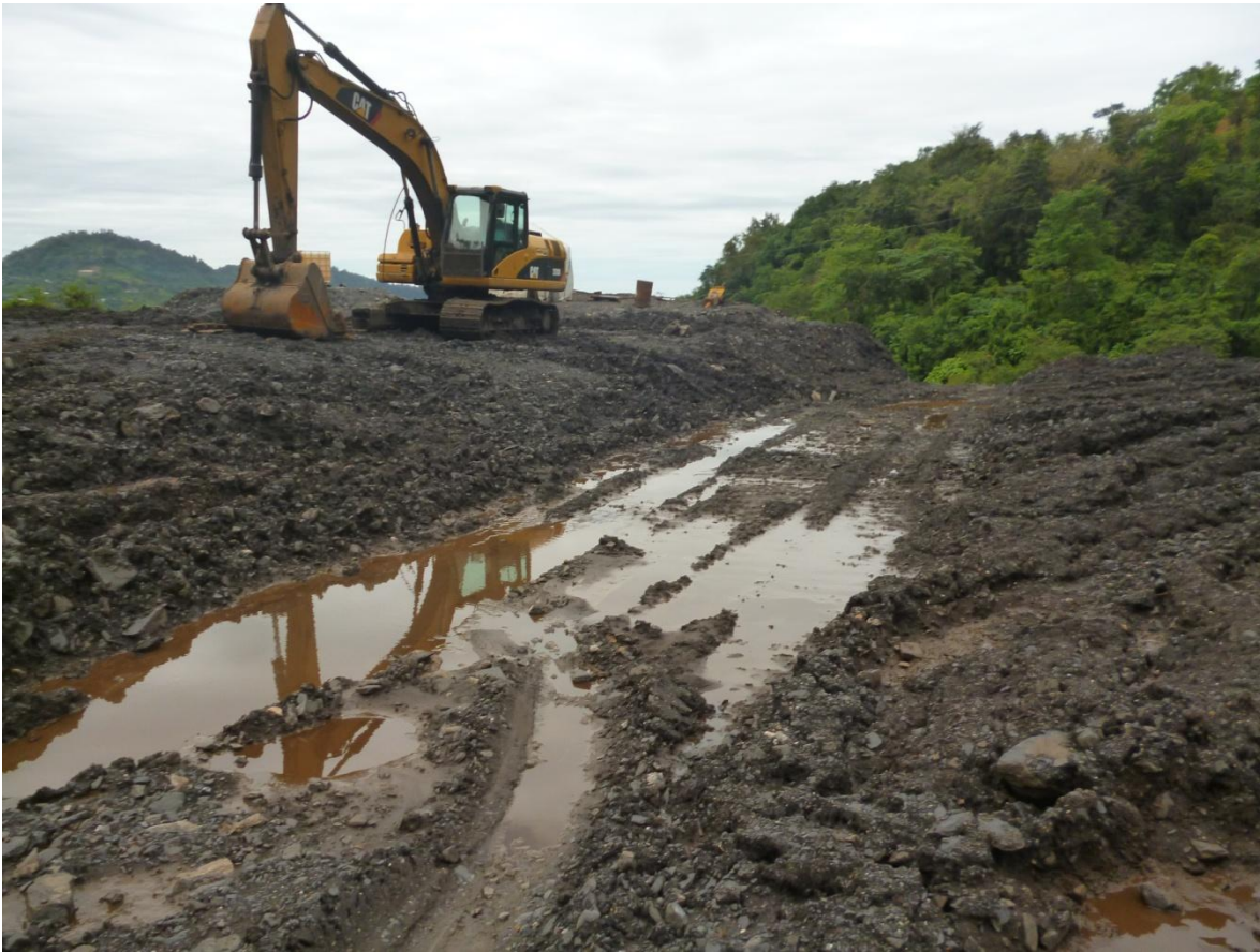
Fotografía 7. Afectaciones de la mina Chipoco en la obtención de manganeso.
