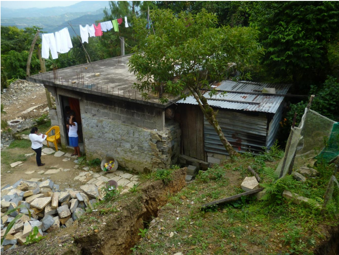
Fotografía 10. Vuelco de una masa de suelo desencadenado por la apertura de un camino e introducción de drenaje en la localidad de Temango.
