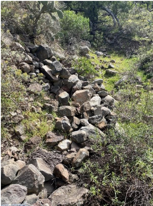
Figura V.1. Derrumbes al Sur del municipio.
