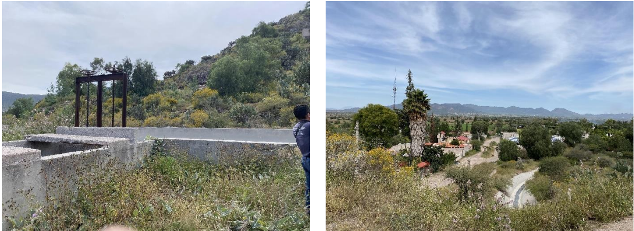
Figura V.7. Compuerta de salida del canal y canal de salida a las áreas de cultivo.
