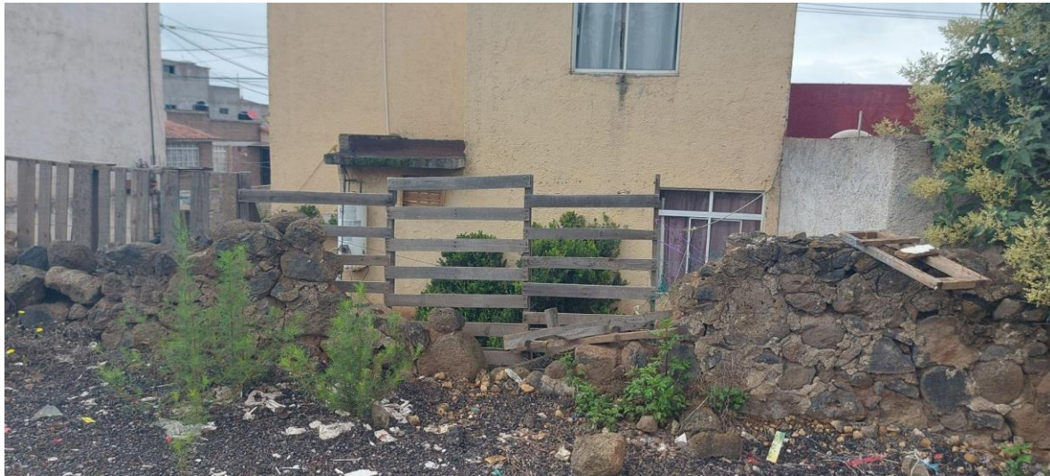
Figura 23. Evidencia de la afectación a la infraestructura a causa de fuertes lluvias en la localidad de Unidades Habitacionales
