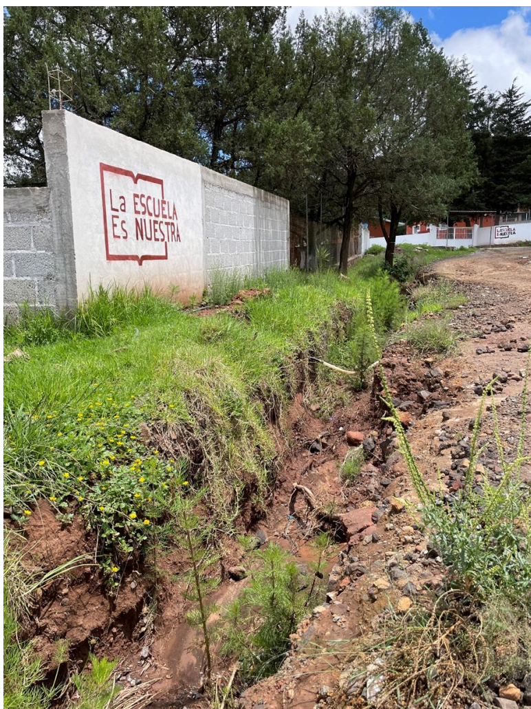
Figura 21. Evidencia de erosión hídrica en la localidad de Altepemila
