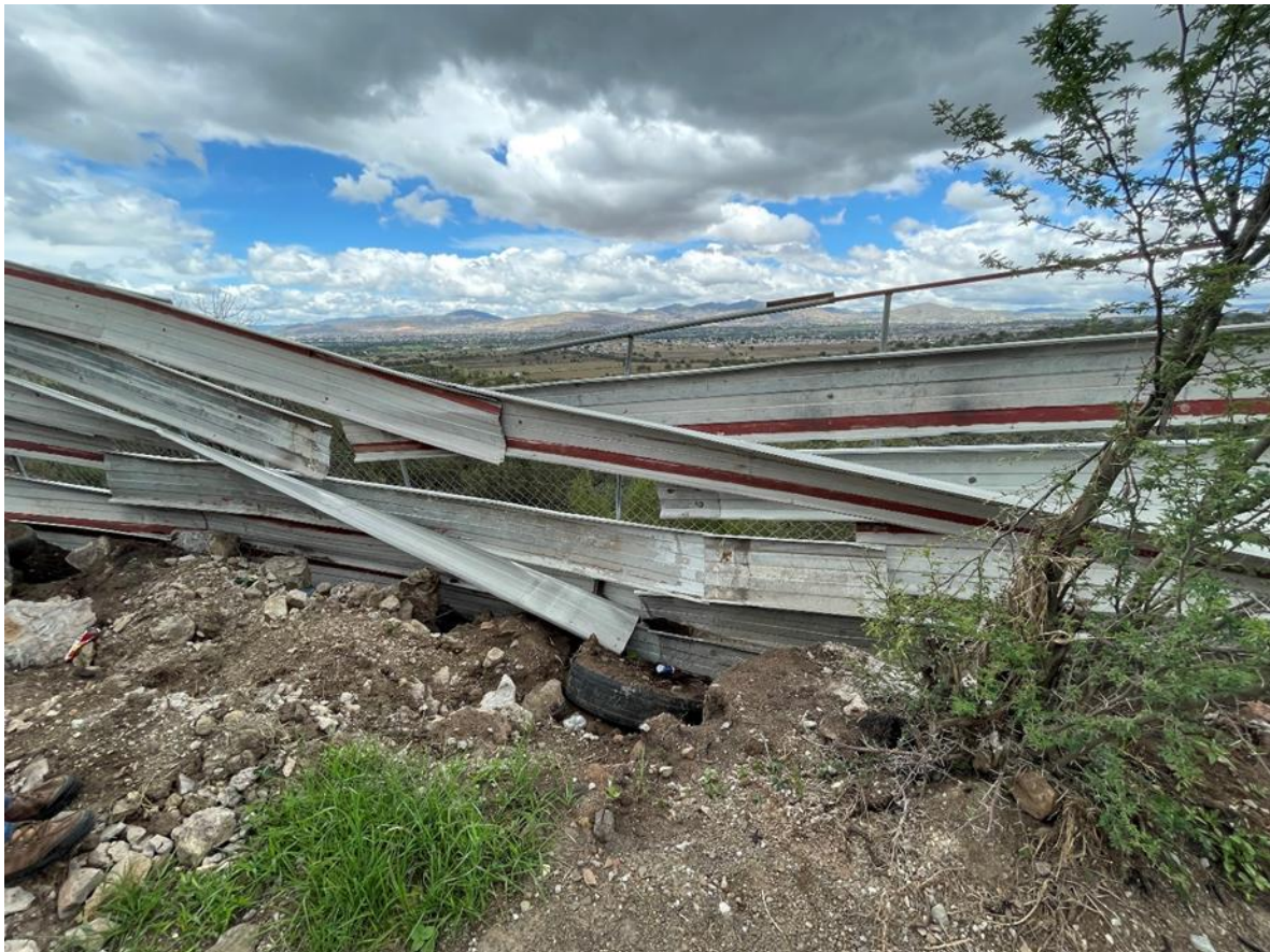
Figura 13. Deslizamiento producto de escorrentías de agua, afectando la infraestructura de la localidad Rancho El Mirador
