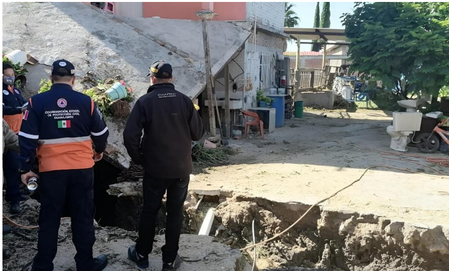
Figura 37. Afectación estructural a vivienda expuesta a agrietamientos y hundimientos diferenciales en el Estado de Guanajuato. Fuente: Gobierno del Estado de Guanajuato.
