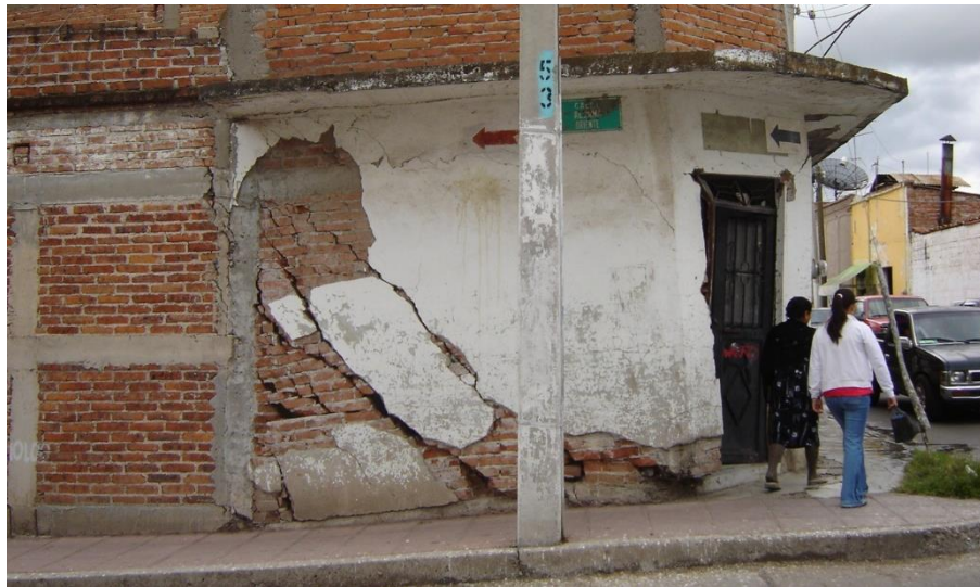
Figura 38. Vivienda expuesta a agrietamiento y subsidencia diferencial en el Estado de Guanajuato. Fuente: Gobierno del Estado de Guanajuato.
