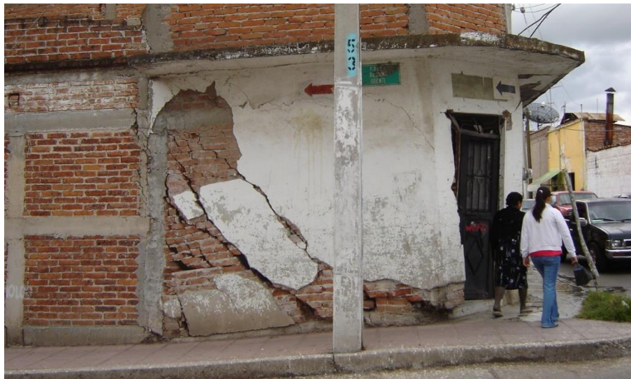
Figura 37. Vivienda expuesta a agrietamiento y subsidencia diferencial en el Estado de Guanajuato. Fuente: Gobierno del Estado de Guanajuato.
