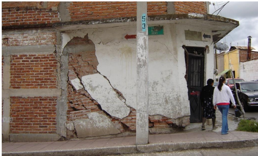
Figura 36. Vivienda expuesta a agrietamiento y subsidencia diferencial en el Estado de Guanajuato. Fuente: Gobierno del Estado de Guanajuato.
