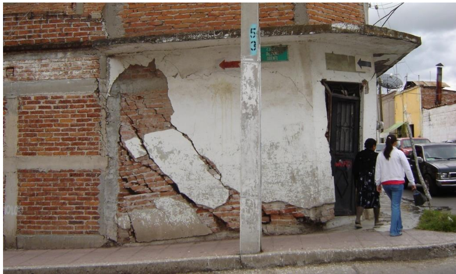
Figura 37. Vivienda expuesta a agrietamiento y subsidencia diferencial en el Estado de Guanajuato. Fuente: Gobierno del Estado de Guanajuato.
