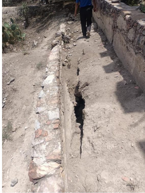
Figura 62. Agrietamiento del terreno el municipio de San Luis de la Paz. Fuente: CEPC 2023.
